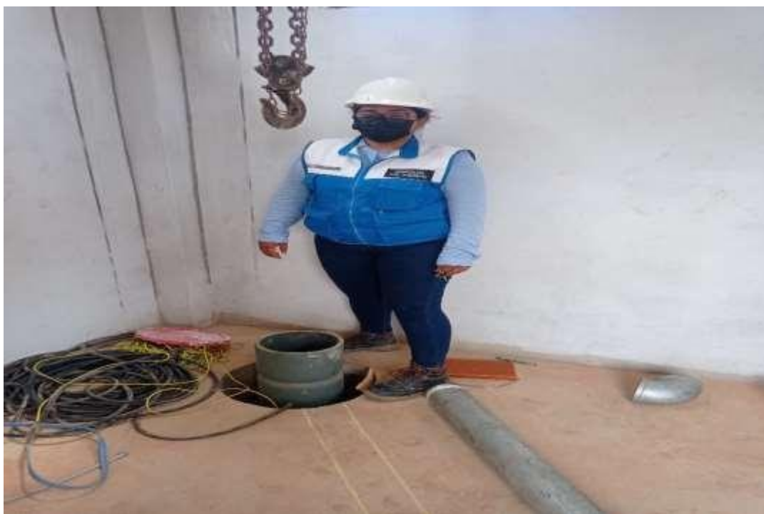
Imagen 02: Tubería de la línea de conducción
