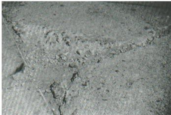
Figura 20: Descascaramiento de esquina de alta severidad.
