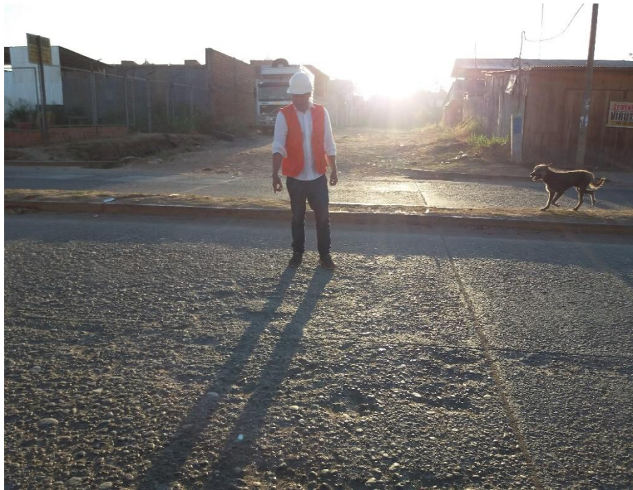
Figura 55: Punzonamiento, descascaramiento, daño de sello de junta, grieta de esquina, pulimentos de agregados en la cuadra 03 de la avenida Habilitación Urbana Municipal (2017)
