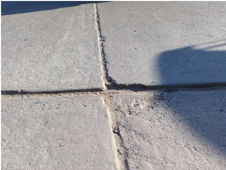
Figura 58: Descascamiento, daño de sello de junta, grieta de es quina en la cuadra 04 de la avenida Habilitación Urbana Municipal (2017)
