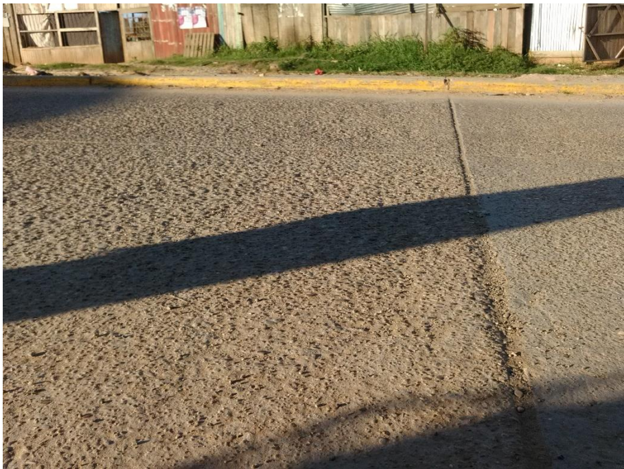
Figura 50: Pulimentos de agregados cuadra 01 de la avenida Habilitación Urbana Municipal (2017)
