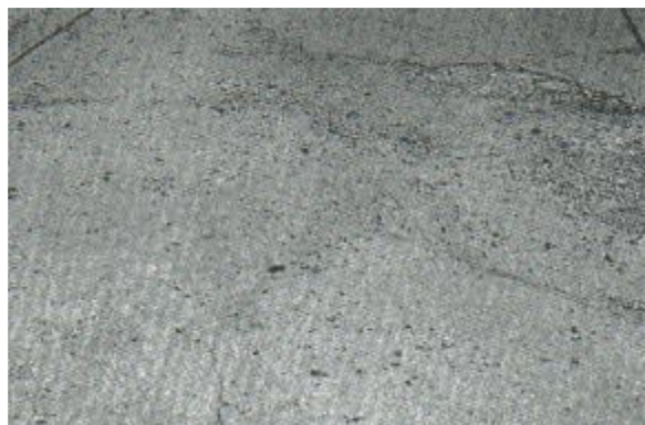
Figura 06: Grieta de durabilidad de alta severidad.
