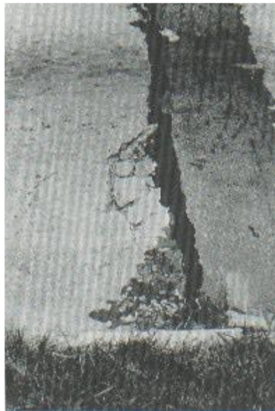
Figura 4: Blowup / Buckling de baja severidad
