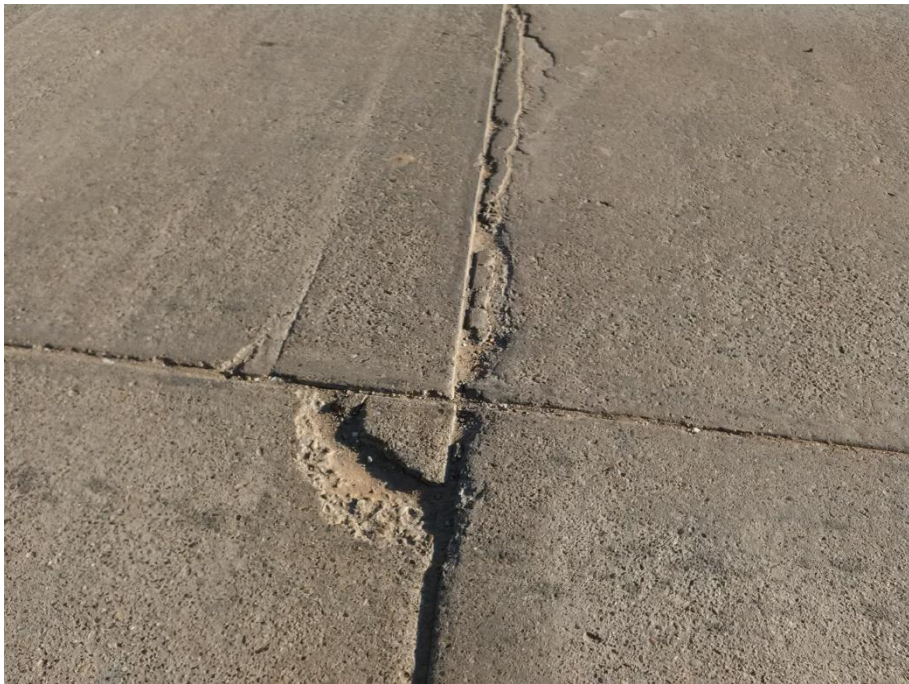
Figura 60: Punzonamiento, descascaramiento, daño de sello de junta, grieta de esquina, pulimentos de agregados en la cuadra 04 de la avenida Habilitación Urbana Municipal (2017)
