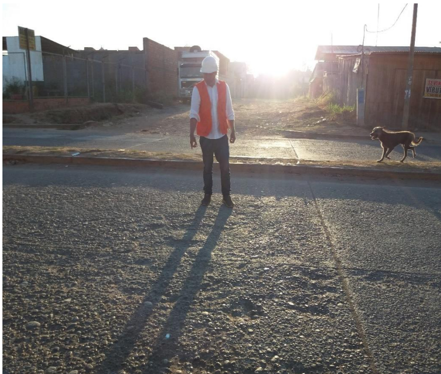
Figura 53: Punzonamiento, descascaramiento, pulimentos de agregados en la cuadra 02 de la avenida Habilitación Urbana Municipal (2017)
