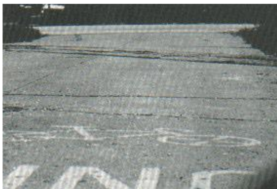
Figura 17: Cruce de vía férrea de severidad media.
