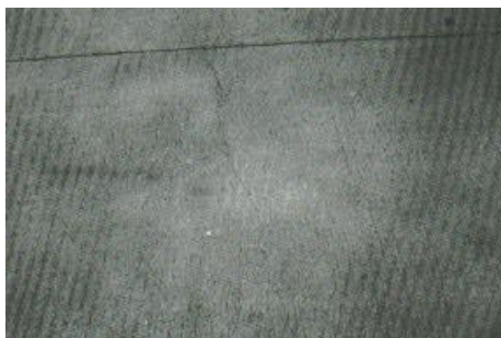
Figura 19: Grietas de contracción.
