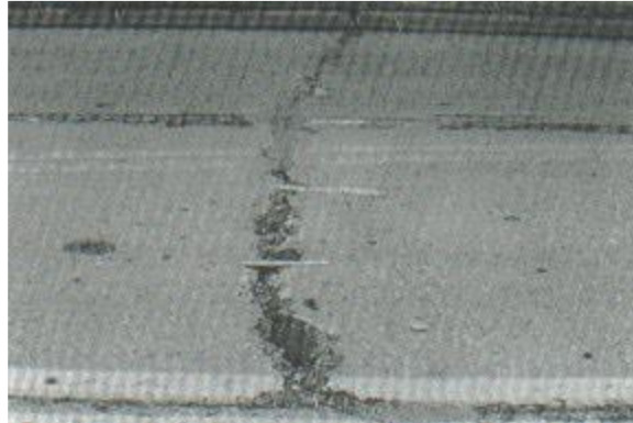
Figura 10: Grietas lineales de alta severidad en losa de concreto simple.
