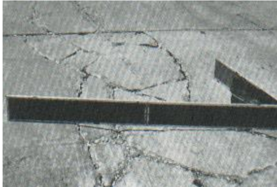
Figura 16: Punzonamiento de alta severidad.
