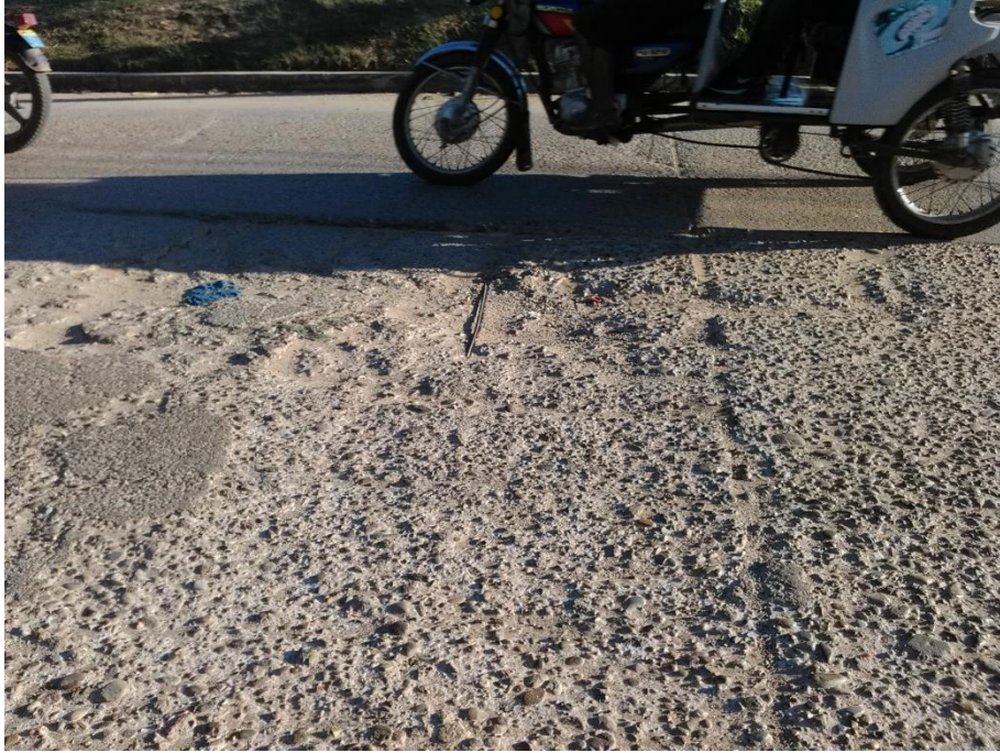
Figura 57: Punzonamiento, descascamiento, daño de sello de junta, grieta de esquina, pulimentos de agregados en la cuadra 04 de la avenida Habilitación Urbana Municipal (2017)
