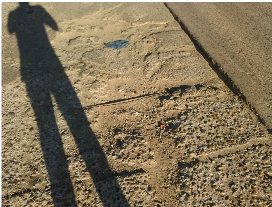
Figura 56: Punzonamiento, descascaramiento, daño de sello de junta, grieta de esquina, pulimentos de agregados en la cuadra 03 de la avenida Habilitación Urbana Municipal (2017)
