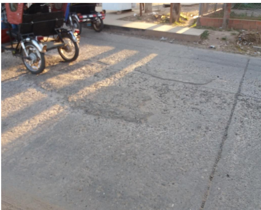
Figura 54: Punzonamiento, descascaramiento, pulimentos de agregados en la cuadra 03 de la avenida Habilitación Urbana Municipal (2017)
