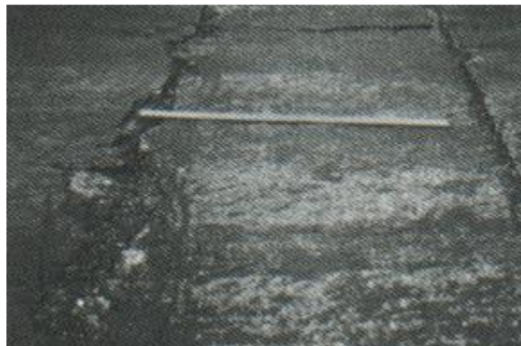
Figura 11: Parche grande y acometidas de servicios públicos de alta severidad.
