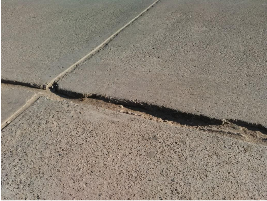
Figura 59: Escala, descascaramiento, daño de sello de junta, pulimentos de agregados en la cuadra 04 de la avenida Habilitación Urbana Municipal (2017)
