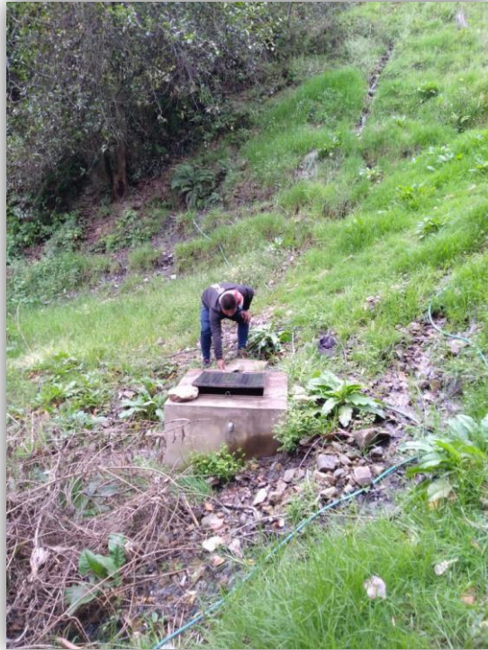
Imagen 01: cámara rompe presión
