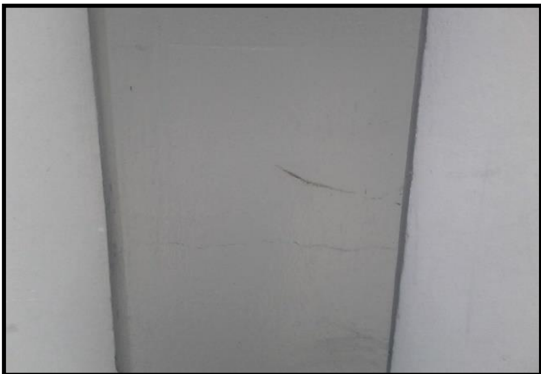
Foto 10: fisura y abrasion en el tramo IV
