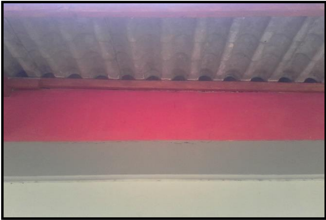
Foto 07: Fisura en la viga en el tramo II
