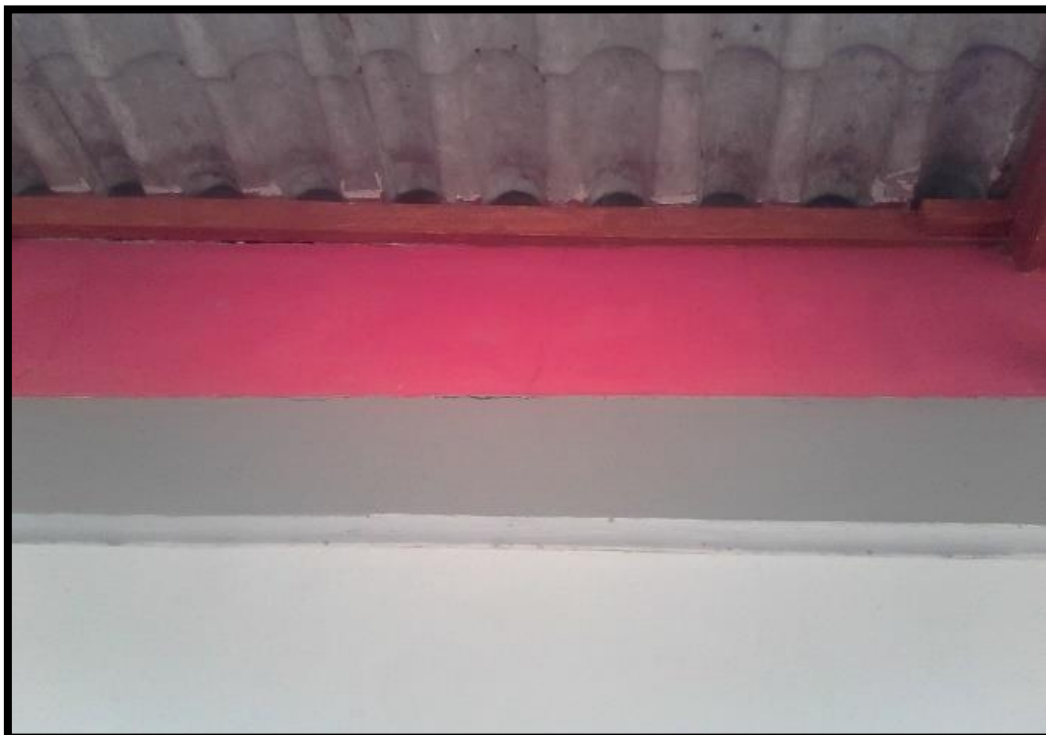
Foto 06: Firura en la viga en el tramo I
