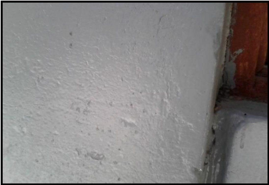
Foto 02: Escamado en la columna en el tramo II
