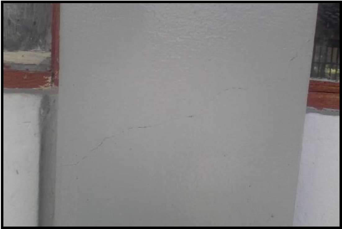
Foto 01: Fisura en Columna en el tramo I
