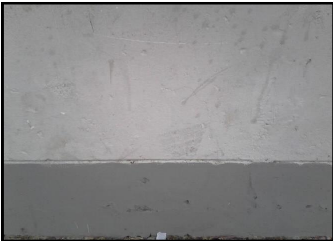
Foto 08: Abrasion en el tramo III
