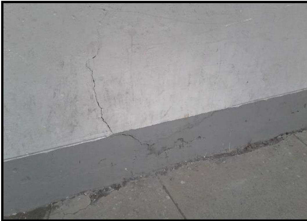
Foto 05: Grieta en el muro en el tramo IV
