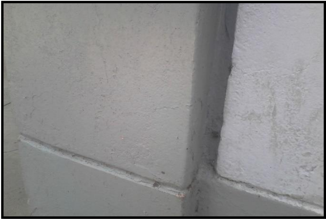
Foto 09: Abrasion en columnas en el tramo III
