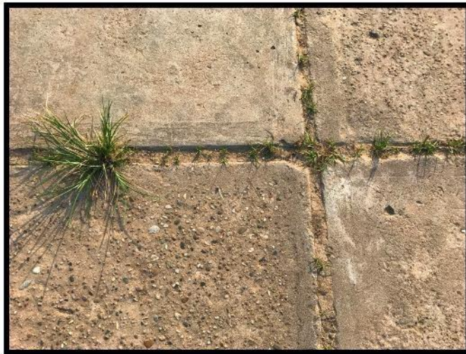
Daño de sello de junta
