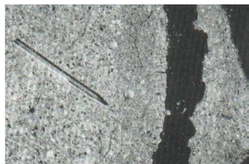
Daño del daño de junta
