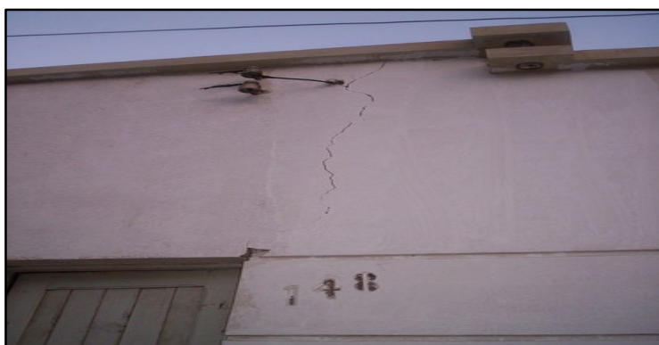
FIGURA 10: Imagen de fisuras
