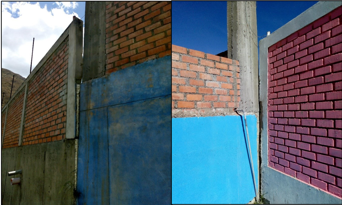
FOTOGRAFIA 5: Muestra M15, nótese la separación y asentamiento del muro con respecto al otro.
