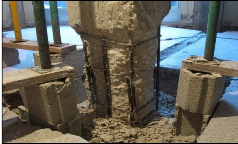
FIGURA 12: Imagen de corrosión
