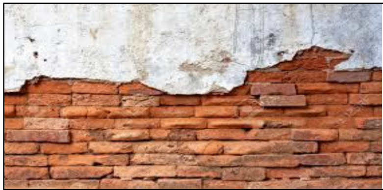
FIGURA 8: Imagen de erosión
