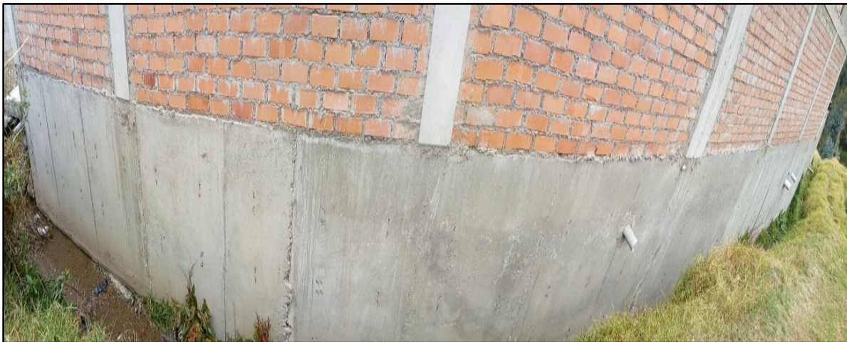
FOTOGRAFIA 6: Muro de contención sin juntas de construcción donde se ubican las muestras
