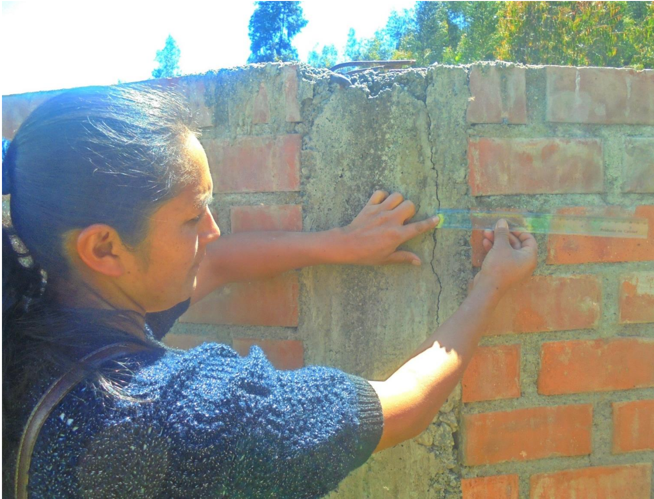
Imagen 33: Fisura en columna.
