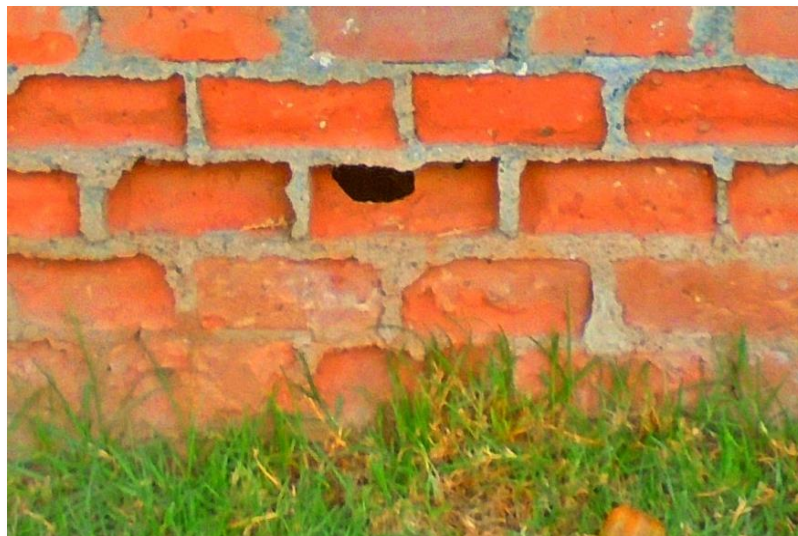
Imagen 16: Erosión Física en muro de albañilería.
