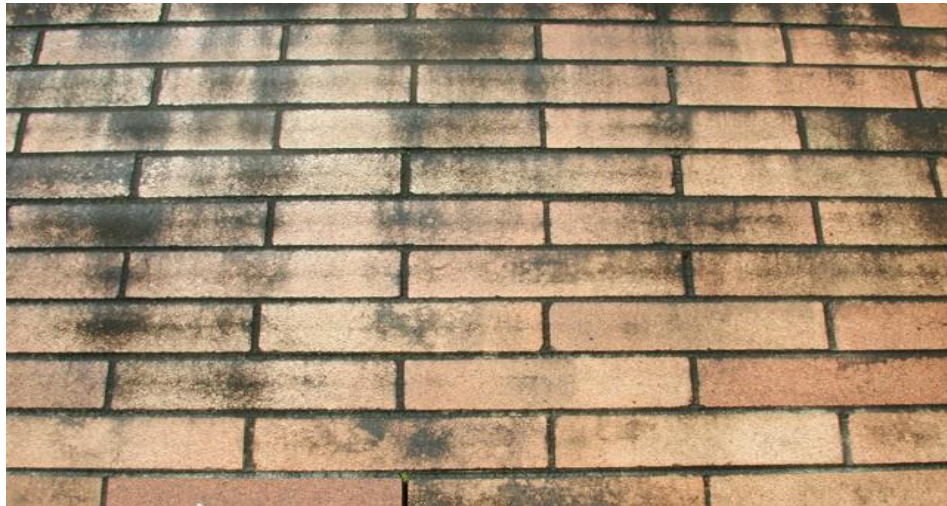
Imagen 21: Moho en muro de albañilería.
