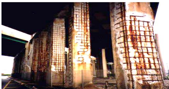
Imagen 25: Varillas de acero afectadas por Corrosión en columna.
