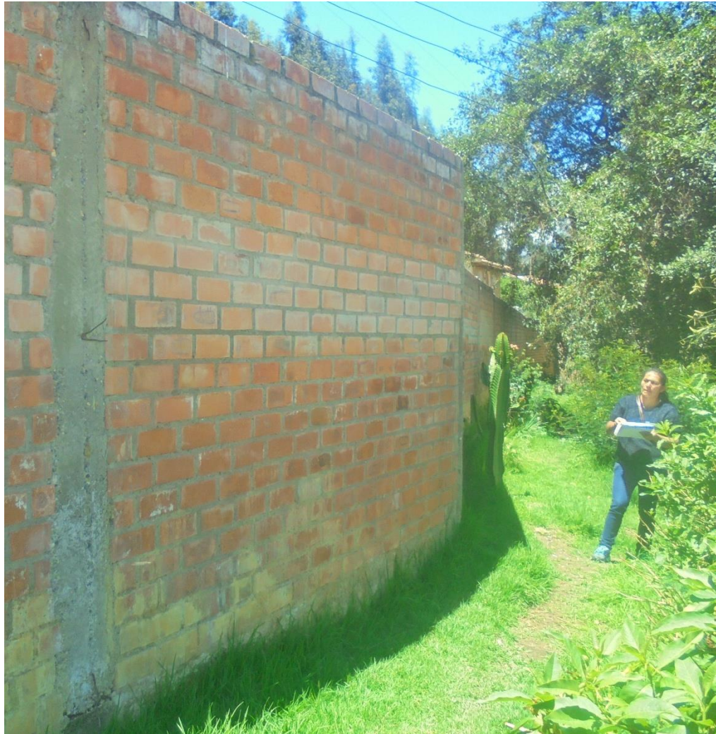
Imagen 29: Erosión en muro.
