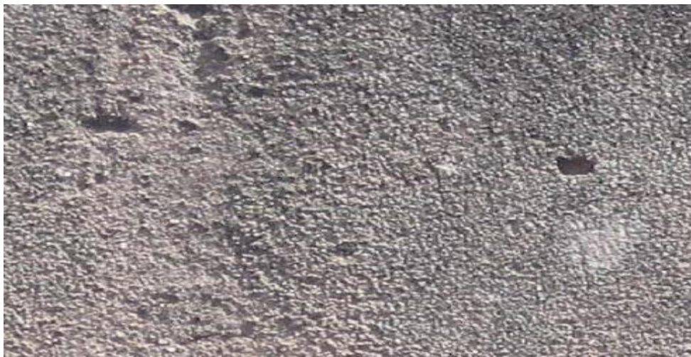
Imagen 17: Picaduras en el concreto.
