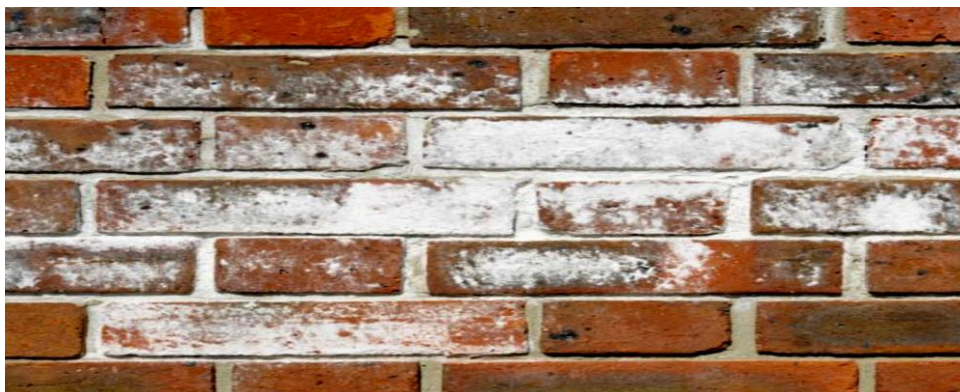
Imagen 23: Eflorescencia en muro de albañilería.
