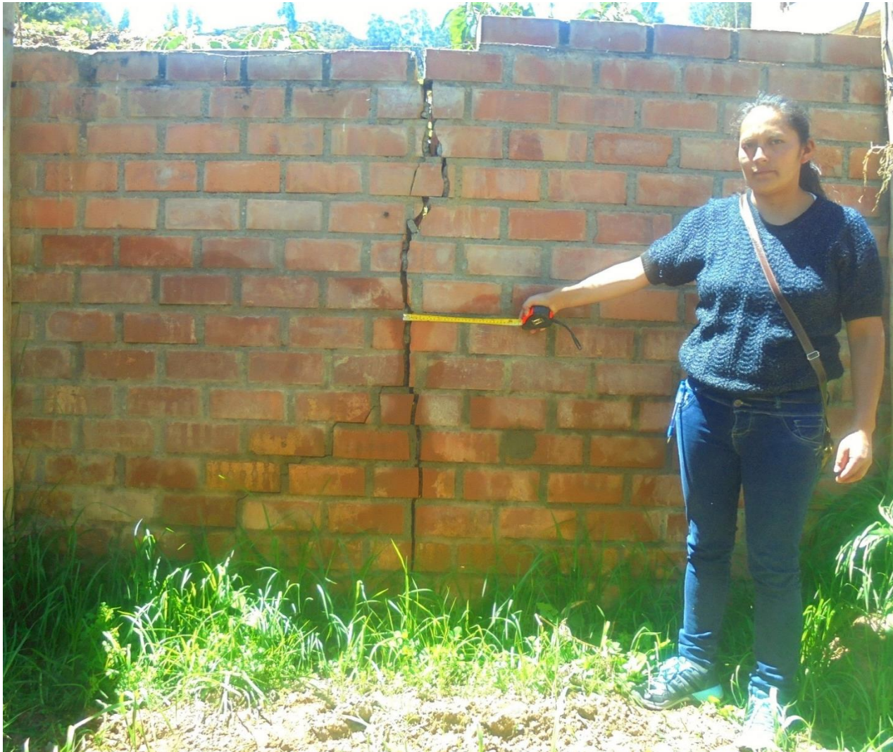
Imagen 34: Grieta en muro.
