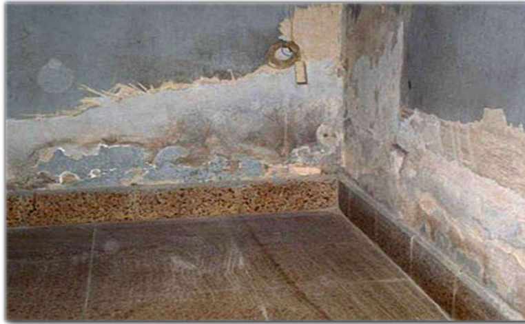
Imagen 22 – Humedad en los muros de vivienda.
