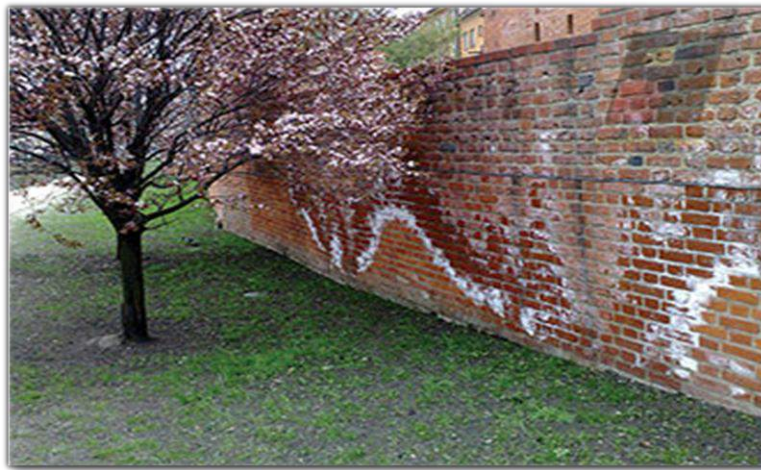
Imagen 23 – Eflorescencia en los muros de albañilería.
