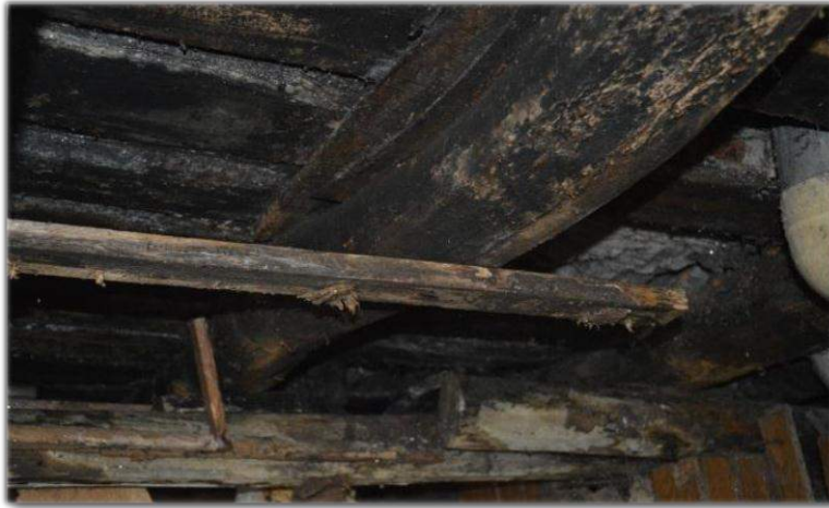
Imagen 5 – Deformación de la viga de madera.
