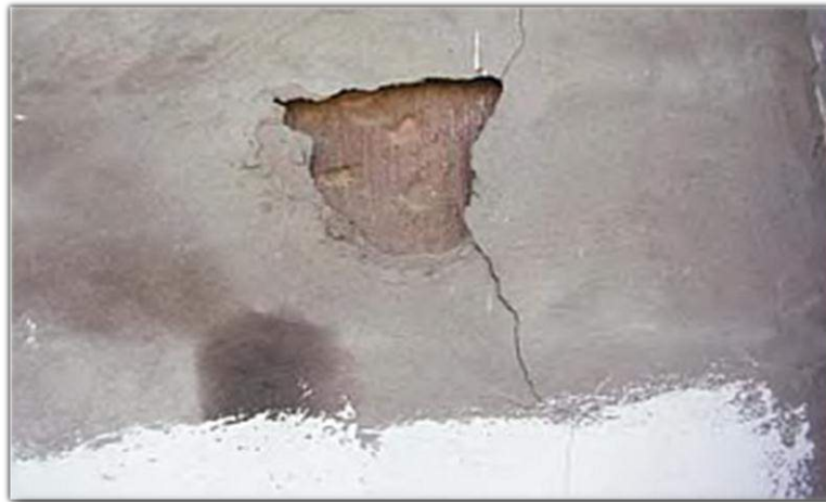
Imagen 4 – Desprendimiento del revoque en el muro.
