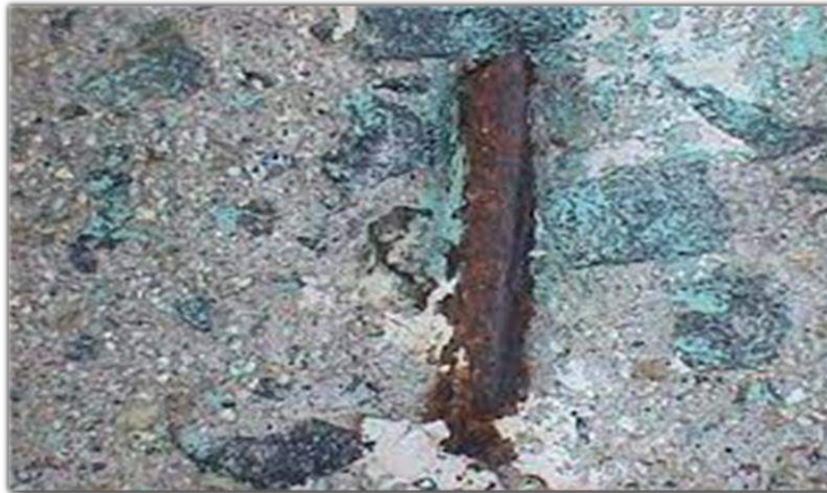
Imagen 20 – Desagregación del concreto.
