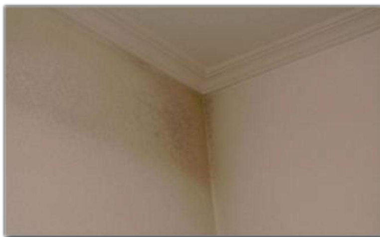
Imagen 3 – Humedad por condensación en vivienda.
