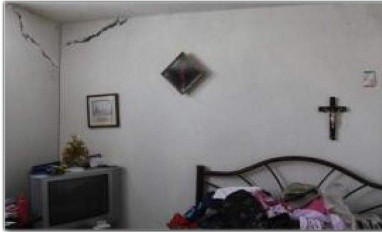
Imagen 8 – Grietas en las esquinas superiores de los muros de viviendas.
