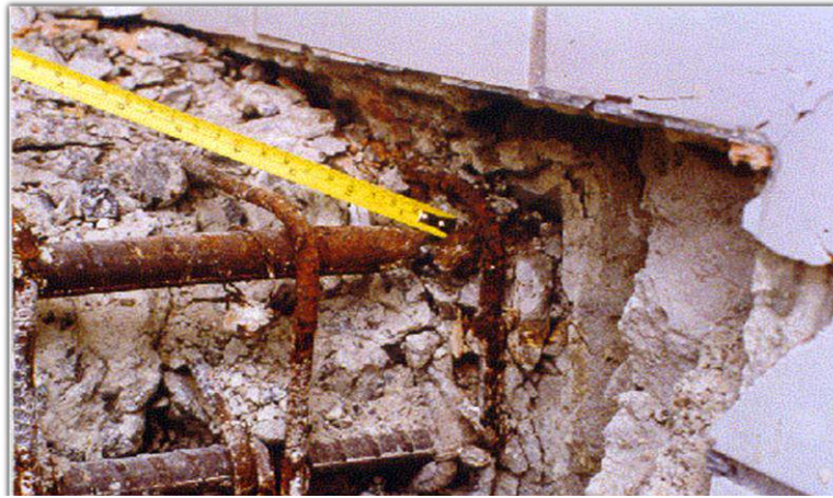
Imagen 24 – Corrosión del acero en elementos de concreto armado.
