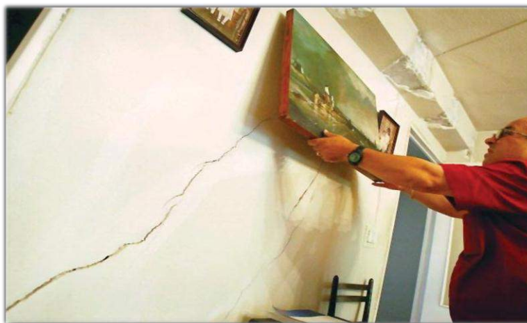
Imagen 18 – Fisuras en los muros de vivienda.
