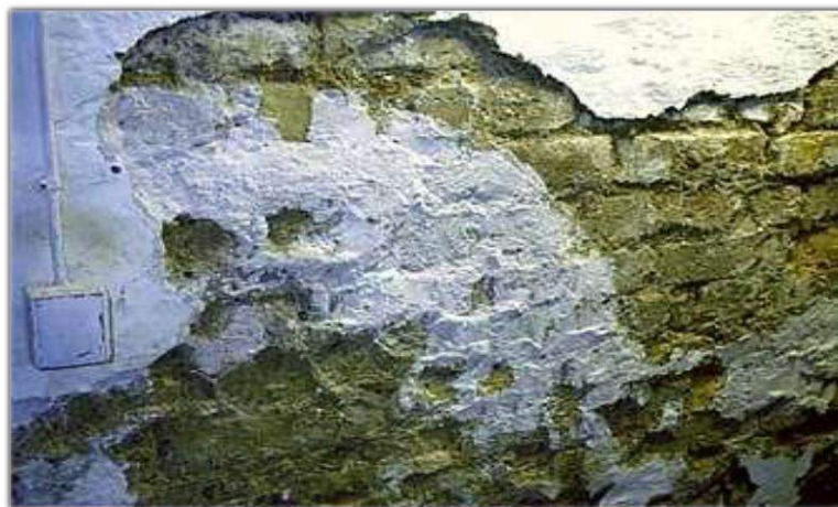
Imagen 6 – Criptoflorescencia en el muro de albañilería.
