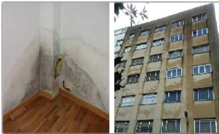
Imagen 27 – Patologías por acciones físicas.
