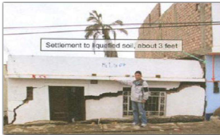
Imagen 7 – Asentamiento diferencial del suelo.
