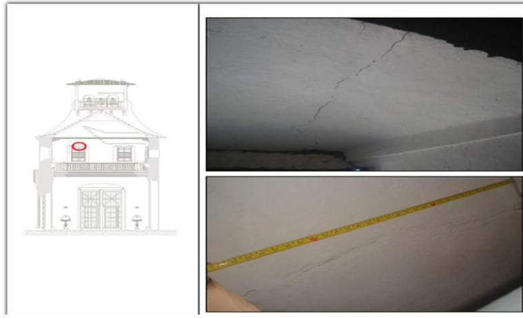
Imagen 2 – Patologías en la cubierta y artesonado de la iglesia.
