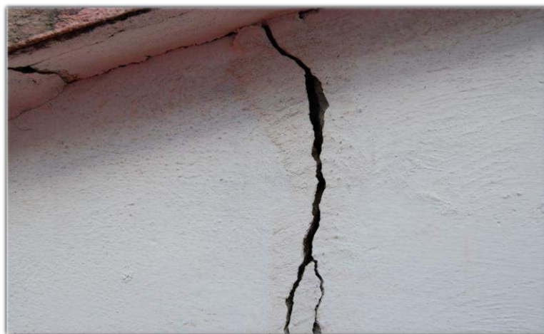
Imagen 19 - Grieta en muros de albañilería.
