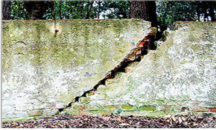
Imagen 28 – Patología por acciones mecánicas.
