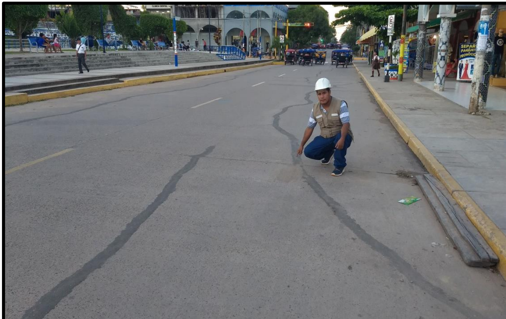
Figura 0-18; Grieta Lineal severidad Media
