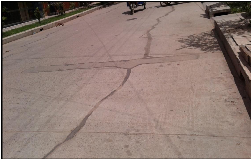
Figura 0-7; Parche Grande severidad media
