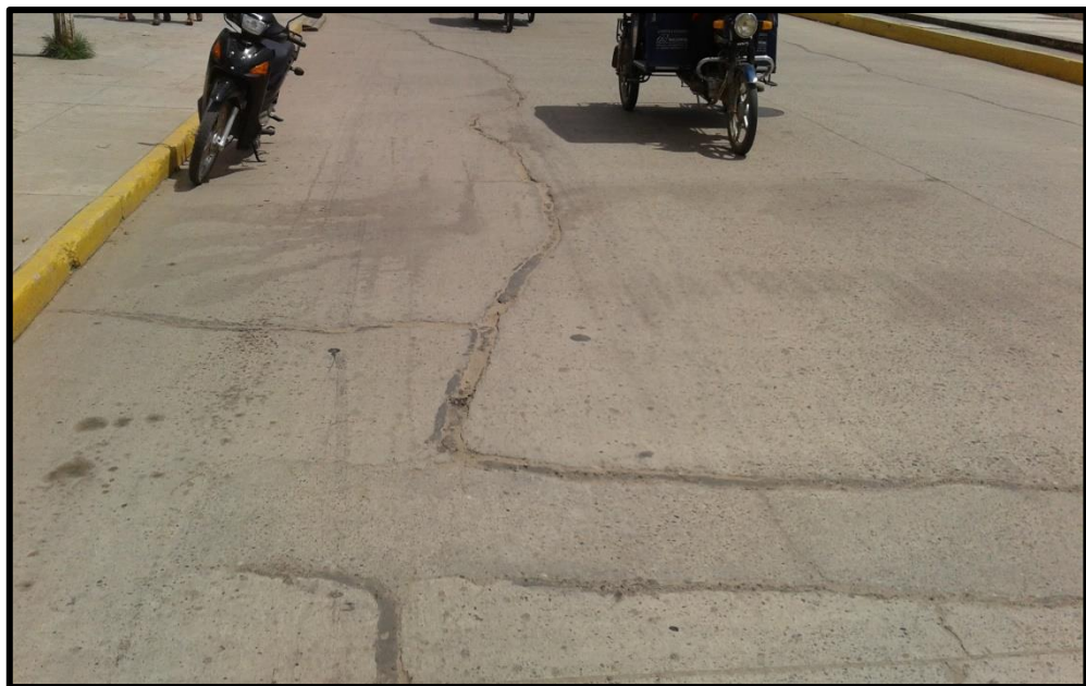
Figura 0-21; Losa Dividida severidad Alta
