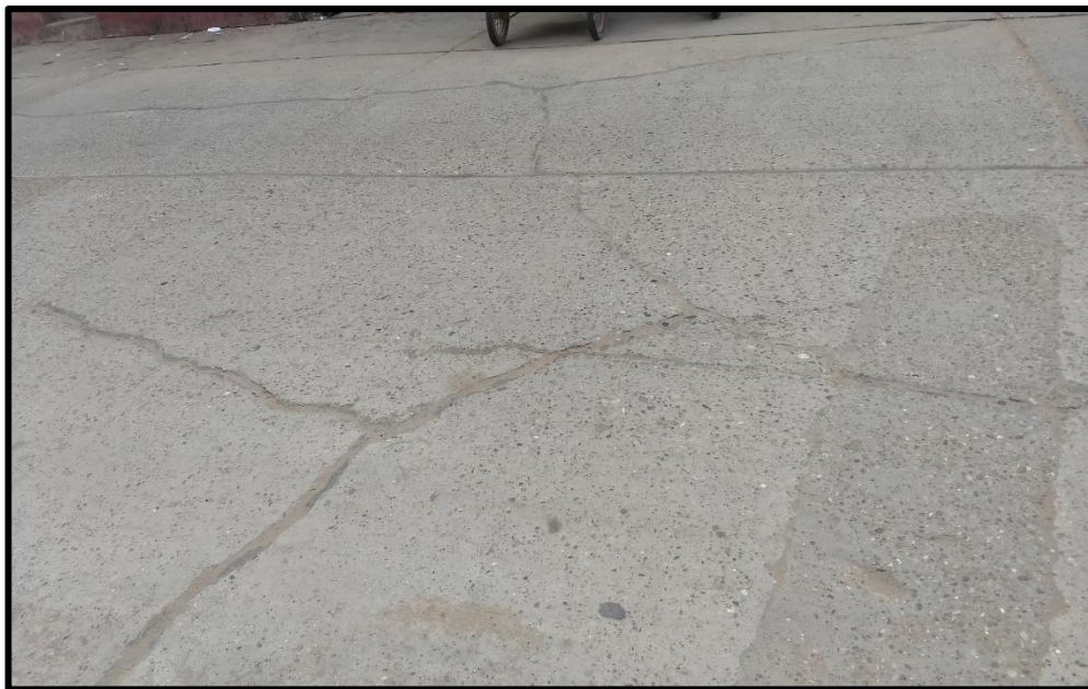
Figura 0-25; Losa Dividida severidad Alta
