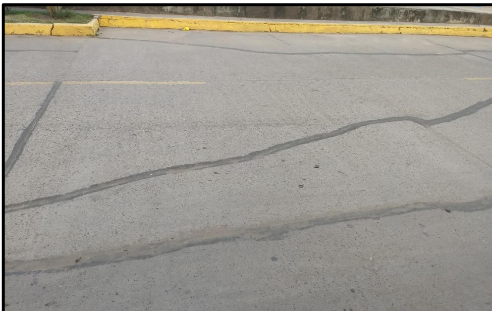
Figura 0-19; Grieta Lineal severidad Alta
