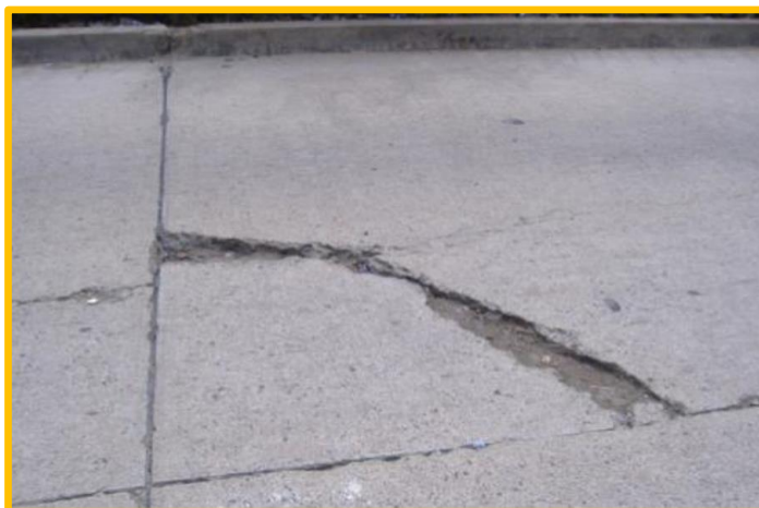
Figura II-30; Descascamiento de esquina
