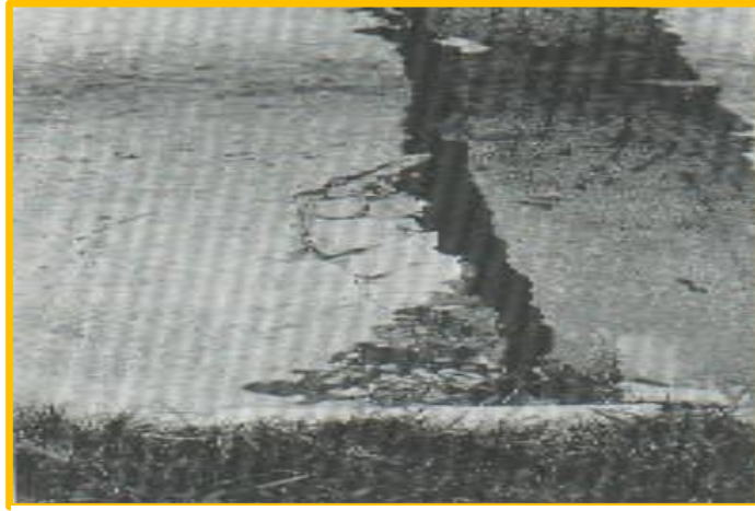
Figura II-13; Falla por Blowup – Buckling
