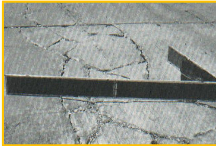
Figura II-26; Falla por Punzonamiento
