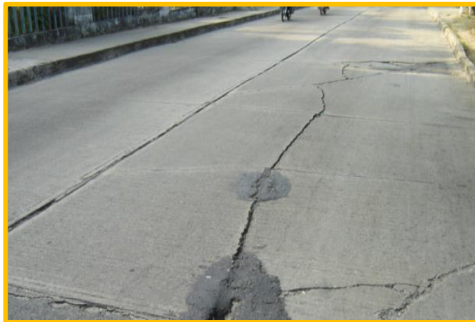
Figura II-20; Falla por Grieta Lineal
