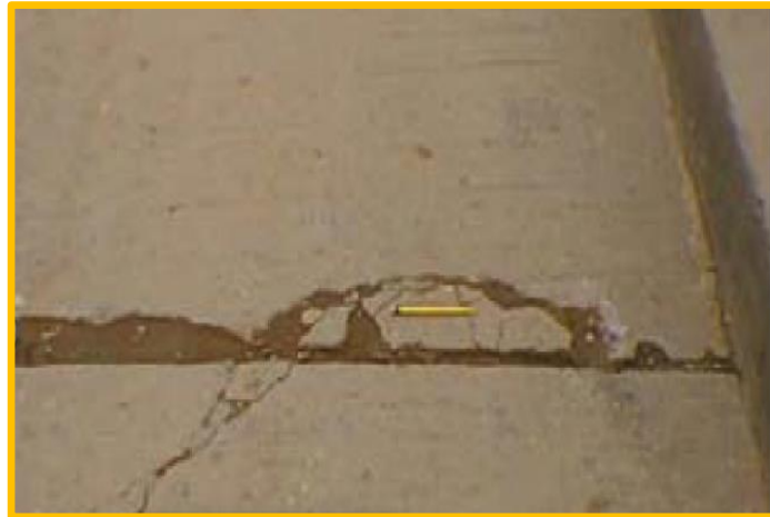
Figura II-31; Descascaramiento de Junta
