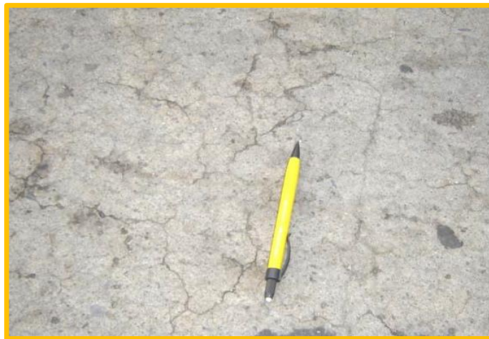
Figura II-29; Grieta por Retracción
