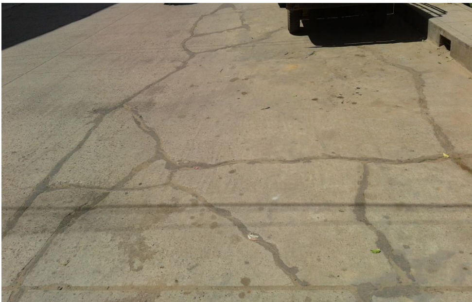
Figura 0-17; Losa Dividida severidad Alta
