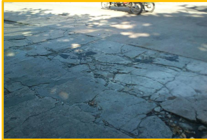
Figura II-28; Desconchamiento, mapa de grietas, craquelado
