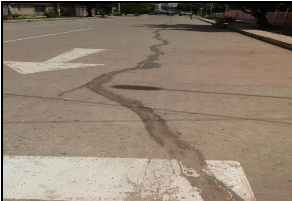
Figura 0-11; Grieta Lineal severidad Alta
