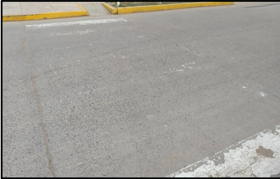
Figura 0-12; Pulimento de Agregado severidad Media
