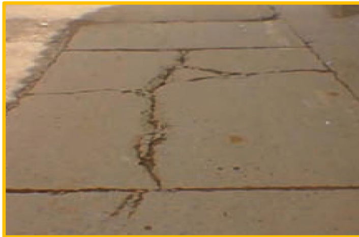
Figura II-15; falla losa Dividida
