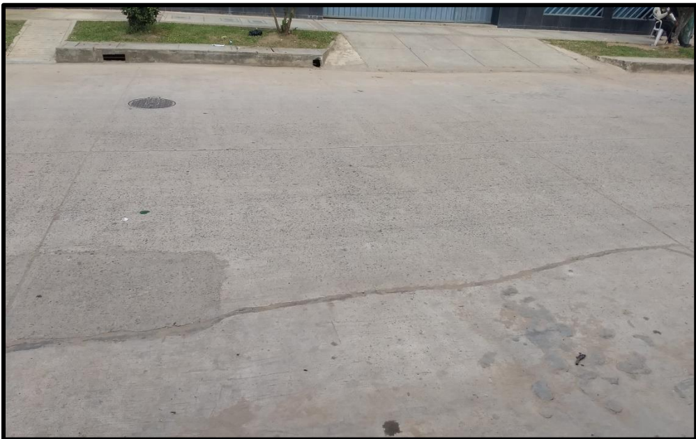
Figura 0-15; Grieta Lineal severidad Baja
