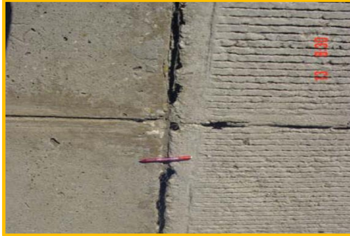
Figura II-18; Daño del sello de la Junta
