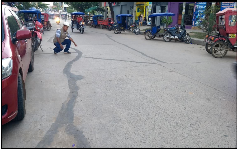
Figura 0-14; Grieta Lineal Severidad Alta
