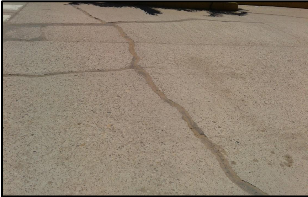
Figura 0-26; Grieta Lineal severidad Media
