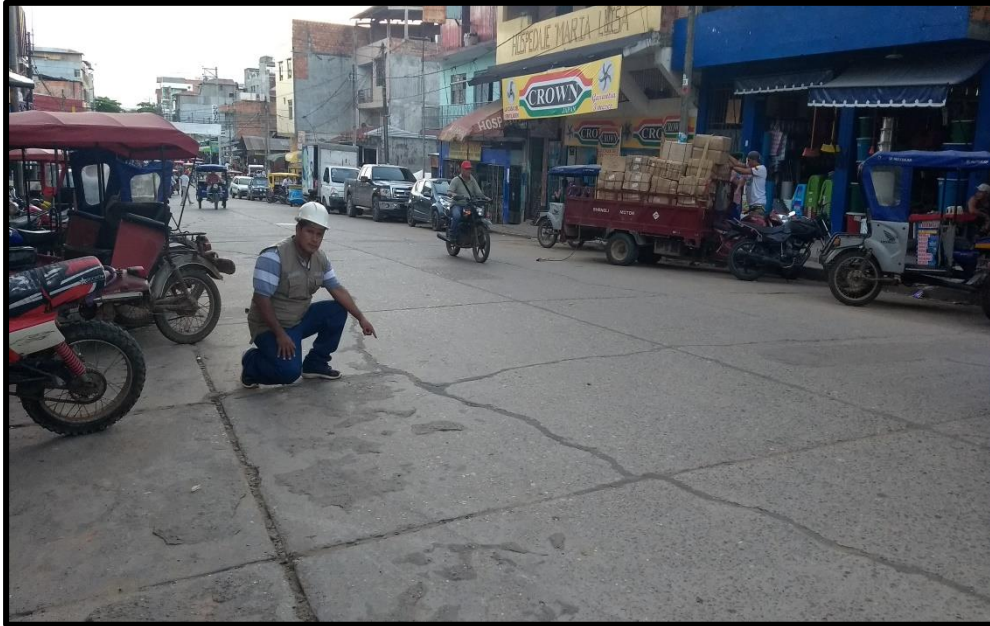
Figura 0-24; Losa Dividida severidad Media
