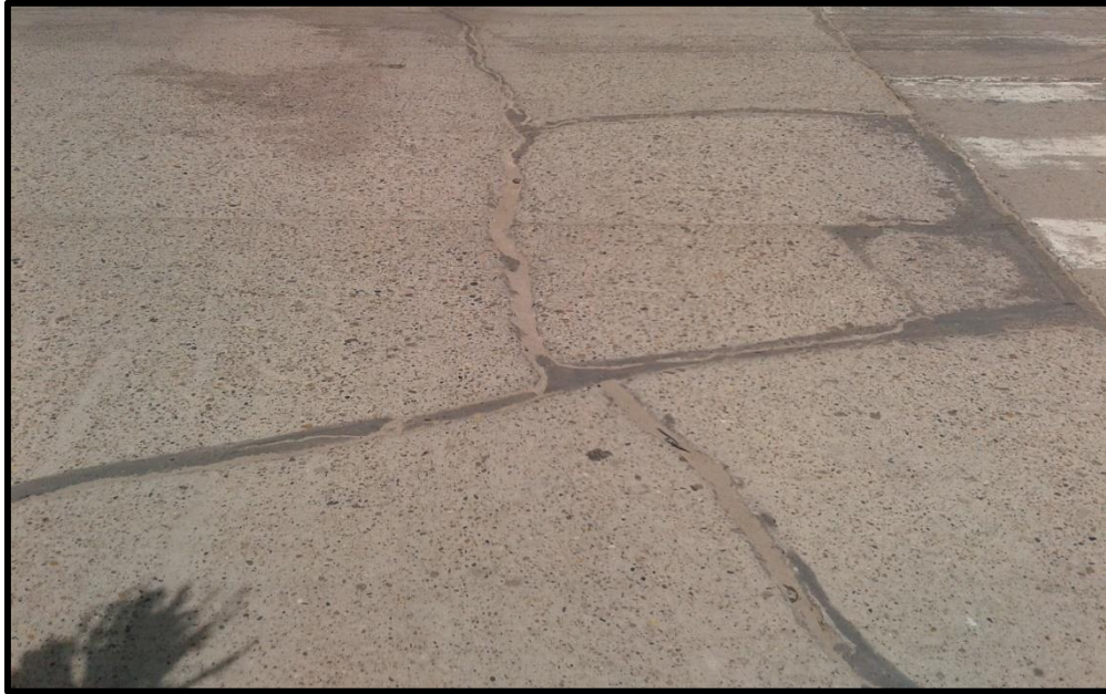
Figura 0-20; Losa Dividida severidad Media
