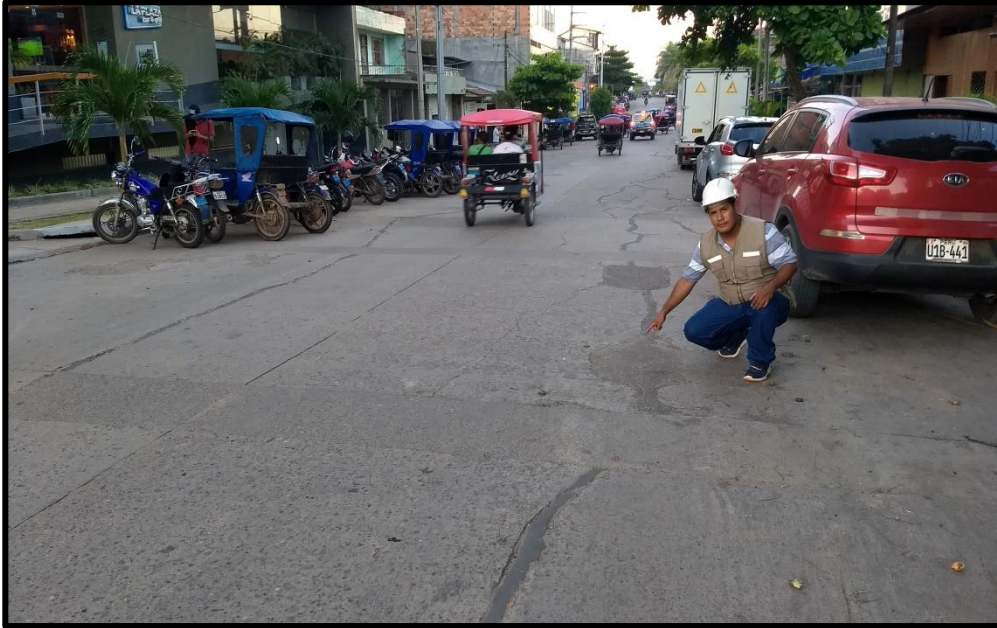
Figura 0-6; Falla por Punzonamiento severidad baja
