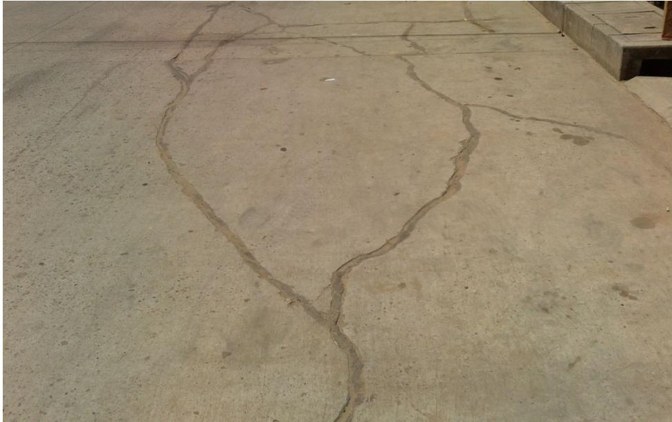
Figura 0-16; Losa Dividida severidad Media
