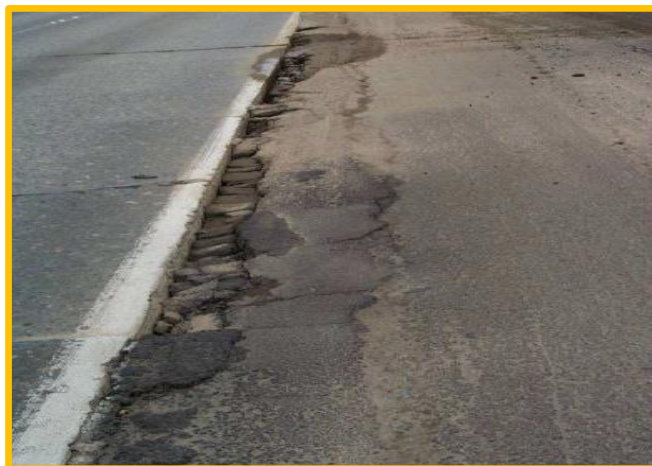
Figura II-25; Falla por Bombeo
