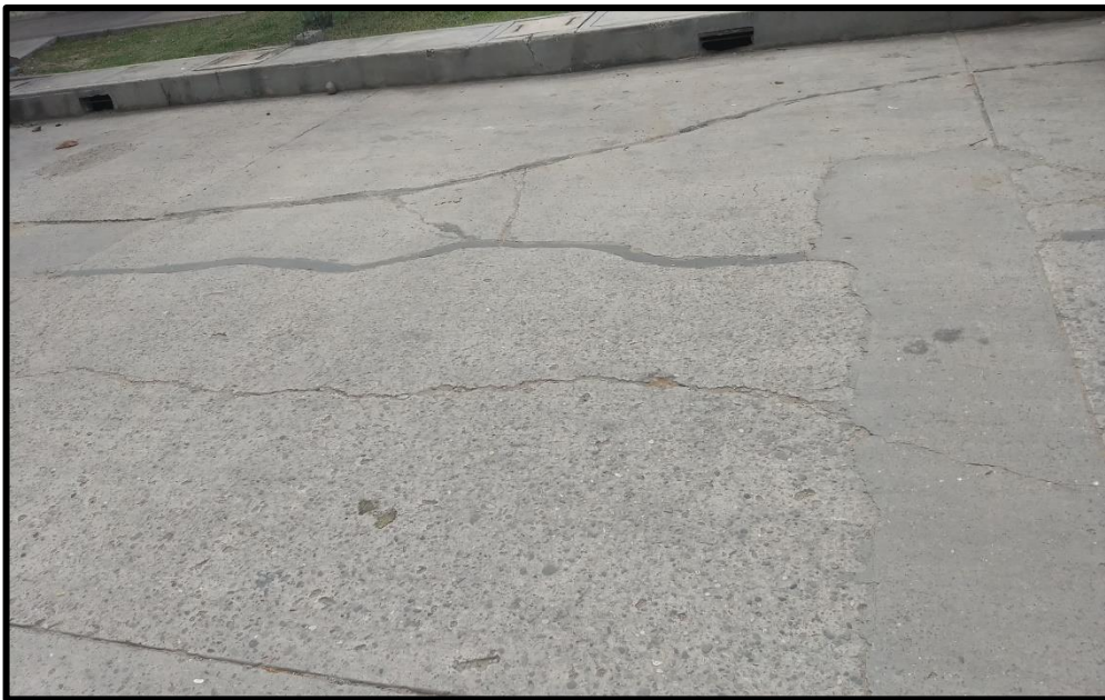
Figura 0-9; Losa Dividida Severidad media
