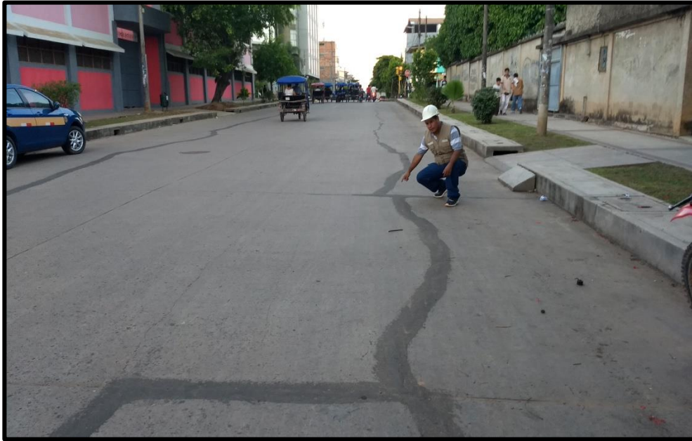
Figura 0-10; Grieta Lineal severidad media
