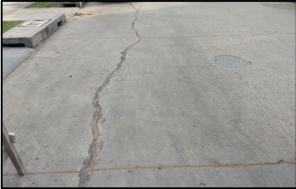
Figura 0-8; Grieta Lineal severidad Alta
