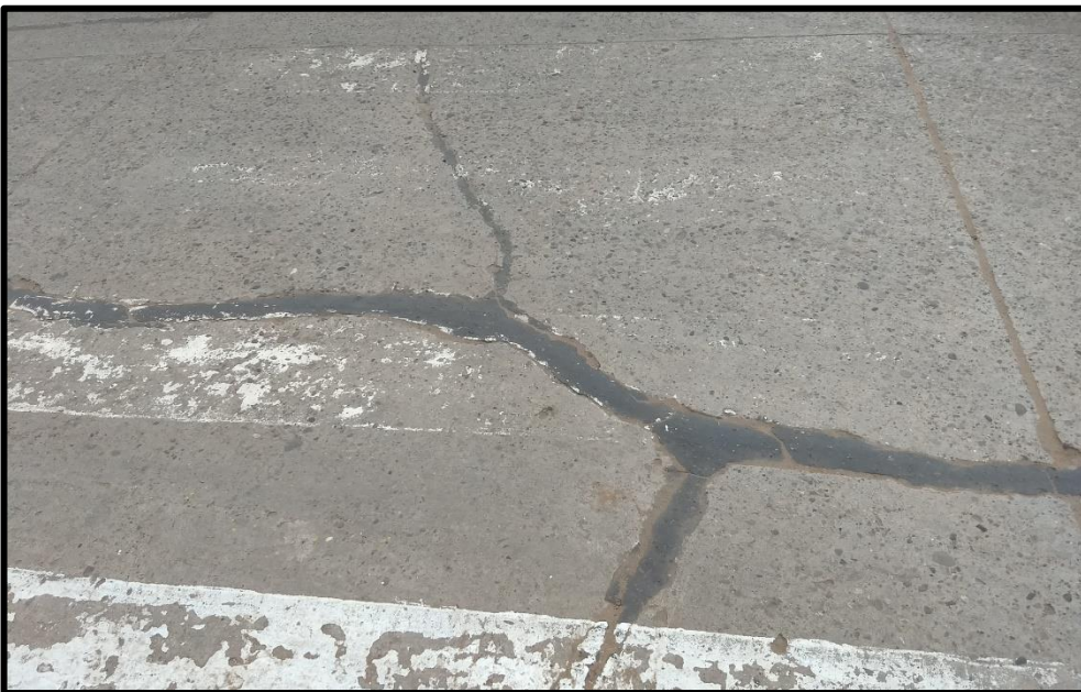
Figura 0-13; Losa Dividida severidad Media
