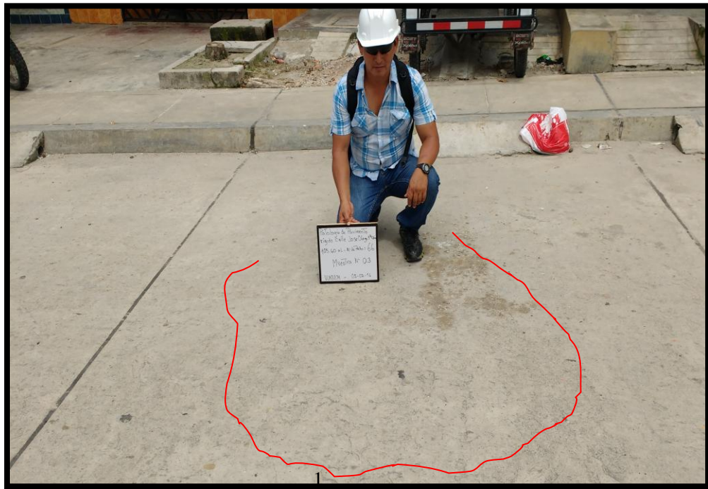
Figura 135: foto de grieta lineal de baja severidad
