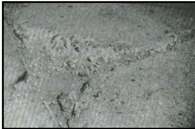
Figura 18: Descascaramiento de Esquina.
