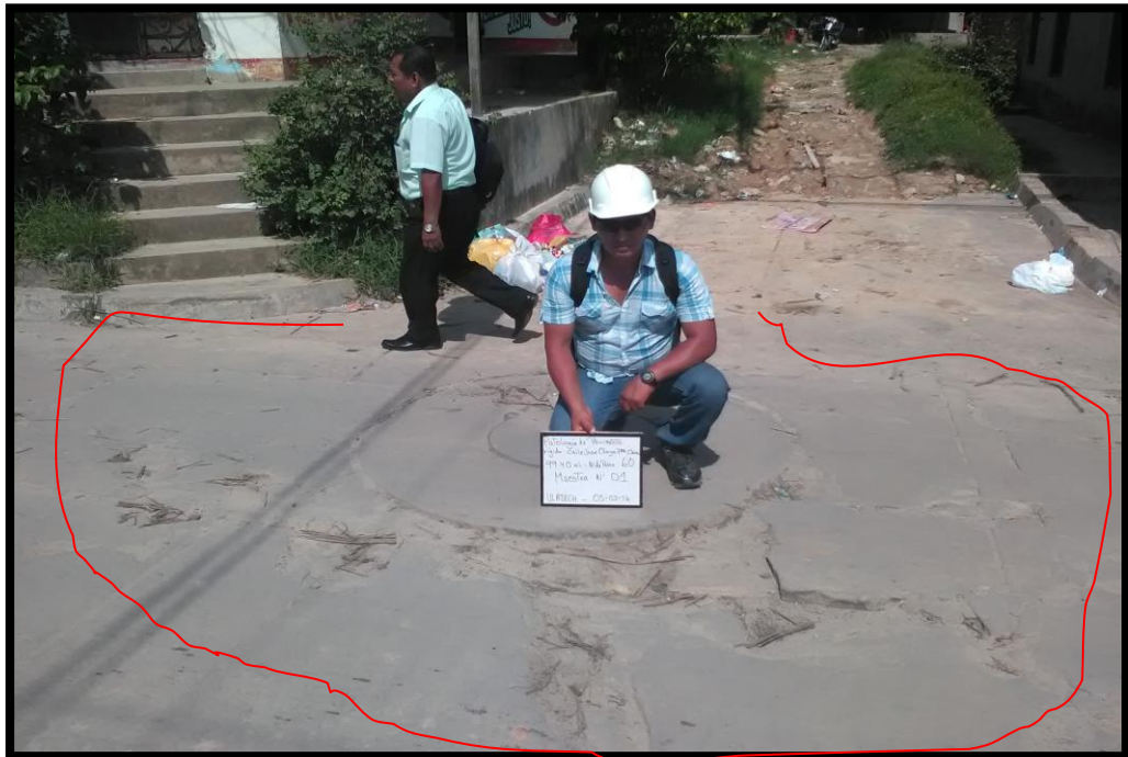
Figura 142: foto de punzonamiento de severidad alta
