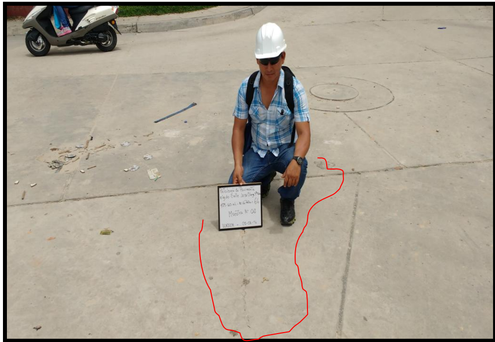
Figura 136: foto grieta lineal de severidad media
