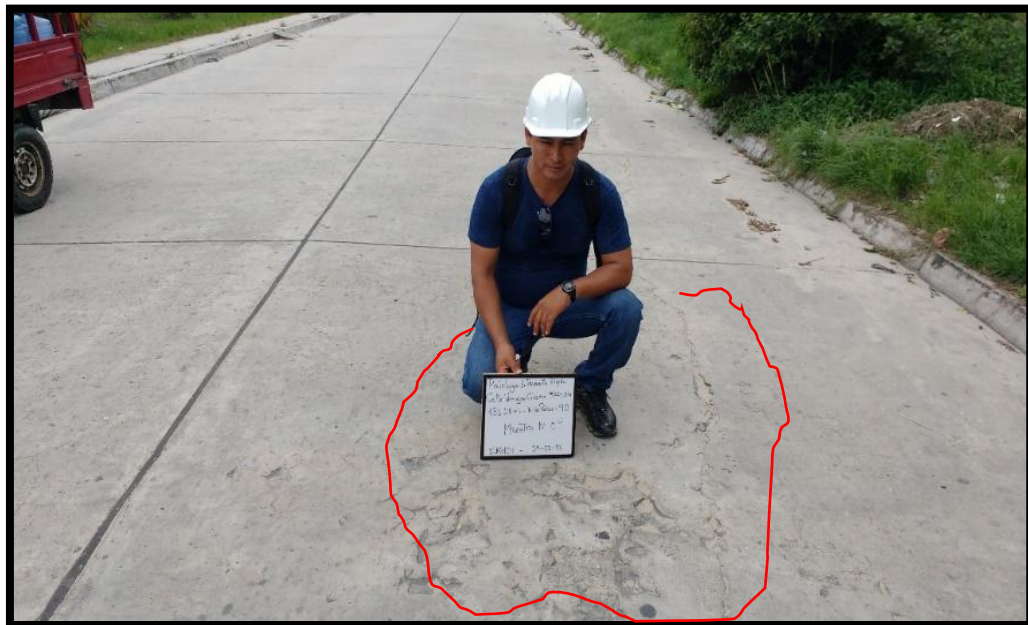
Figura 122: se observa punzonamiento de la losa severidad media
