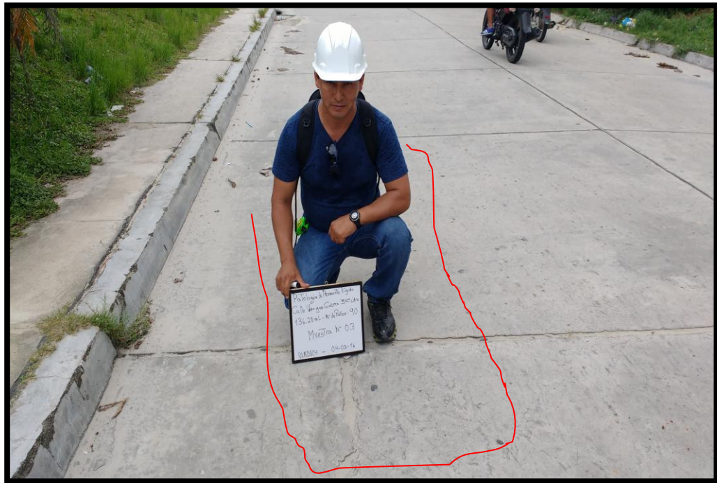
Figura 124: se observa grieta lineal de la losa mediana severidad
