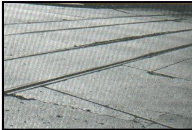
Figura 16: Falla por el Cruce de Vía Férrea.
