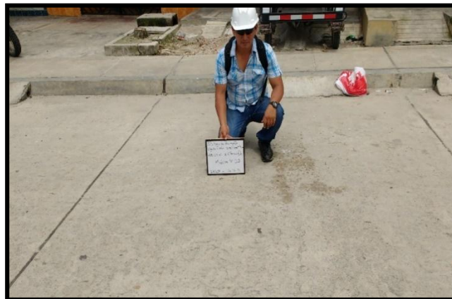
Figura 22: Grietas de Retracción.
