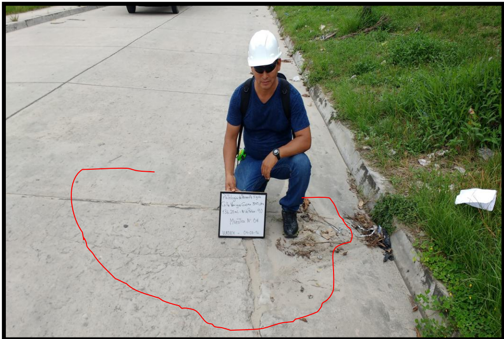
Figura 128: foto grieta lineal y punzonamiento de severidad media
