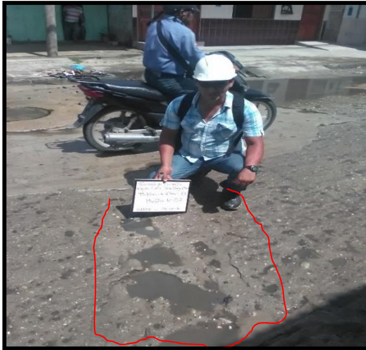
Figura 139: se observa grietas lineales severidad alta
