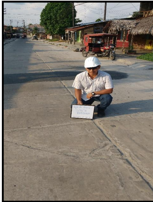
Figura 23: Grietas de Esquina
