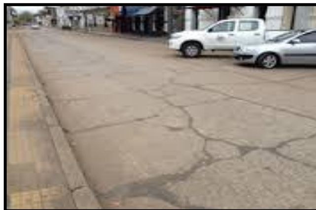
Figura 17: Desconchamiento/Mapa De Grieta/Craquelado.
