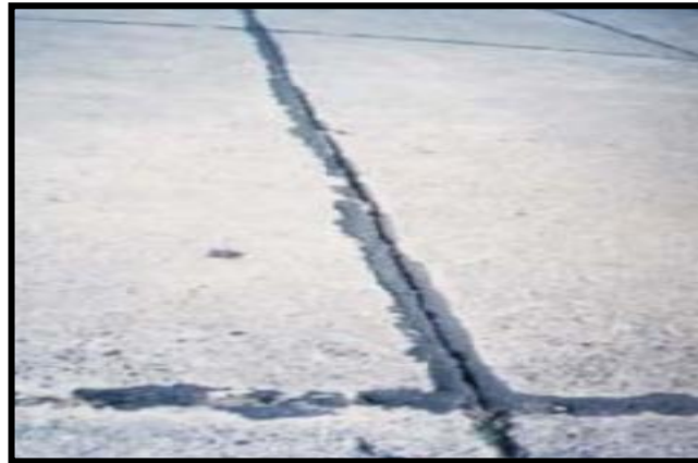
Figura 21: Daño del Sello de la Junta
