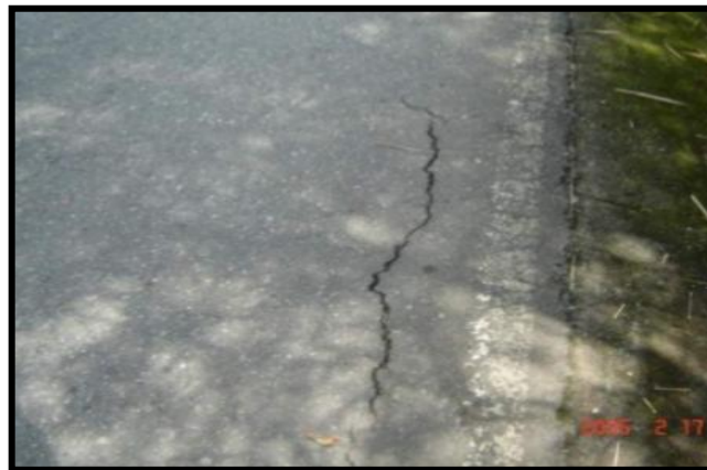
Figura 20: Desnivel de Carril / Berma
