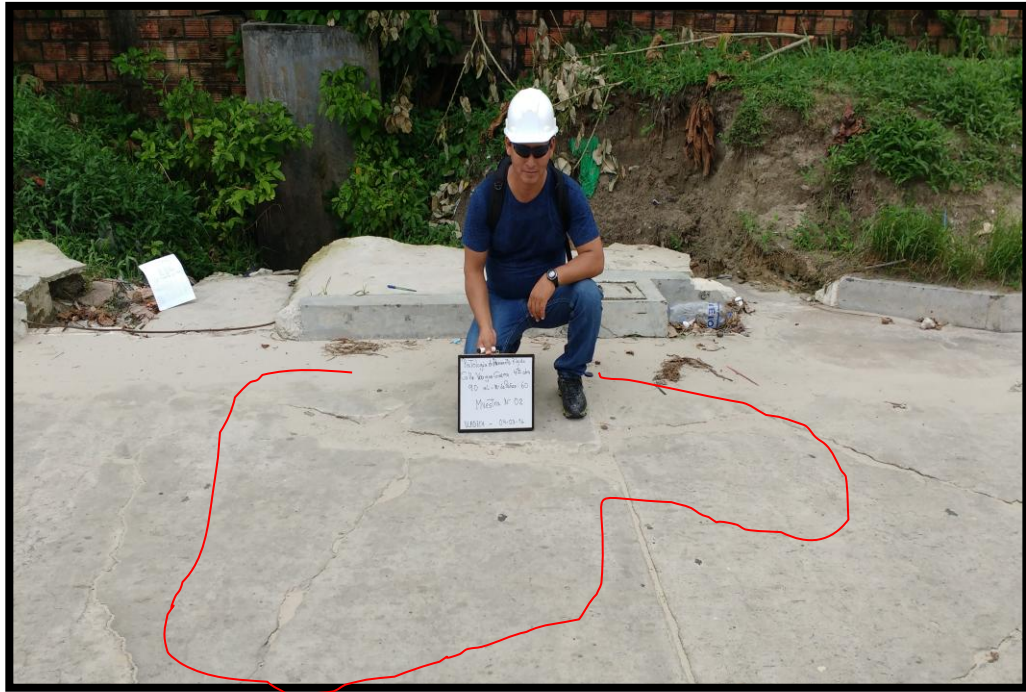
Figura 127: foto grieta lineal de severidad media
