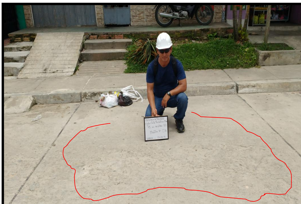
Figura 132: foto punzonamiento de baja severidad.
