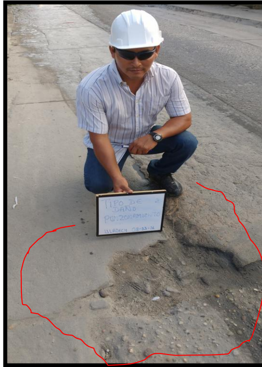
Figura 143: foto de punzonamiento de grieta y punzonamiento de severidad alta
