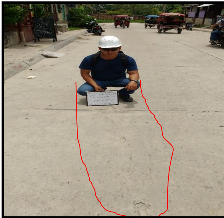
Figura 130: foto de grieta de severidad baja
