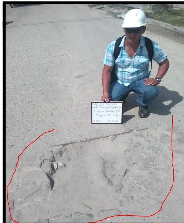
Figura 138: foto punzonamiento severidad baja y grietas de severidad alta
