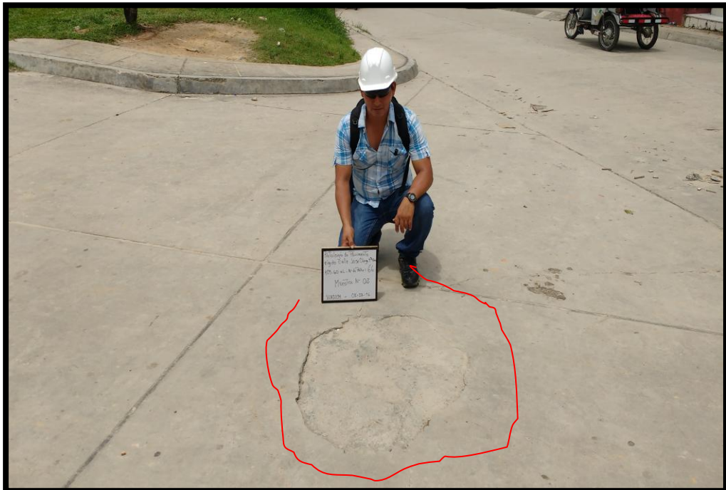
Figura 134: foto punzonamiento de severidad media
