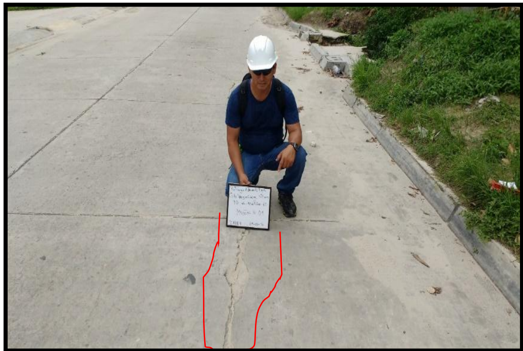
Figura 126: se observa grieta lineal la losa de mediana severidad
