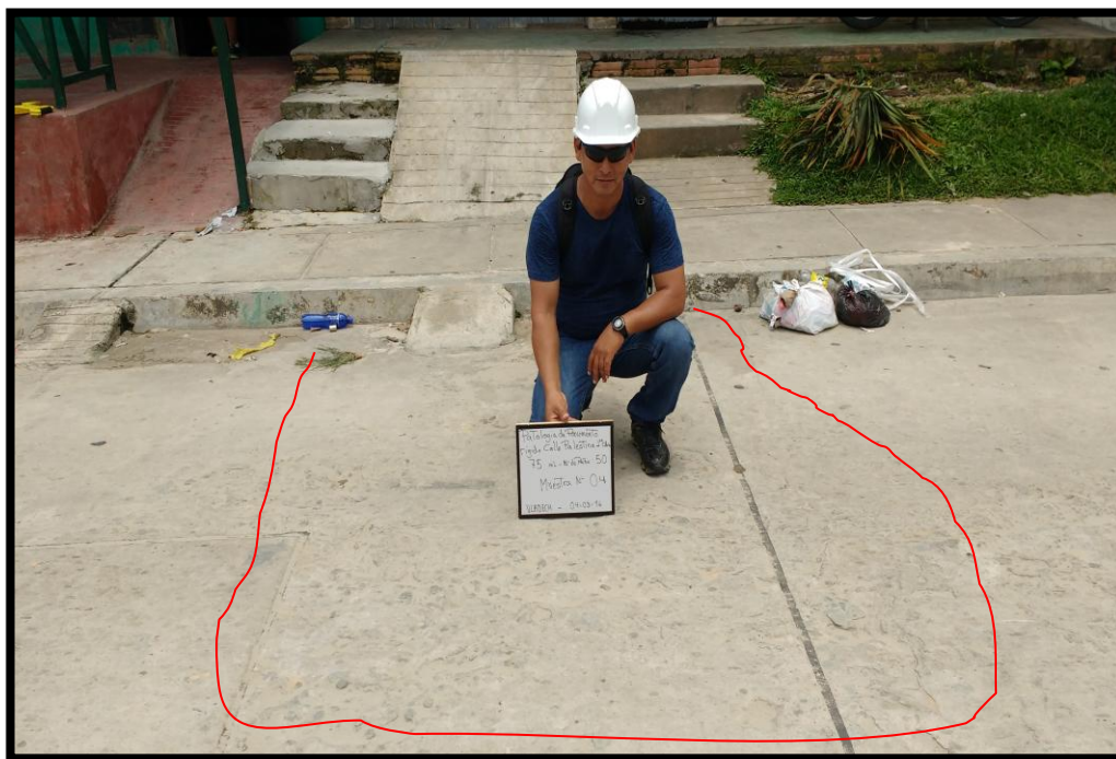
Figura 131: foto de punzonamiento de severidad baja
