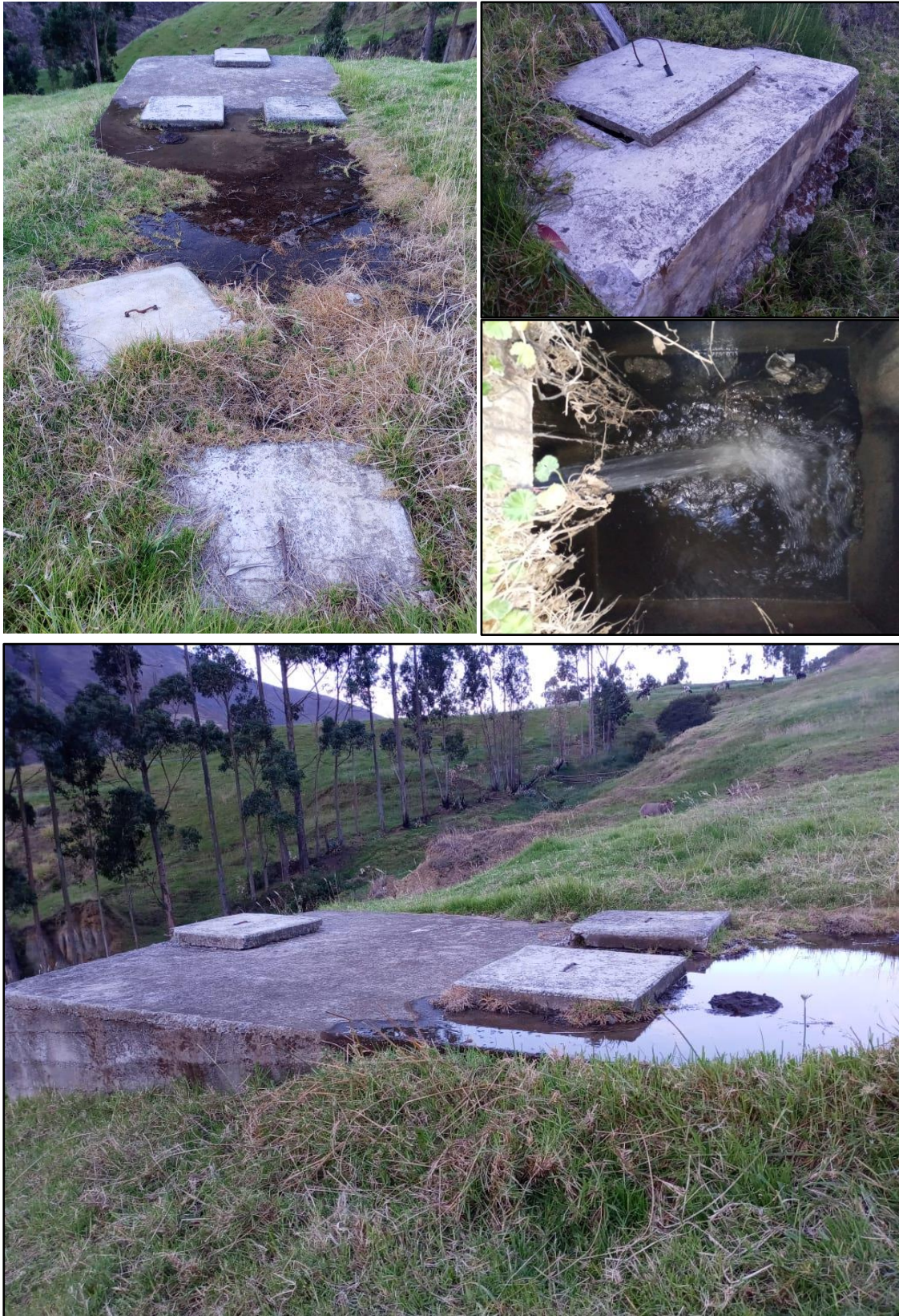
Foto 7: Planta de tratamiento.
