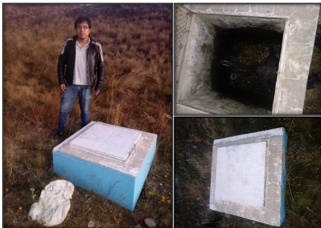
Foto 3: vista de una cámara rompe presión
