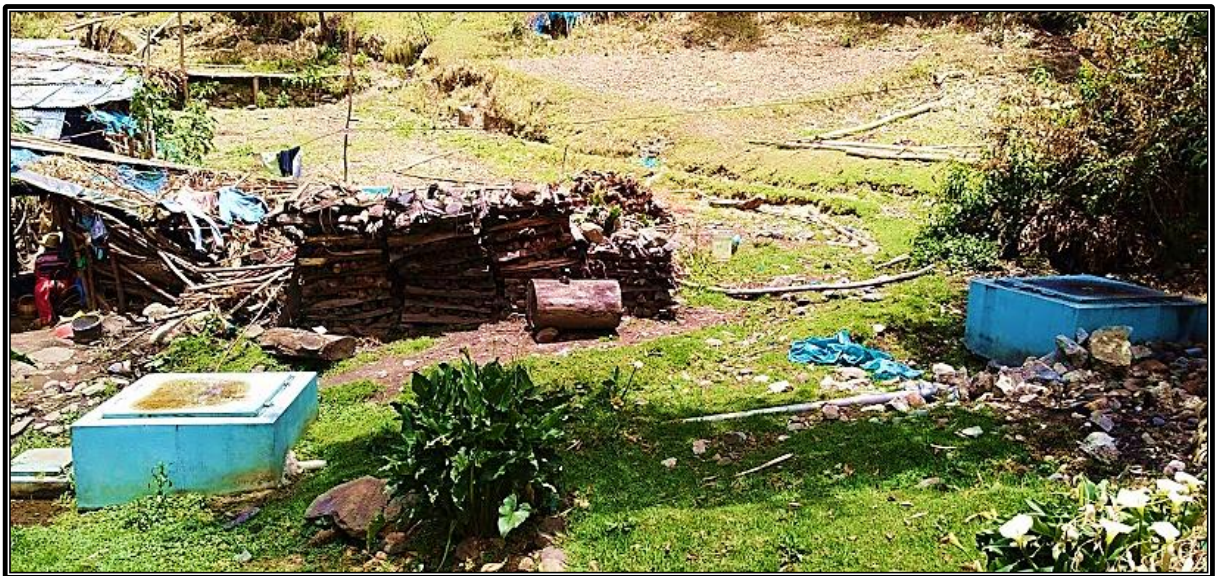
Fotografía 2. De derecha a izquierda, captación y cámara rompe presión tipo 6.
