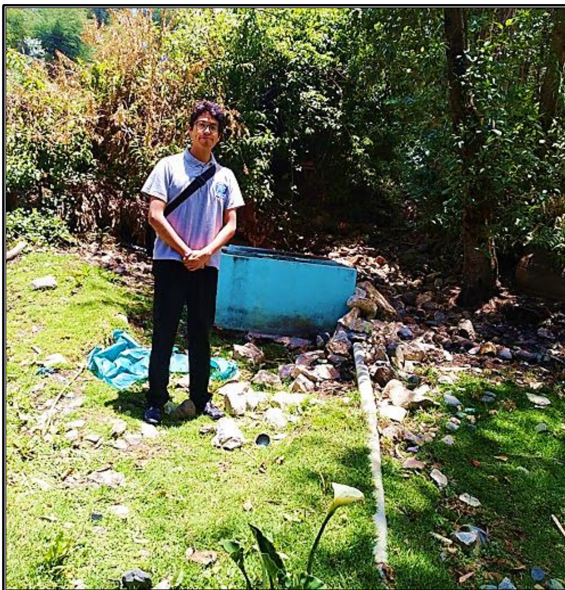
Fotografía 3. Fuente, cámara de captación y tubería de agua.
