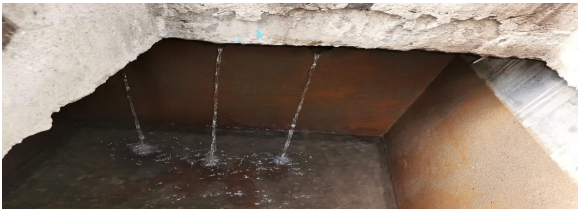
Figura 3: Imagen de Fuente de Ojo del abastecimiento de agua potable, del Barrio Apolo (Fuente Propia)
