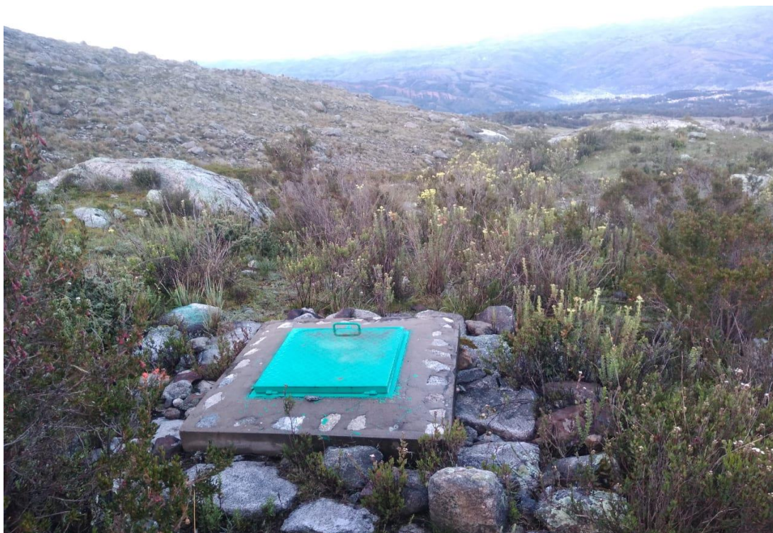
Fotografía 2: Cámara Rompe Presión y se observa la ruta de la línea de conducción
