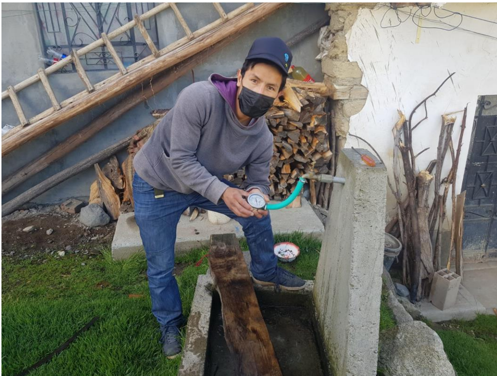
Fotografía 4: Verificando la presión en la primera vivienda
