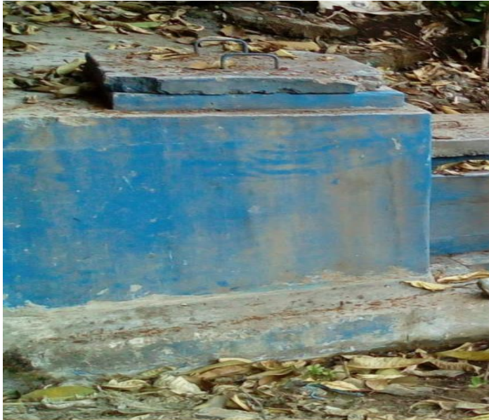
Figura 14 Cámara de captación.
