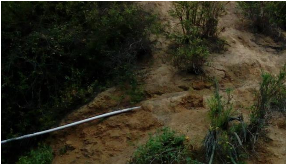
Figura 15 Línea de conducción.
