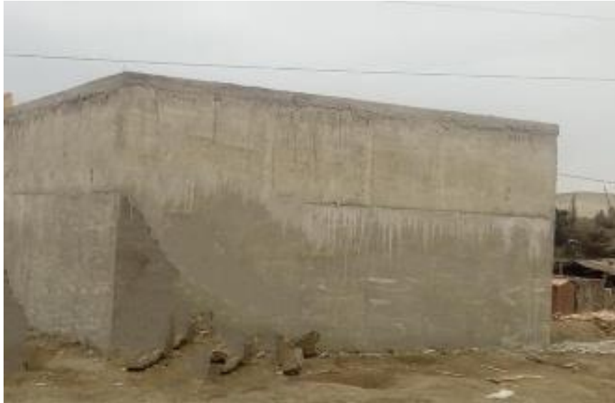
Figura 16 Reservorio de almacenamiento.
