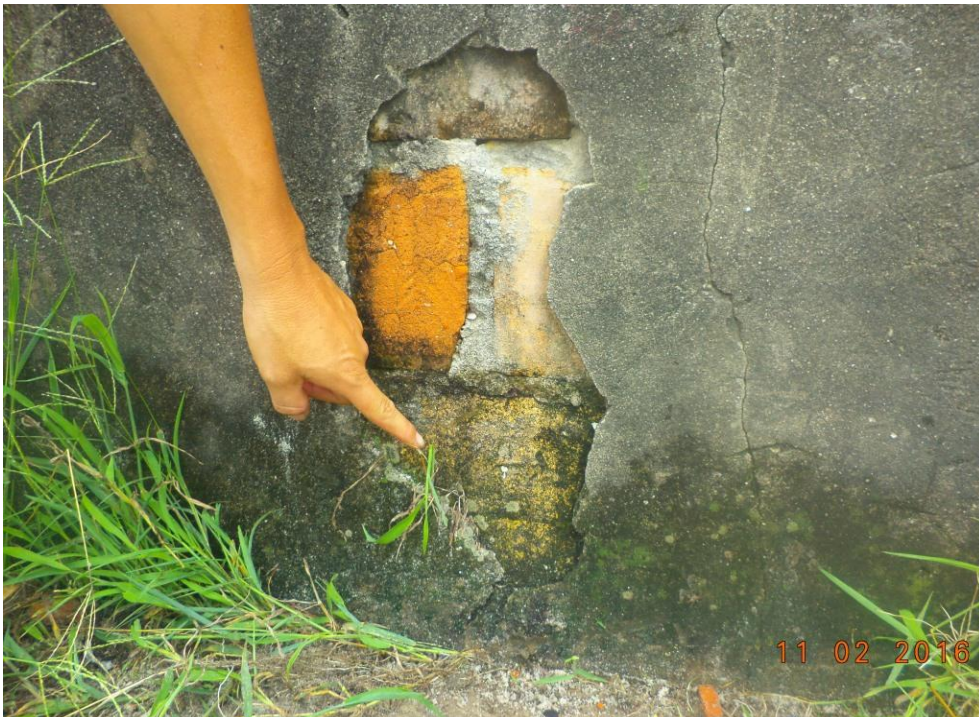
Fotografía 03: Delaminación en muro en la muestra 17
