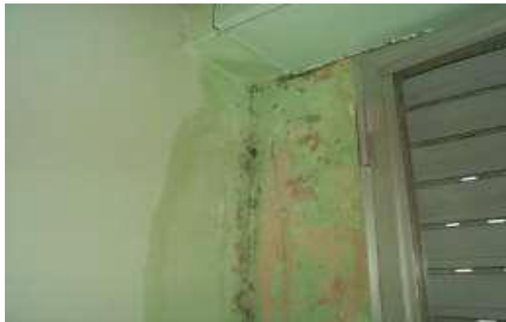
Figura 14. Imagen de filtración
