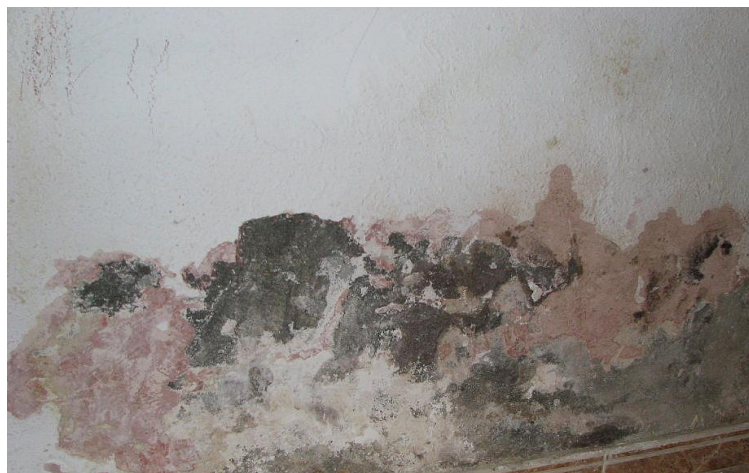
Figura 16. Imagen de humedad en las paredes
