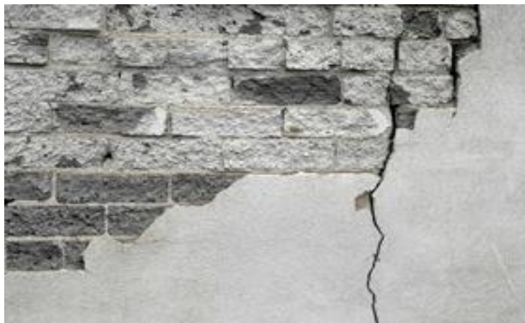
Figura 07. Imagen de grieta de muros
