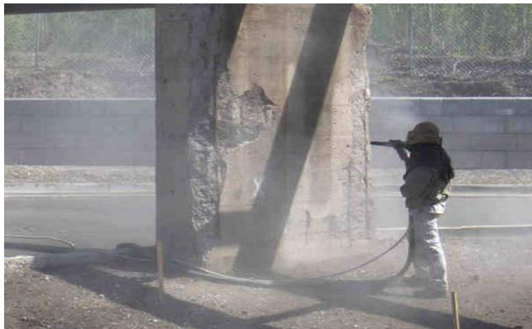
Figura 09. Imagen de delaminación
