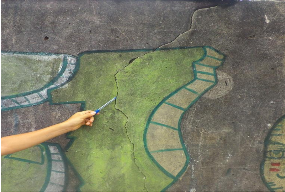
Fotografía 03: Grieta en muro en la muestra 17
