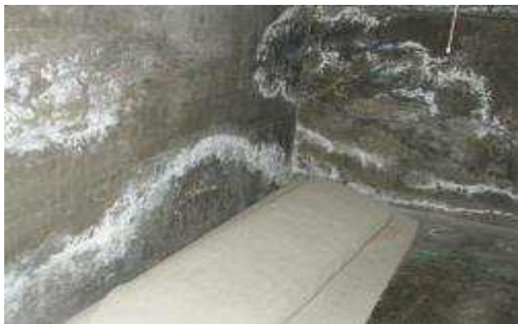
Figura 11. Imagen de eflorescencia en las paredes.
