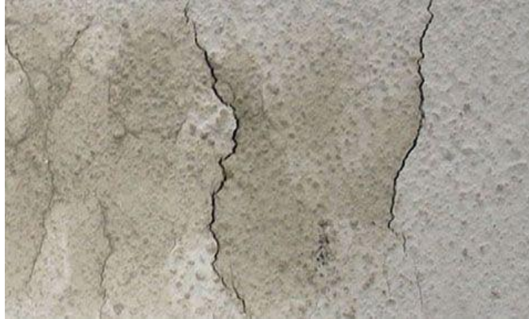
Figura 15. Imagen de fisuras
