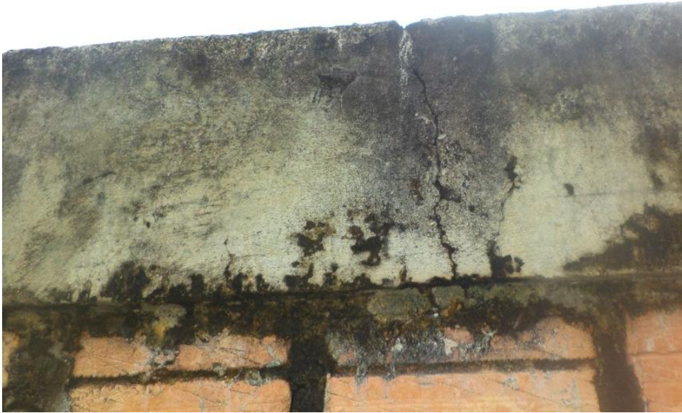
Fotografía 01: Grieta en viga en la muestra 14
