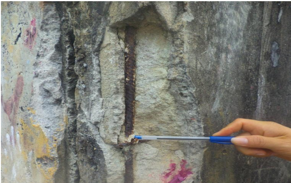
Fotografía 02: Corrosión en columnas en la muestra 15
