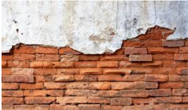
Figura 12. Imagen de erosión en los muros
