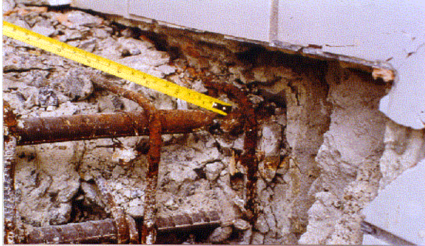
Figura 08. Imagen de corrosión
