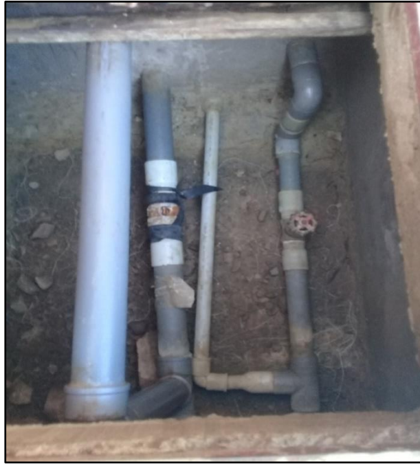
Figura 25: Caseta de válvulas del reservorio. Fuente: Elaboración propia.
