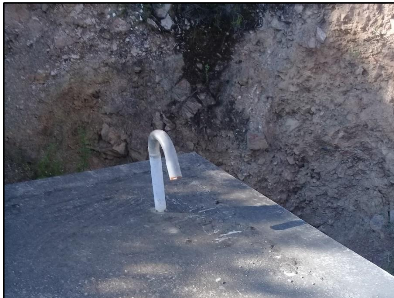
Figura 26: Tubería de ventilación del reservorio. Fuente: Elaboración propia.
