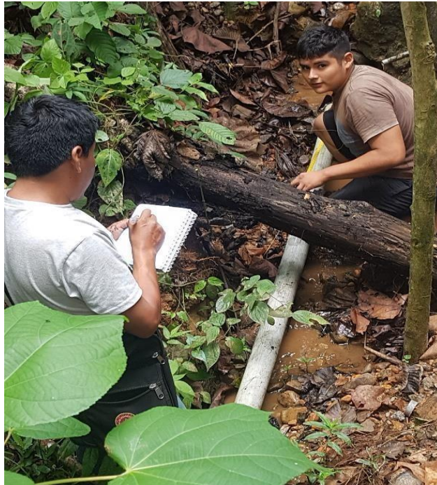
Figura 22: Línea de conducción sin protección al intemperie
