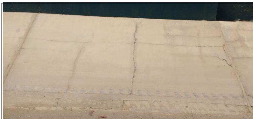
Imagen 30. Grieta Vertical en el Talud Derecho del Canal
