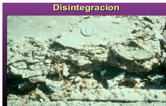
Imagen 14. Desintegración del concreto.
