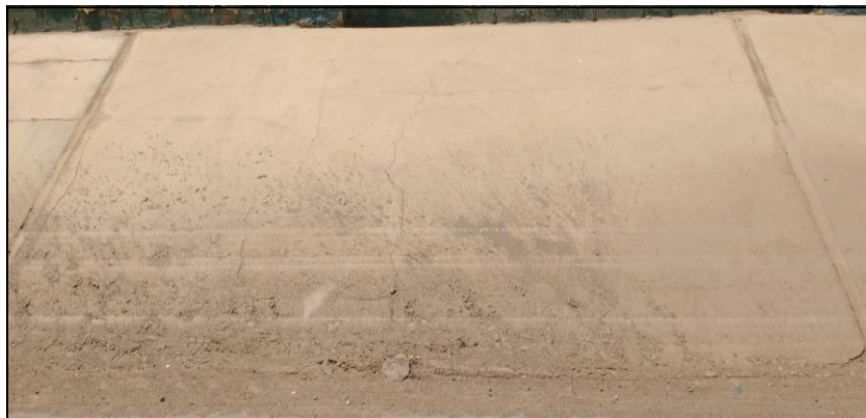
Imagen 38. Fisura Vertical en el Lado Derecho del Canal
