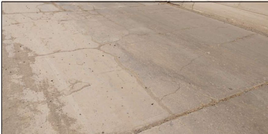
Imagen 34. Grieta Verticales y Horizontales en el Fondo del Canal
