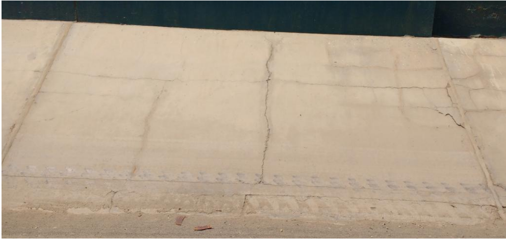
Imagen 11. Grietas en el Concreto
