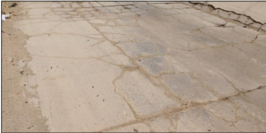
Imagen 35. Grieta Vertical y Horizontal en el Fondo del Canal
