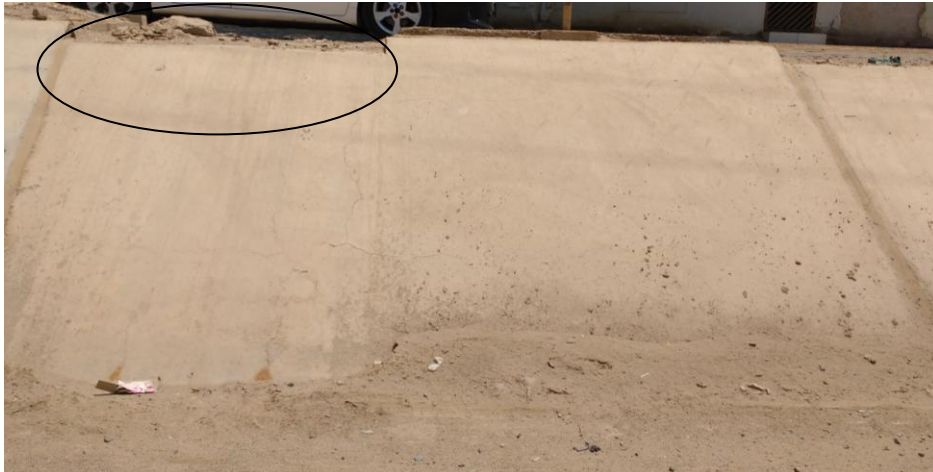
Imagen 47. Desintegración en el Lado Izquierdo del Canal
