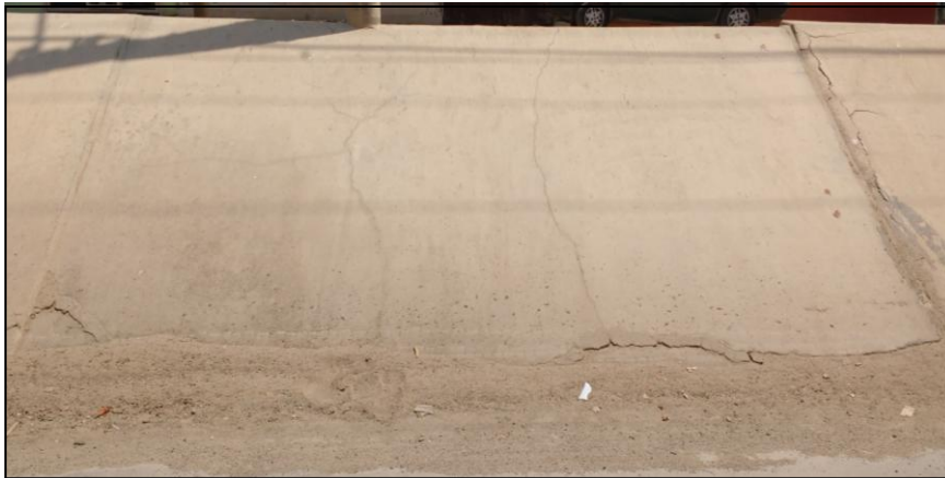
Imagen 39. Fisura Vertical en el Lado Izquierdo del Canal
