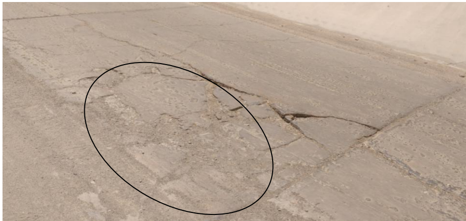
Imagen 46. Erosión en el Fondo del Canal
