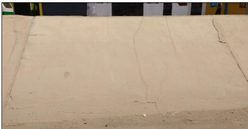
Imagen 29. Grieta Vertical en el Talud Izquierdo del Canal
