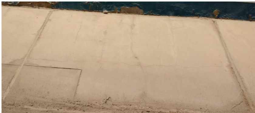
Imagen 12. Fisuras en el Concreto
