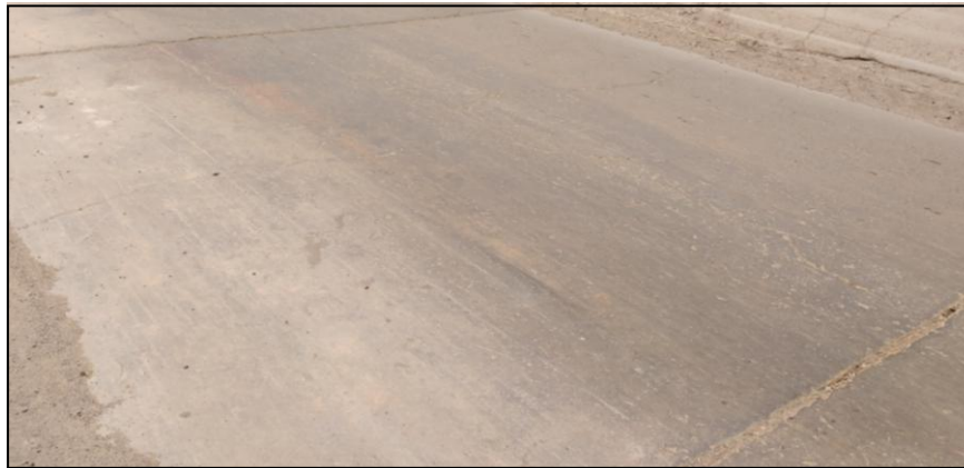
Imagen 43. Fisura Vertical en el Fondo del Canal
