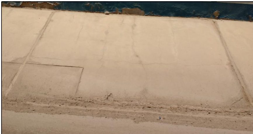
Imagen 36. Fisura Vertical en el Lado Derecho del Canal
