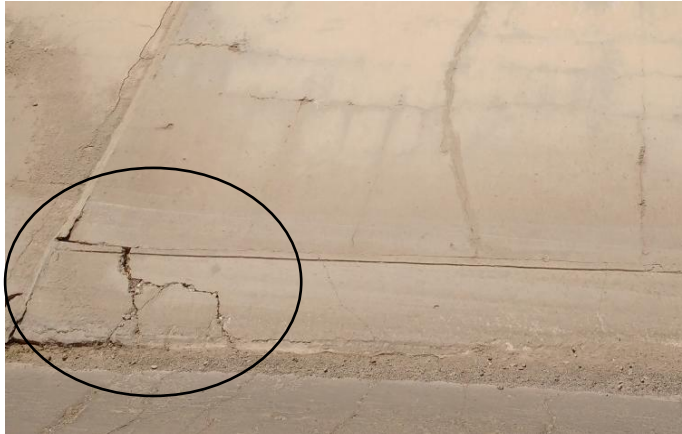
Imagen 17. Distorsión en el concreto.
