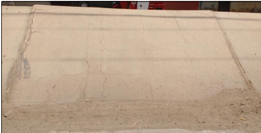
Imagen 40. Fisura Vertical en el Lado Izquierdo del Canal
