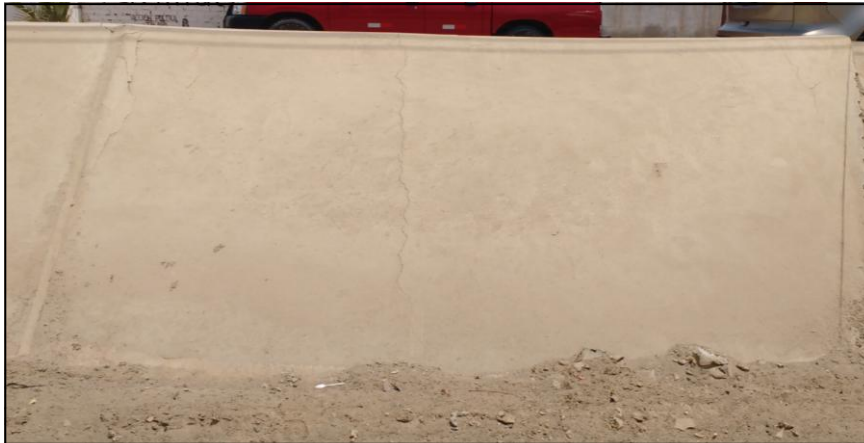
Imagen 41. Fisura Vertical en el Lado Izquierdo del Canal
