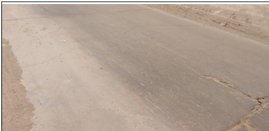
Imagen 42. Fisura Vertical en el Lado Izquierdo del Canal
