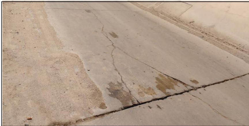
Imagen 33. Grieta Vertical en el Fondo del Canal
