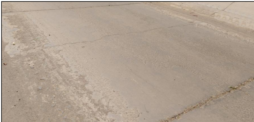
Imagen 44. Fisura Horizontal en el Fondo del Canal
