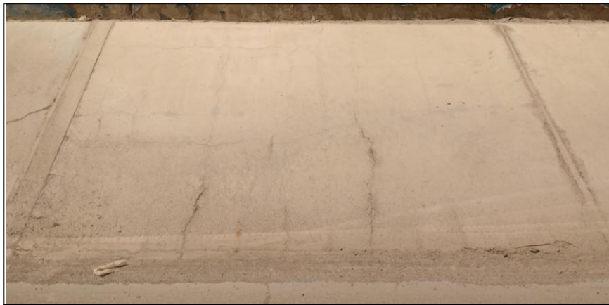
Imagen 37. Fisura Vertical en el Lado Derecho del Canal
