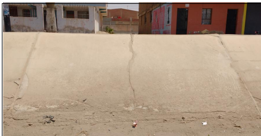
Imagen 28. Grieta Vertical en el Talud Izquierdo del Canal
