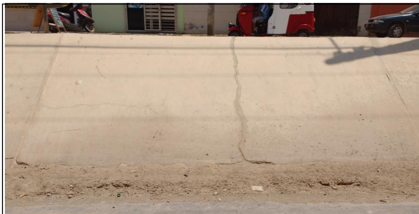
Imagen 27. Grieta Vertical en el Talud Izquierdo del Canal
