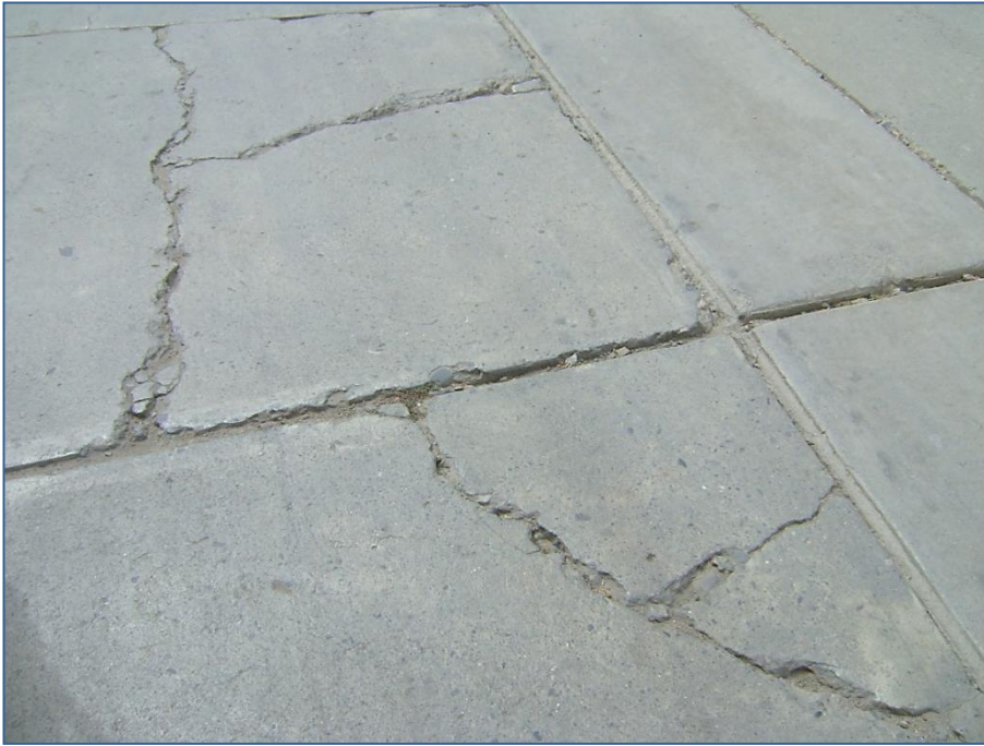
Fotografía N° 17: En la vista se aprecia una grieta de esquina de una severidad alta. Jr. Mariscal Cáceres
