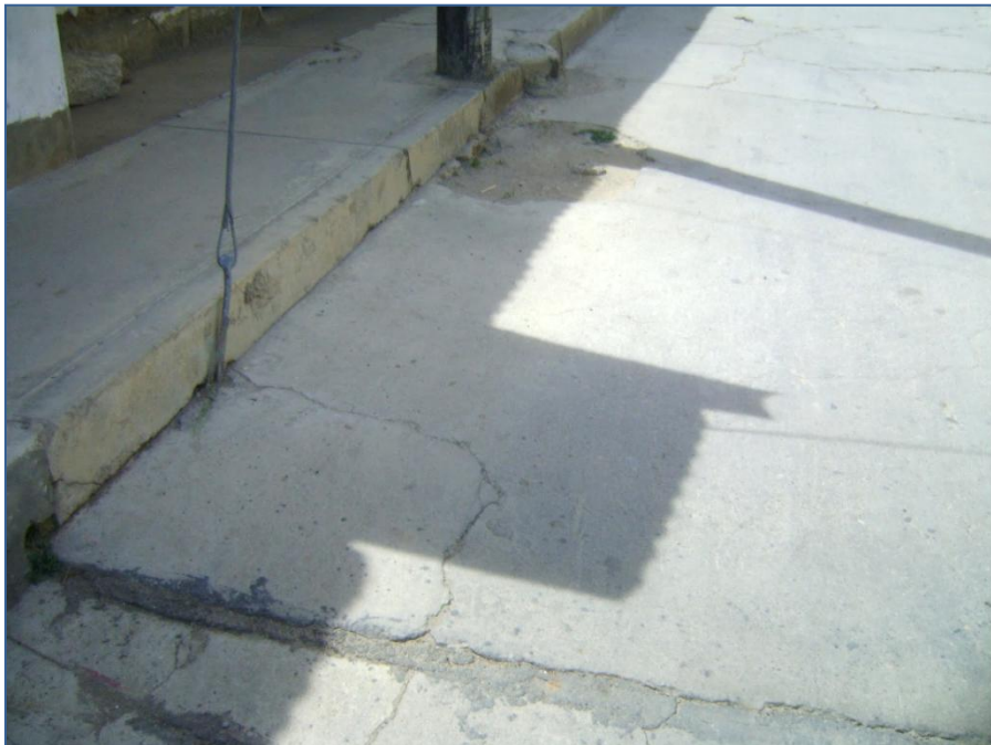
Fotografía N° 16: En la vista se aprecia la grieta de esquina Jr. Mariscal Cáceres
