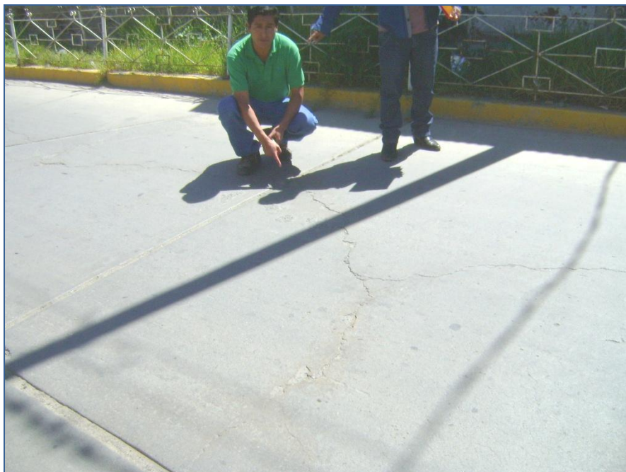
Fotografía N° 06: Mi Persona evaluando el pavimento de la Av. Meza Arizona en este caso se presenta una losa dividida
