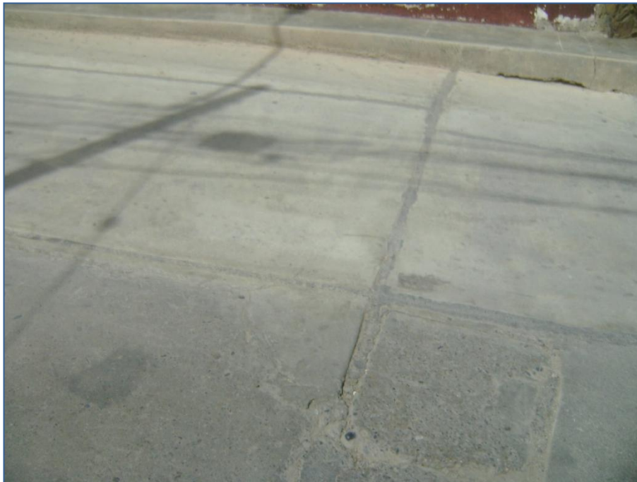
Fotografía N° 18: En la vista se aprecia el parcheo pequeño. Jr. Mariscal Cáceres
