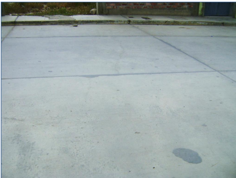
Fotografía N° 22: vista del tipo de falla grieta lineal de severidad baja. Av. Carretera Central
