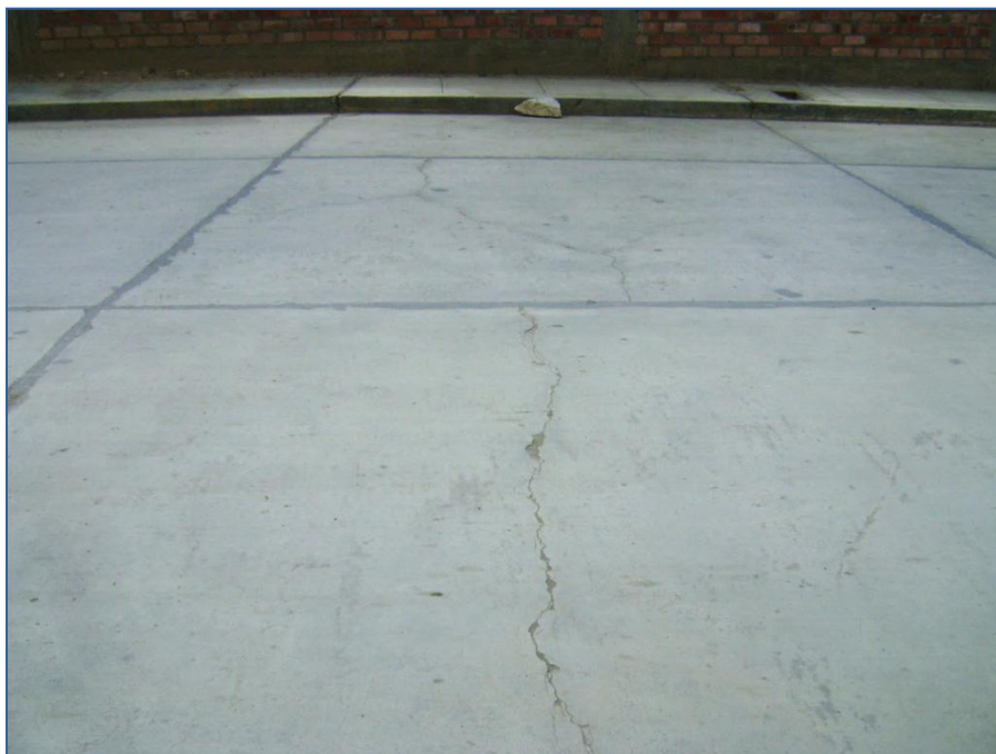
Fotografía N° 20: Vista del tipo de falla losa dividida y grieta lineal respectivamente. Av. Carretera Central
