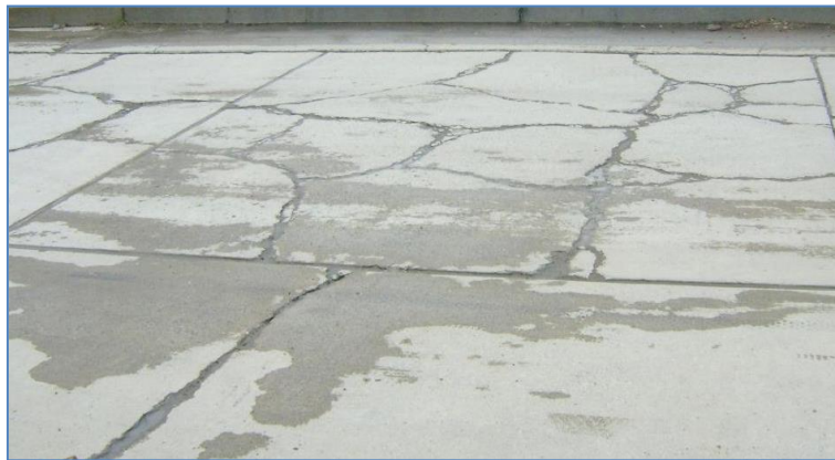
Losa dividida de severidad alta
