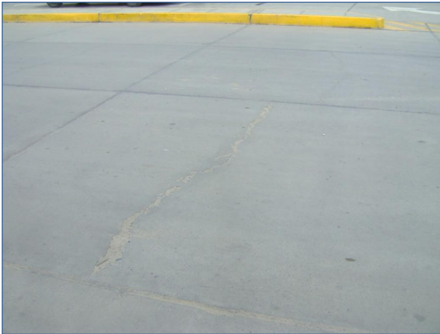
Fotografía N° 21: Vista del tipo de falla grieta lineal de severidad media. Av. Carretera Central
