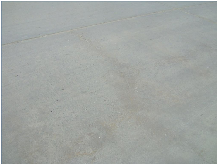
Fotografía N° 05: Vista de la falla losa dividida de severidad baja. Av. Meza Arizona
