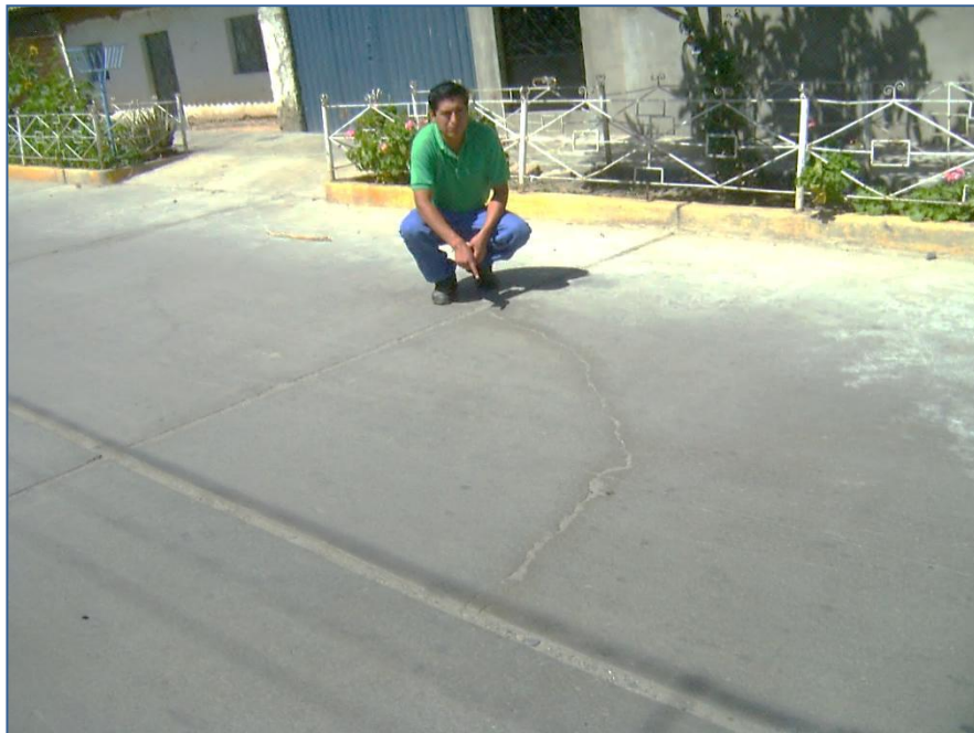
Fotografía N° 03: Mi Persona verificando las fallas, en este caso se aprecia una grieta de esquina. Av. Meza Arizona
