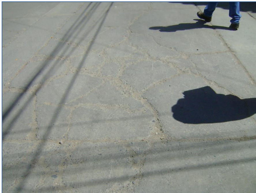
Fotografía N° 08: En la vista se puede apreciar la severidad de la losa dividida en este caso es alto. Av. 20 de enero
