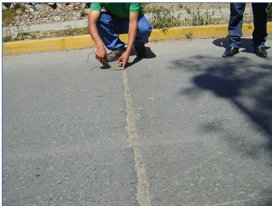
Fotografía N° 04: Mi Persona realizando las mediciones del descascaramiento de junta. Av. Meza Arizona
