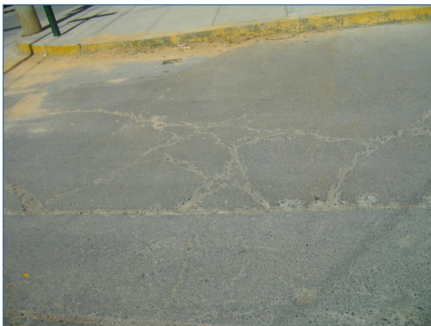
Fotografía N° 10: En la vista se aprecia el tipo de falla losa dividida. Av. 20 de enero
