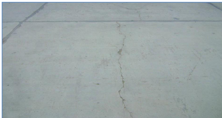
Grietas lineales de baja severidad
