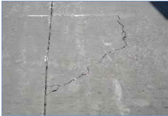
Grieta de esquina de severidad media.
