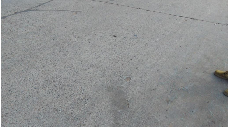
Popouts severidad 01 Cdra. 02
