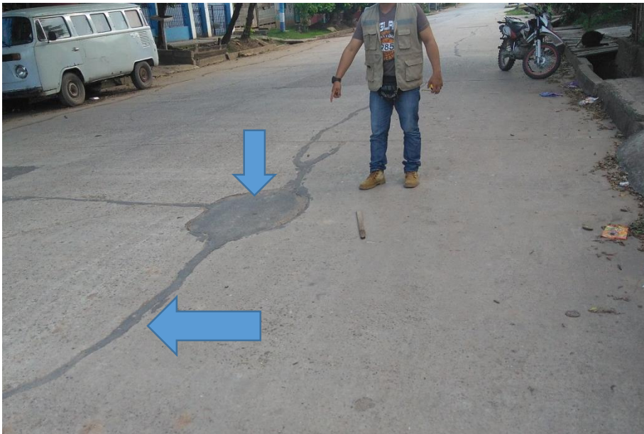
Parche Grande de severidad 02, Grieta Lineal Severidad 02 Cdra. 02
