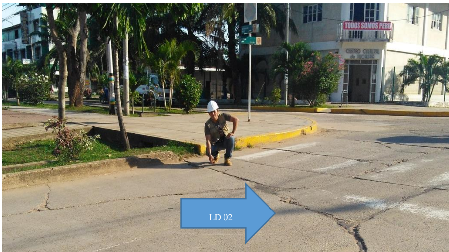
Losa dividida de alta Severidad 02 Cdra. 01
