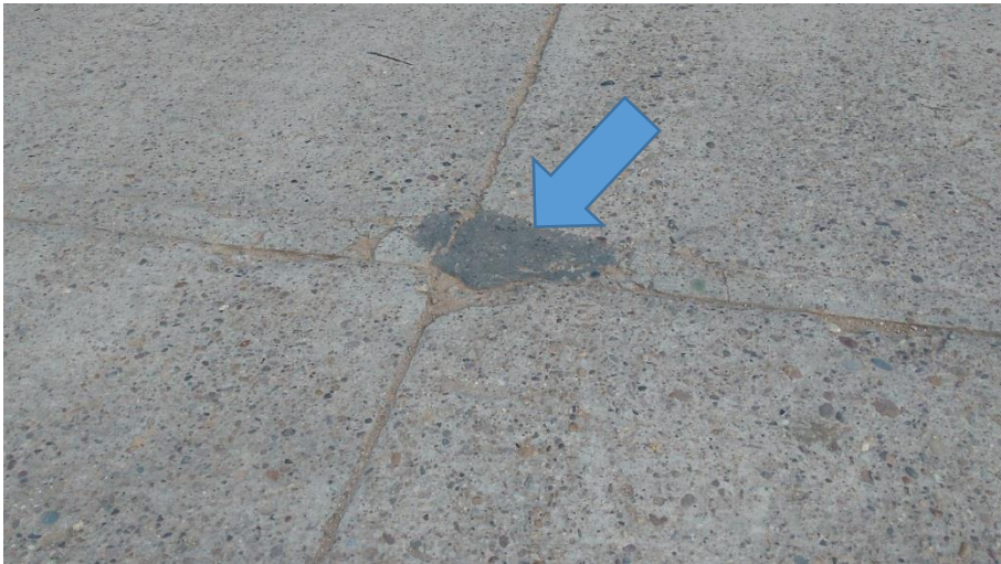
Descascaramiento de esquina de severidad 02 y Pulimento Agregados Cdra. 02
