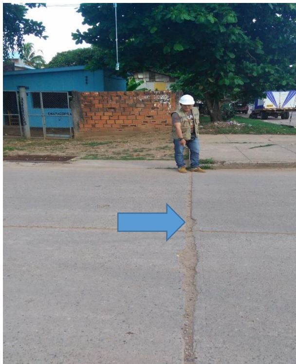
Sella de Junta, Descascamiento de Junta, Descascamiento de Esquina de severidades 02 y pulimento de Agregados Cdra. 03
