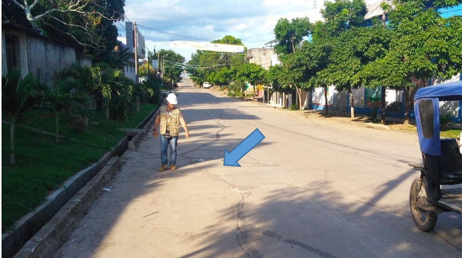
Descascaramiento de Junta de Severidad 3 y Grieta Lineal de severidad 03 Cdra. 01
