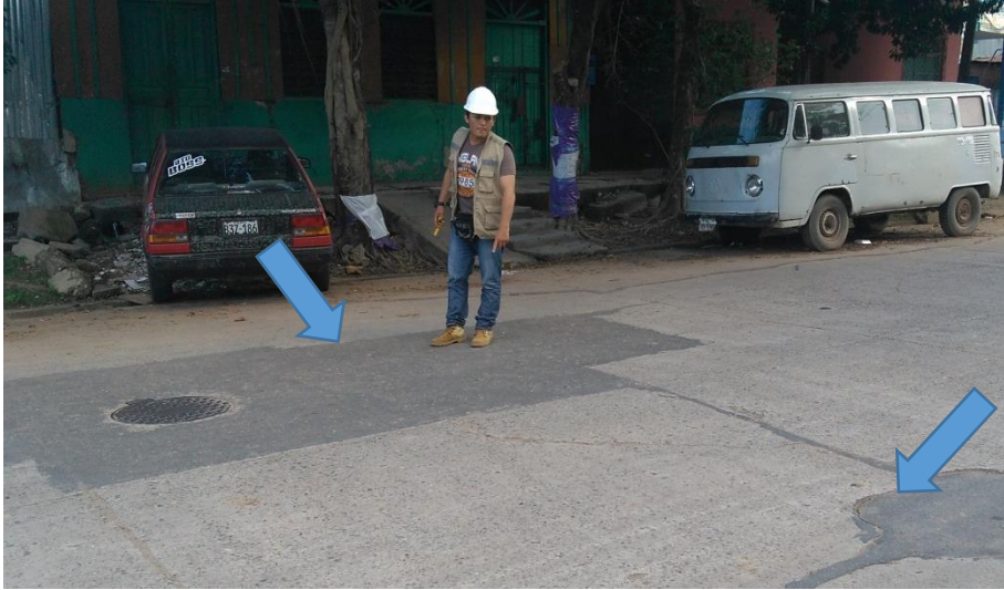
Parqueo Grande de severidad 02, Grieta Lineales severidad 01 Cdra. 02
