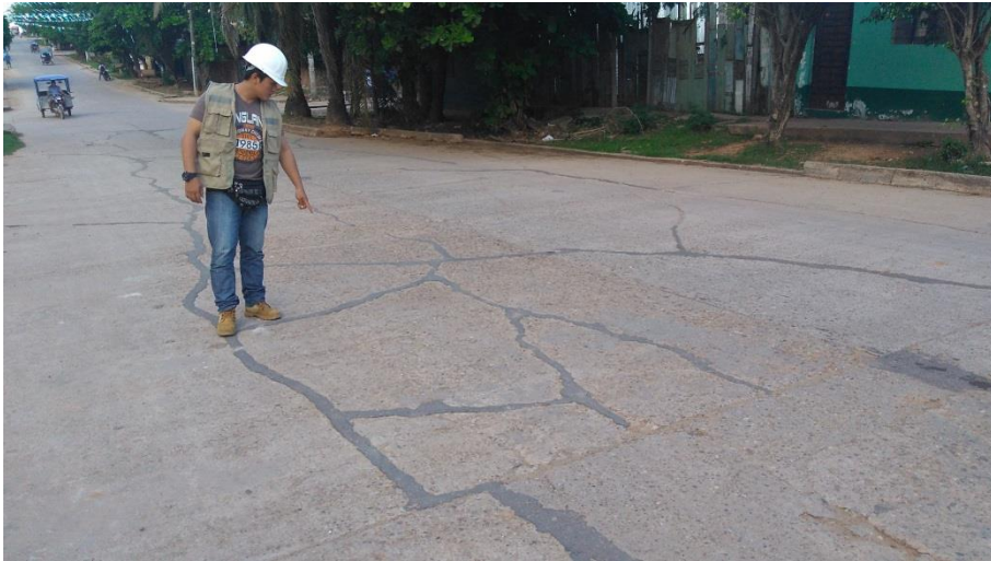
Losa Dividida Severidad 02 Cdra. 02
