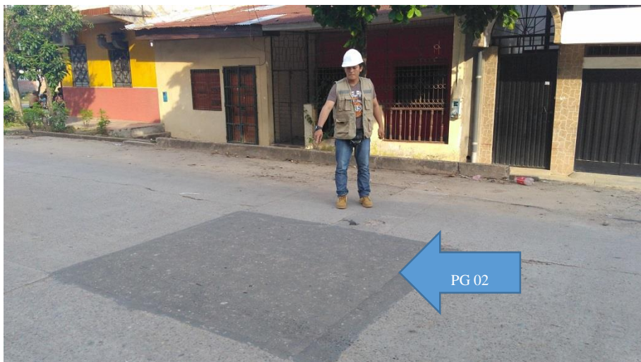
Parqueo Grande severidad 02 Cdra. 01
