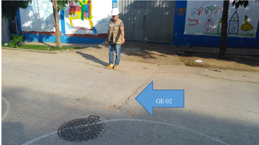
Grieta de Esquina severidad 02 Cdra. 01
