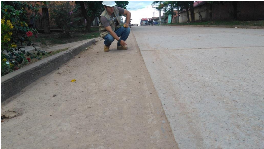
Escala, Sello de juntas, Descascaramiento de Junta de severidades 02 y pulimento de Agregados Cdra. 05
