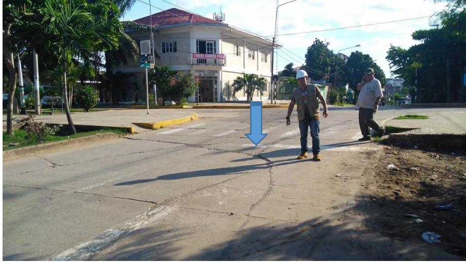
Descascaramiento de Junta severidad 02, Grieta Lineal Severidad 02, Cdr.01
