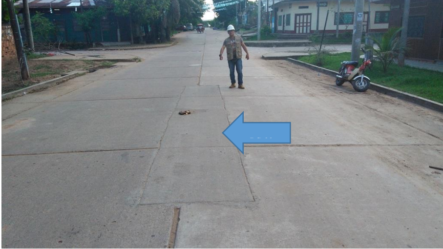
Parche Grande de severidad 02 Cdra. 03
