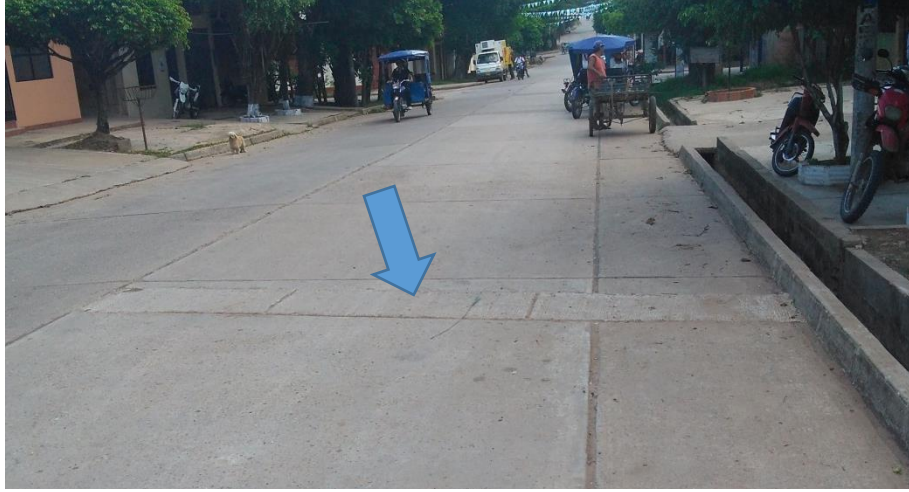
Parche Grande de severidad 02 Cdra.04
