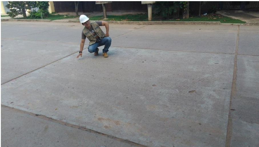
Popouts severidad 01 Cdra. 03
