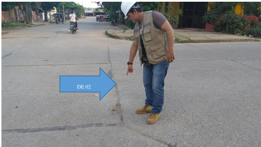
Descascaramiento de Esquina severidad 2, Sello de Junta severidad 2 y Pulimento de Agregado cdra. 01
