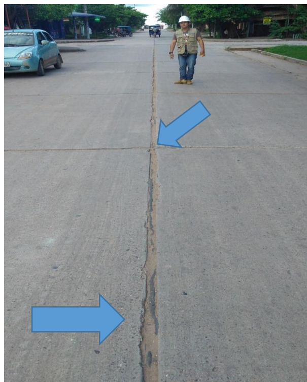
Descascaramiento Junta, Descascaramiento de Esquina, sello de junta de severidades 02, Pulimento de Agregados cdra. 04
