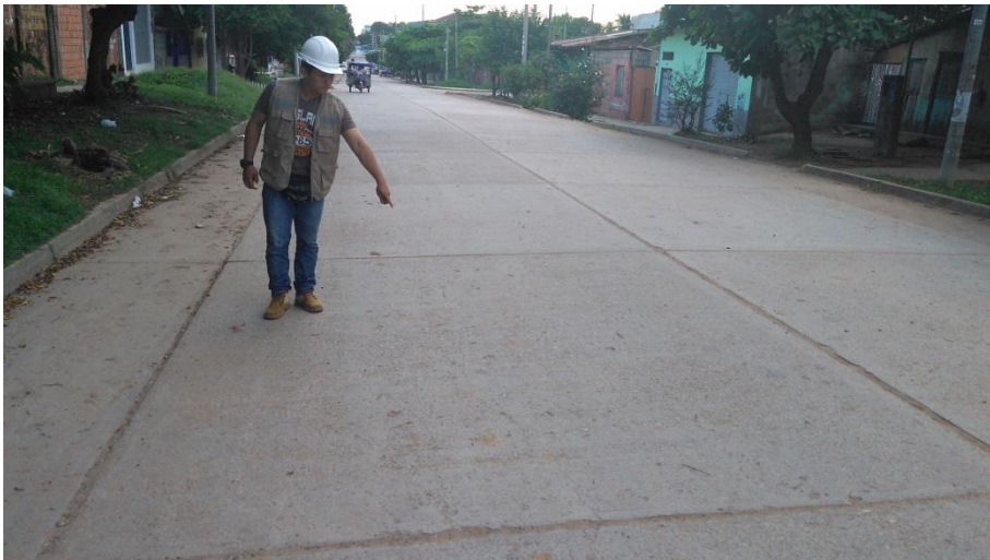
Popouts de severidad 02 y Pulimento de Agregados Cdra. 05
