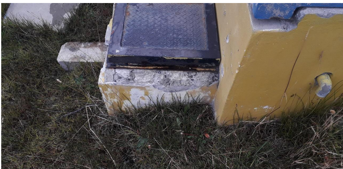
Imagen 10: Cámara de captación del Caserío de Mungurrall, Distrito de Santiago de Chuco, Provincia de Santiago de Chuco, Departamento de La Libertad – 2019
