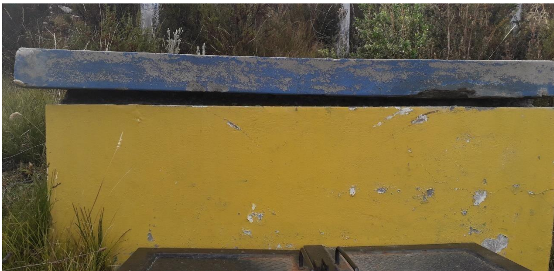
Imagen 11: Cámara de captación del Caserío de Mungurrall, Distrito de Santiago de Chuco, Provincia de Santiago de Chuco, Departamento de La Libertad – 2019
