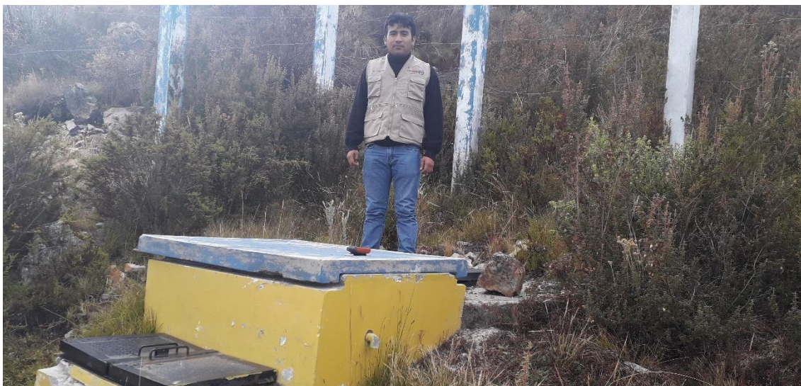
Imagen 9: Cámara de captación del Caserío de Mungurrall, Distrito de Santiago de Chuco, Provincia de Santiago de Chuco, Departamento de La Libertad – 2019
