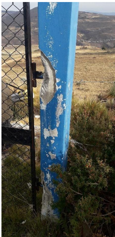
Imagen 13: Cerco perimétrico la cámara de captación del Caserío de Mungurrall, Distrito de Santiago de Chuco, Provincia de Santiago de Chuco, Departamento de La Libertad -2019
