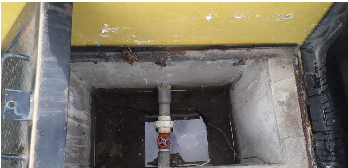
Imagen 12: parte interna de la cámara de captación del Caserío de Mungurrall, Distrito de Santiago de Chuco, Provincia de Santiago de Chuco, Departamento de La Libertad -2019
