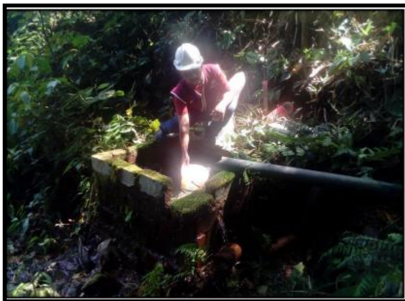
Figura 19: Realizando el aforo de la captación método volumétrico..
