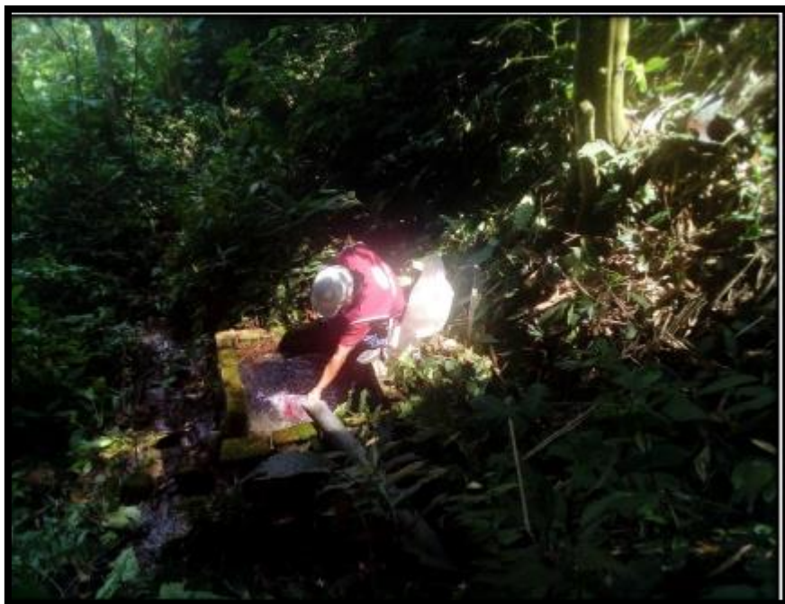
Figura 18: Vista Panorámica de la Captación del centro poblado Alto Santa Clara.
