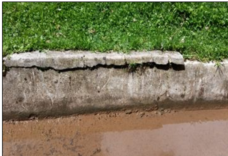
Imagen 14: Desprendimiento del concreto en el talud del canal.
