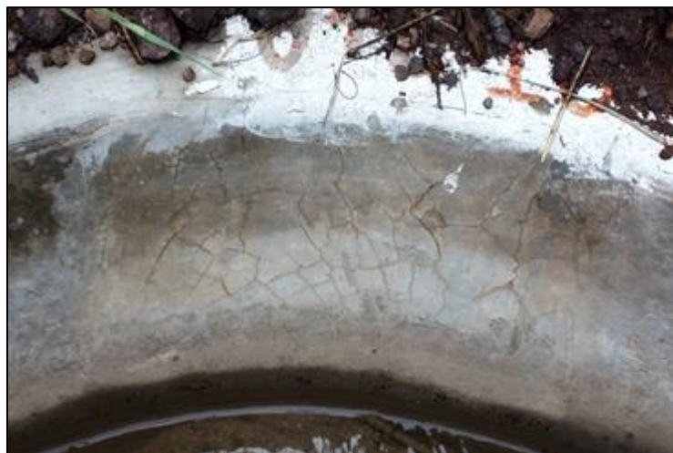
Imagen 11: Fisuras superficiales en la parte lateral de un canal de regadío.
