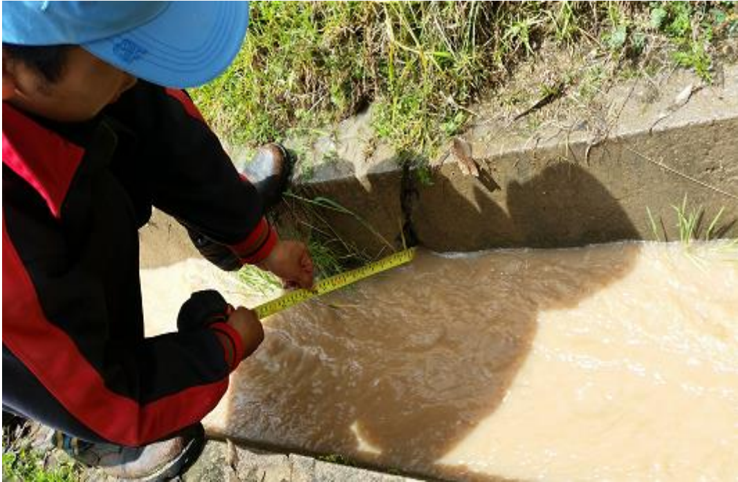
Fotografía 03. Verificación de la patología grieta. tramo (1+400 - 1+450).
