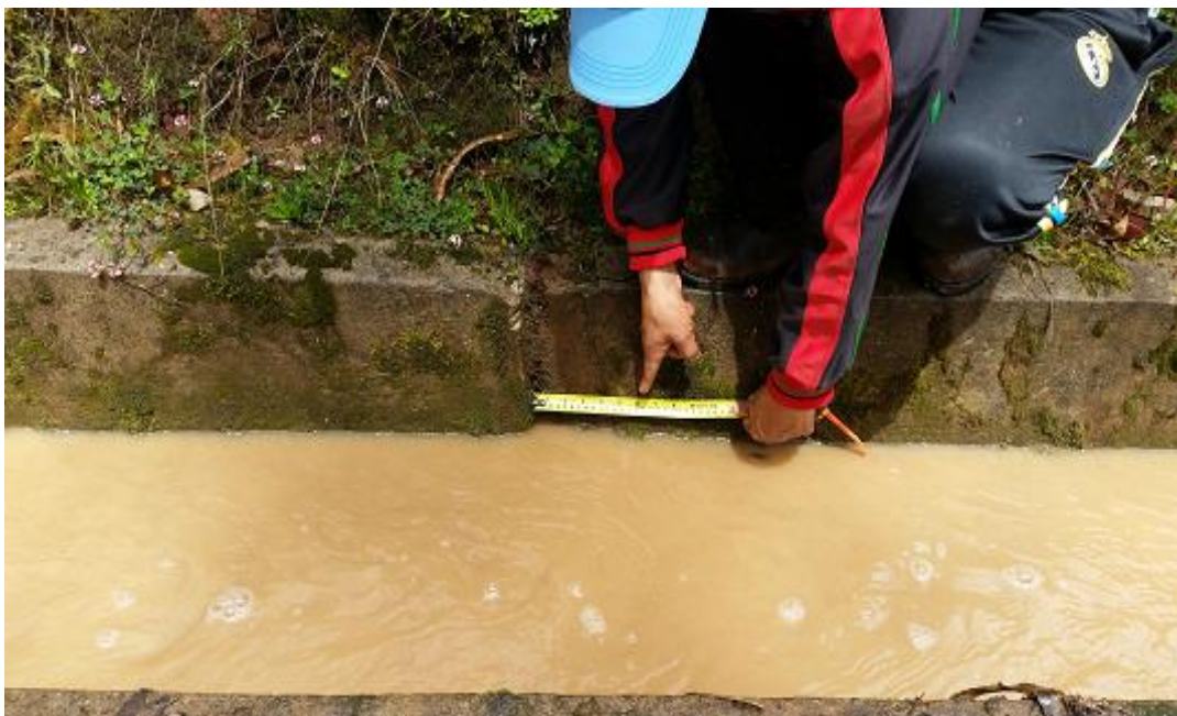
Fotografía 04. Verificación de la patología de Sello de junta en el tramo (1+450 - 1+500).
