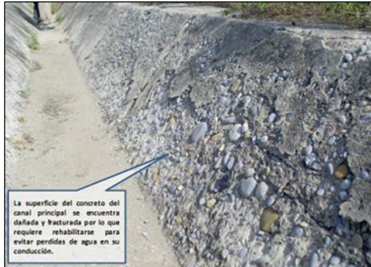
Figura 09: Desintegración en la cara lateral de un canal de concreto. (Fuente: Propia., 2017)
