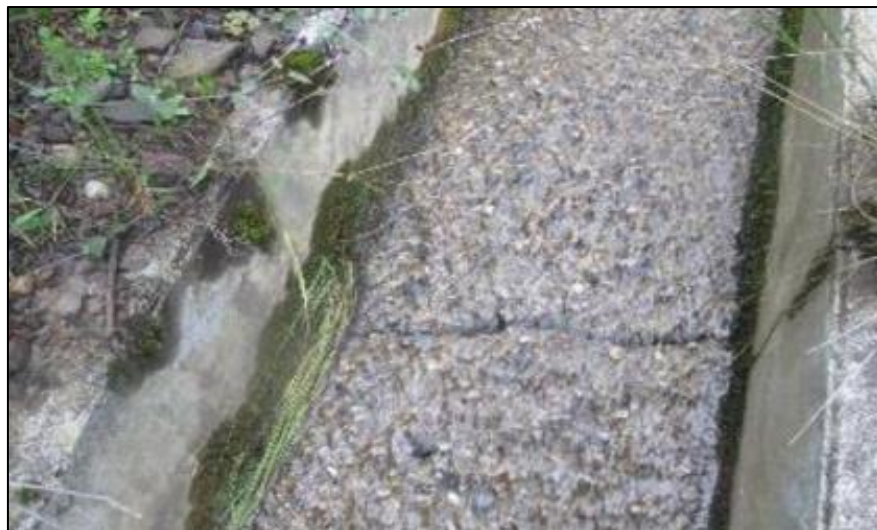
Imagen 10: Fenómeno de erosión en la base de un canal de concreto. (Fuente: Rivva E., 2006)
