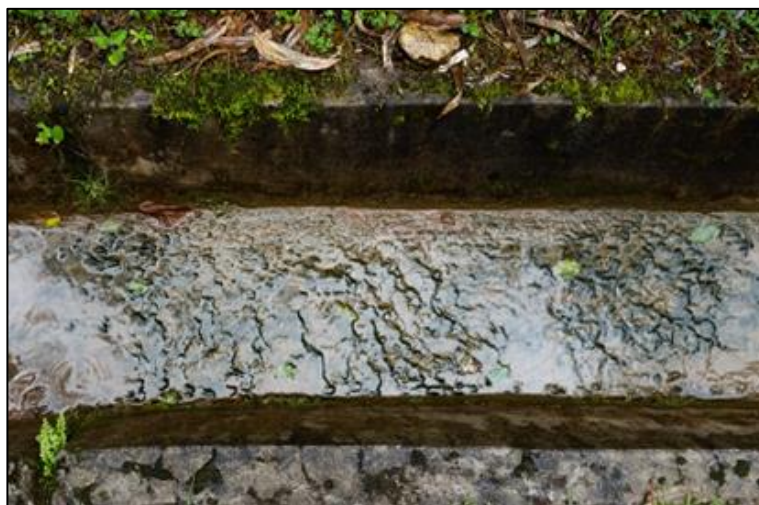
Figura 08: Imagen de hongos en la base del canal. (Fuente: Propia., 2017)
