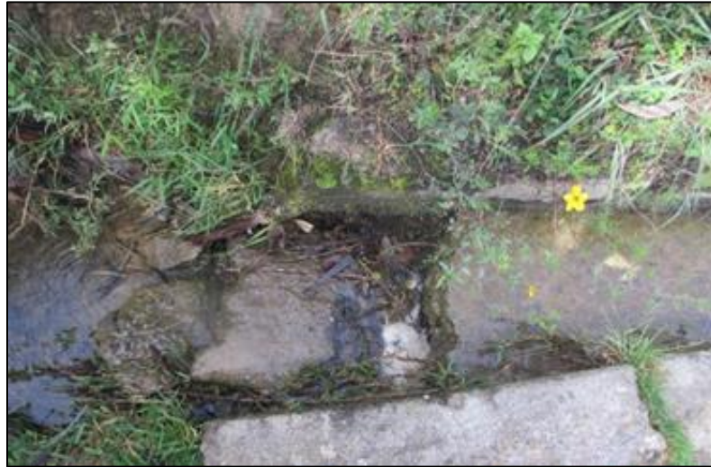
Imagen 15: Hundimiento de la base de concreto del canal.
