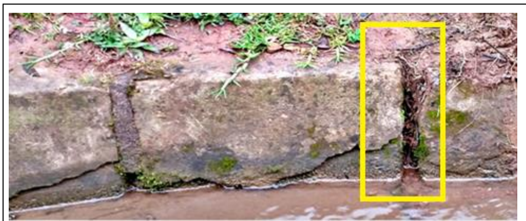
Fotografía 07. Presencia de la patología denominado Fisura
