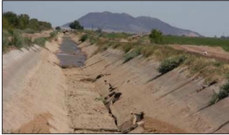
Imagen 12: Agrietamiento en un canal trapezoidal.
