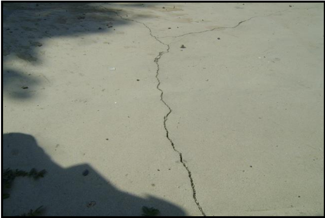
Foto N° 01 Ejemplo de Grietas en Losas de Concreto
