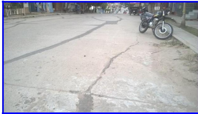
Figura N° 99: Patología de grieta lineal con severidad Alta en la cuadra 1 del Jr. Coronel Portillo
