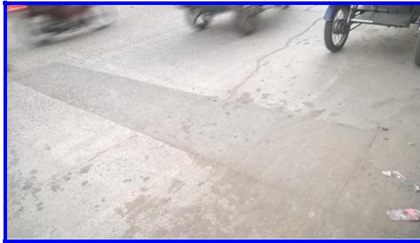
Figura N° 116: Patología de parche grande con severidad baja en la cuadra 4 del Jr. Coronel Portillo
