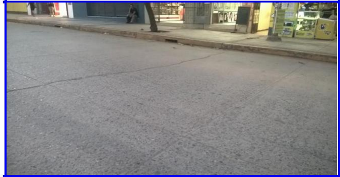
Figura N° 120: Patología de grieta lineal con severidad alta en la cuadra 5 del Jr. Coronel Portillo
