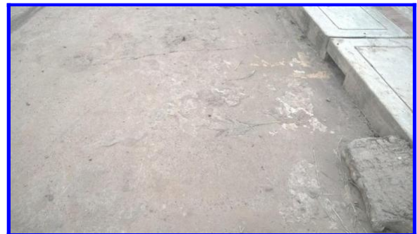
Figura N° 101: Patología de grieta de esquina con severidad Baja en la cuadra 2 del Jr. Coronel Portillo
