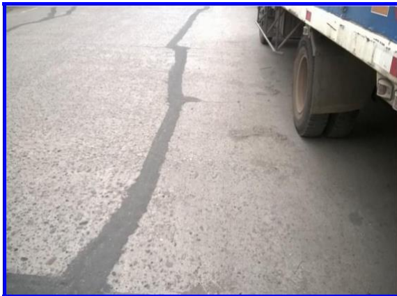
Figura N° 108: Patología de grieta lineal con severidad alta en la cuadra 3 del Jr. Coronel Portillo
