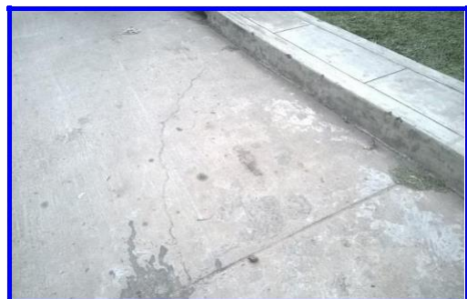
Figura N° 98: Patología de grieta de esquina con severidad Baja en la cuadra 1 del Jr. Coronel Portillo
