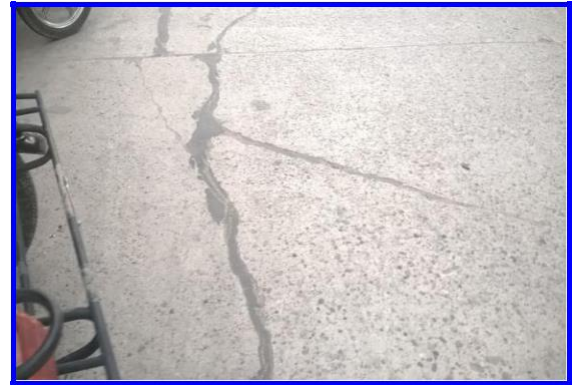
Figura N° 107: Patología de grieta de esquina con severidad baja en la cuadra 3 del Jr. Coronel Portillo
