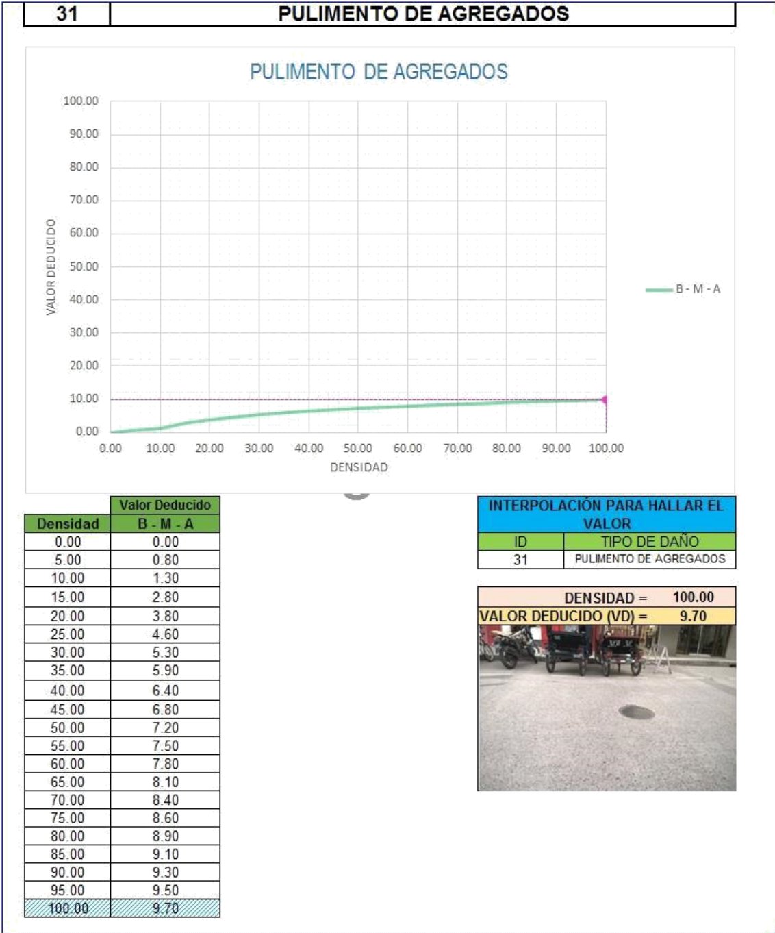
Figura 55: Patología Pulimento de Agregados, Unidad de Muestra 3
