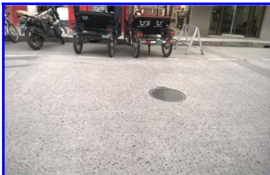
Figura N° 110: Patología de pulimento de agregados sin severidad en la cuadra 3 del Jr. Coronel Portillo
