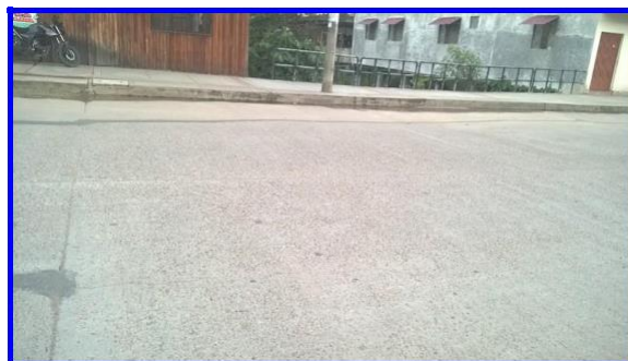
Figura N° 102: Patología de pulimento de agregados sin severidad en la cuadra 2 del Jr. Coronel Portillo
