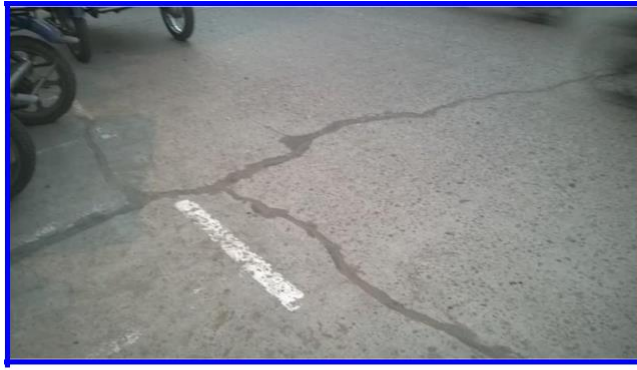
Figura N° 119: Patología de losa dividida con severidad baja en la cuadra 5 del Jr. Coronel Portillo
