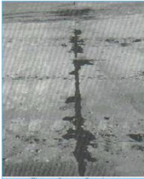
Figura 25: Bombeo por deflexión de a losa
