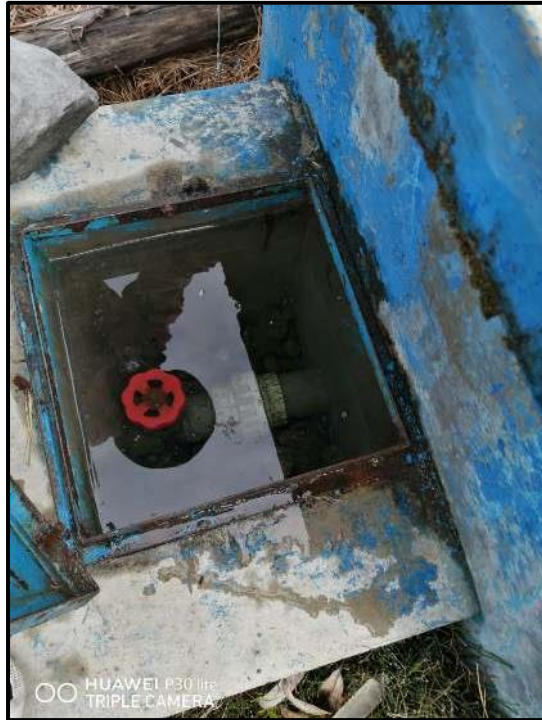
Fotografía 05: Verificación de la captación que abastecerá al caserío Isco.
