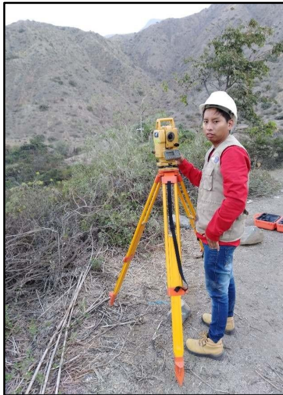
Fotografía 02: Levantamiento topográfico en el caserío Isco con estación total para la toma de datos para elaboración planos topográficos.
