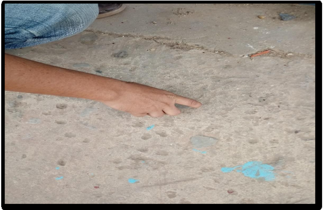
Figura 73: Tipo de daño – Desconchamiento (Baja)
