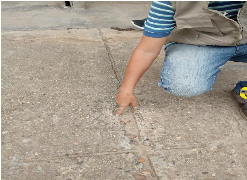
Figura 79: Tipo de daño – Descascaramiento de Esquina (Baja)
