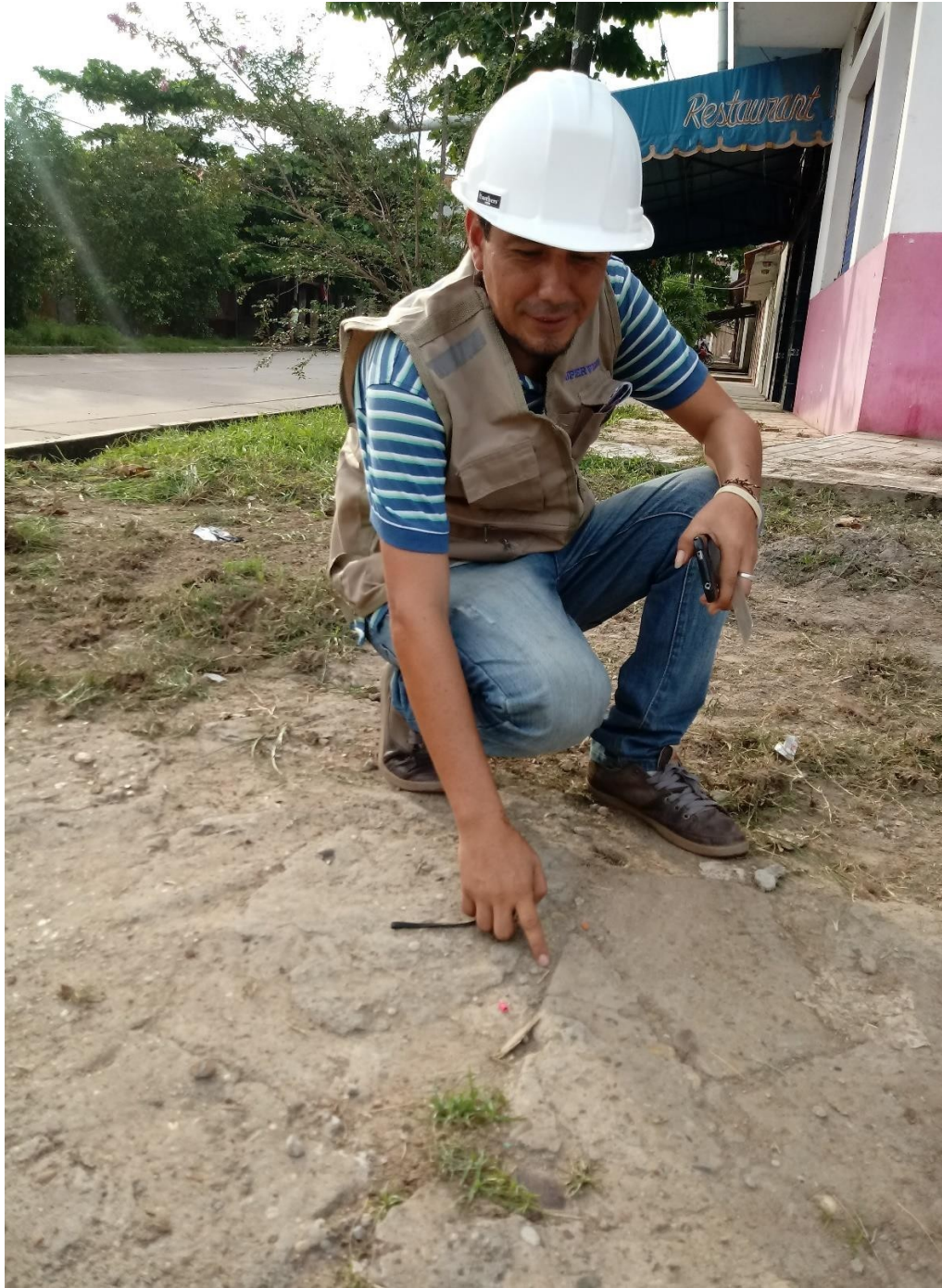
Figura 75: Tipo de daño – Punzonamiento (Baja)
