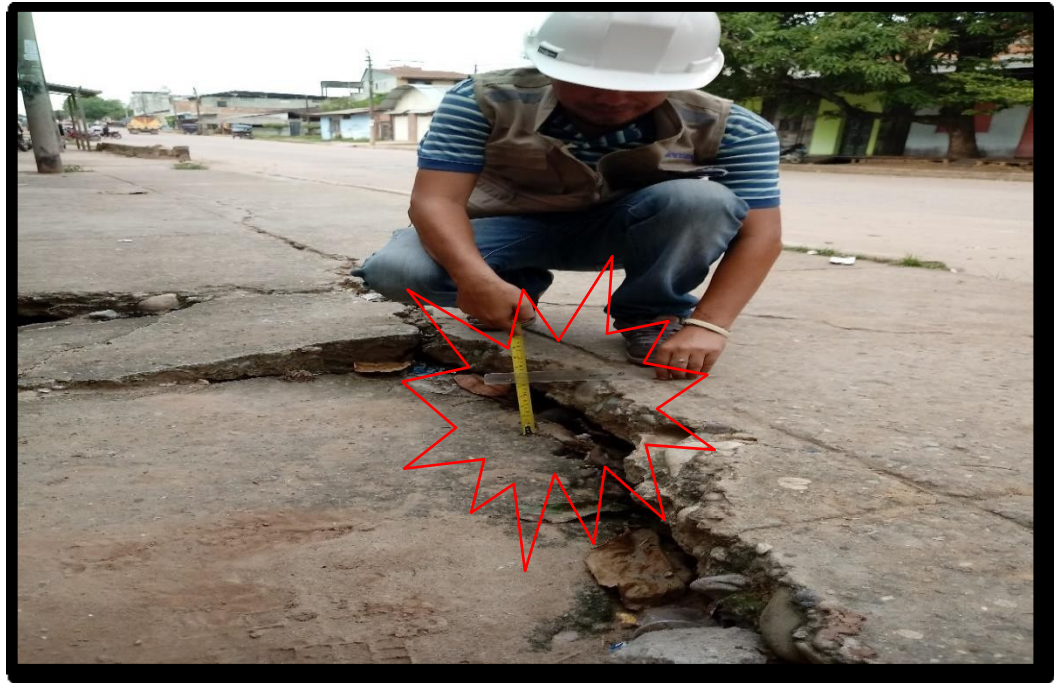
Figura 69: Tipo de daño – Escala (Alta)
