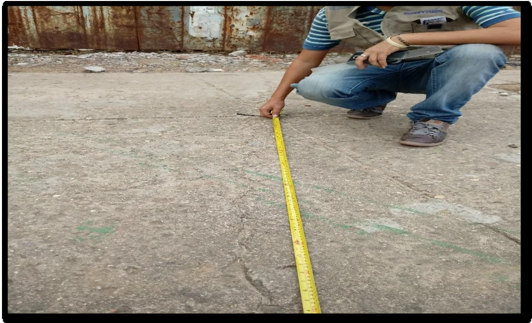
Figura 72: Tipo de daño – Grieta Lineal (Baja)
