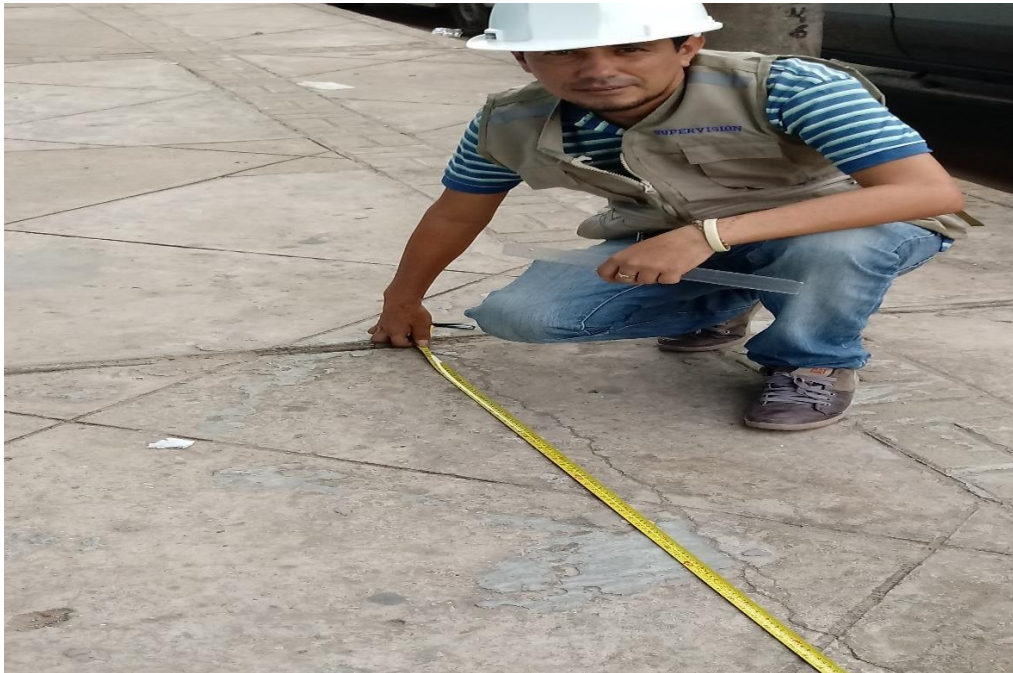
Figura 77: Tipo de daño – Grieta Lineal (Baja)
