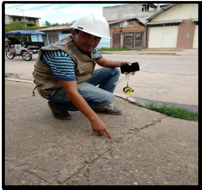
Figura 70: Tipo de daño – Descascamiento de Esquina (Medio)
