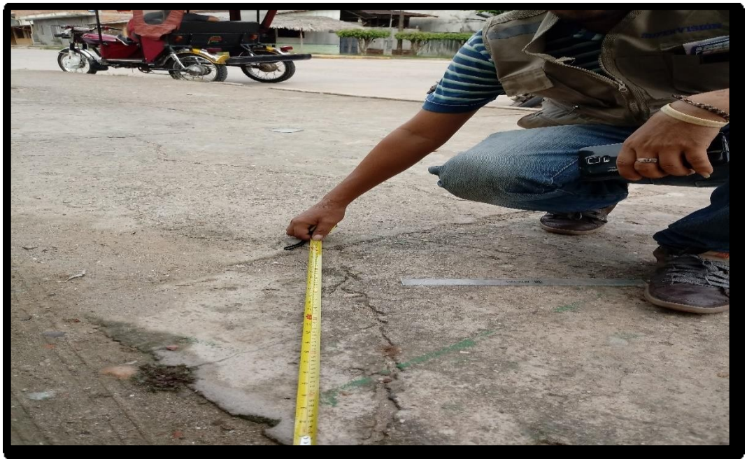
Figura 74: Tipo de daño – Grieta de Esquina (Baja)
