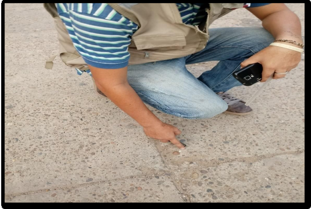
Figura 65: Tipo de daño – Pulimiento de Agregado (Baja)
