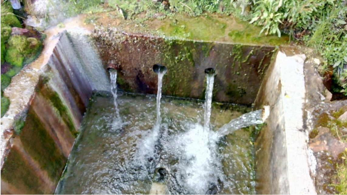
Camara de captacion muestra las entradas de agua provenientes de los puquios.
