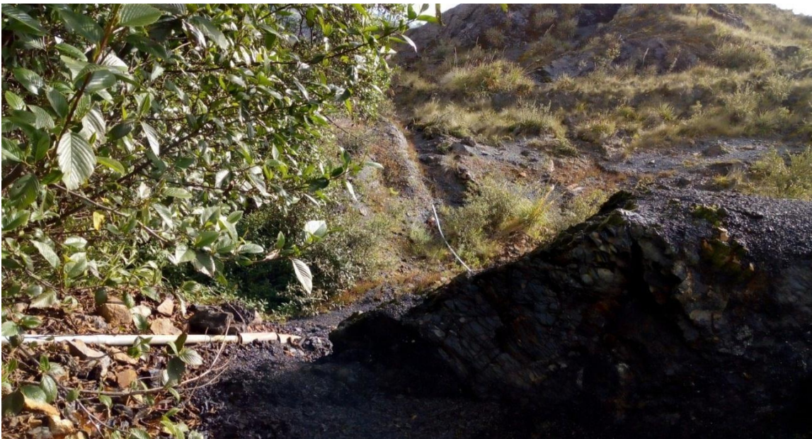
Tuberías expuestas causadas por las constantes lluvias.
