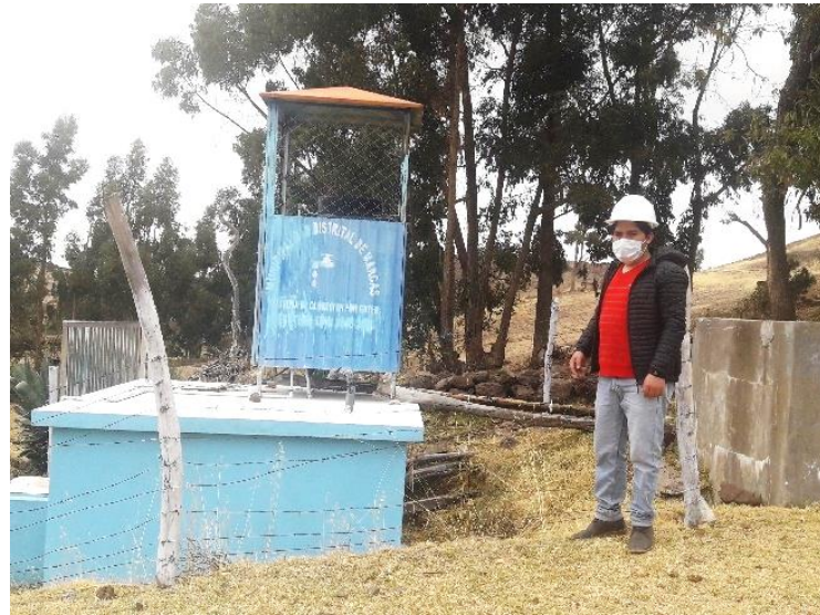
Fotografía 3.1: Reservorio Actual con caseta de clorador
