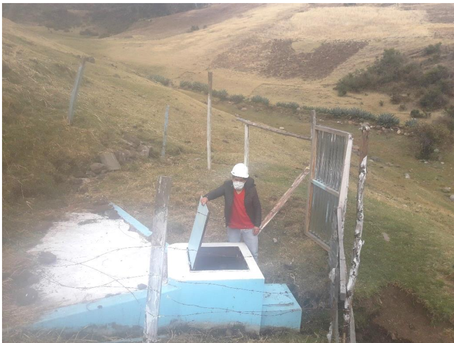
Fotografía 3.2: Tapa sanitaria de la captación Rayampampa
