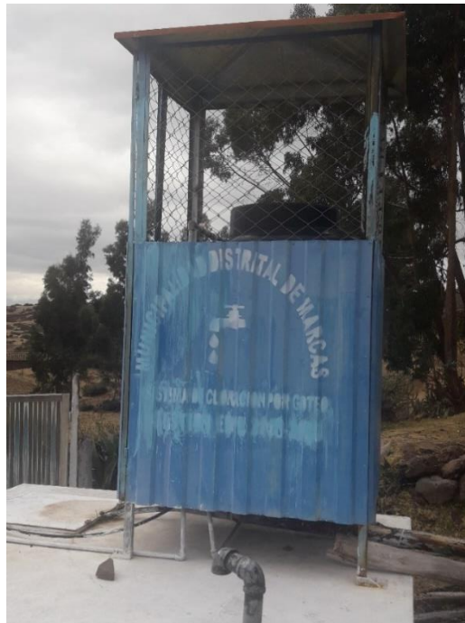
Grafico 37. Caseta de cloración del Reservorio Nuevo
