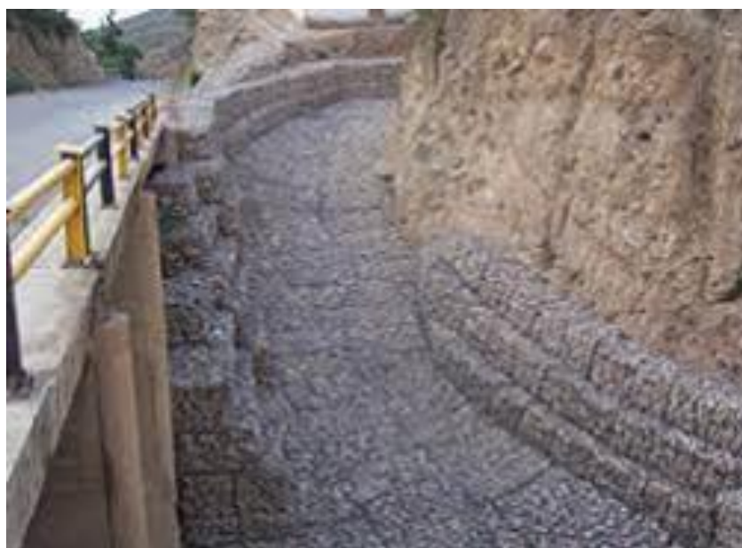
Foto 04: Gaviones para protección de estribos TDM-Perú (2020).
