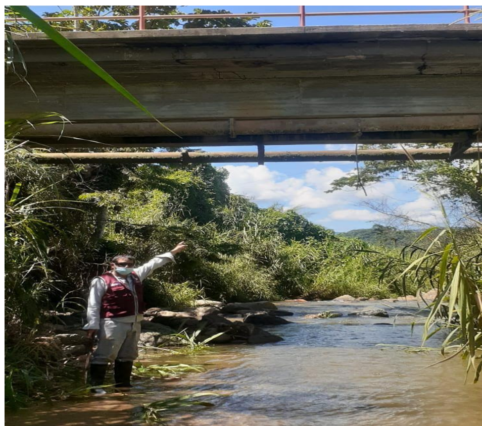
Foto 08: Tubería matriz izquierda de agua bajo el puente Timarini 1
