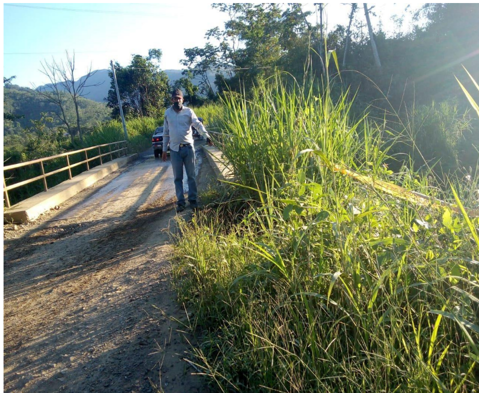
Foto 02: Socavación del estribo de ingreso del puente Timarini 1
