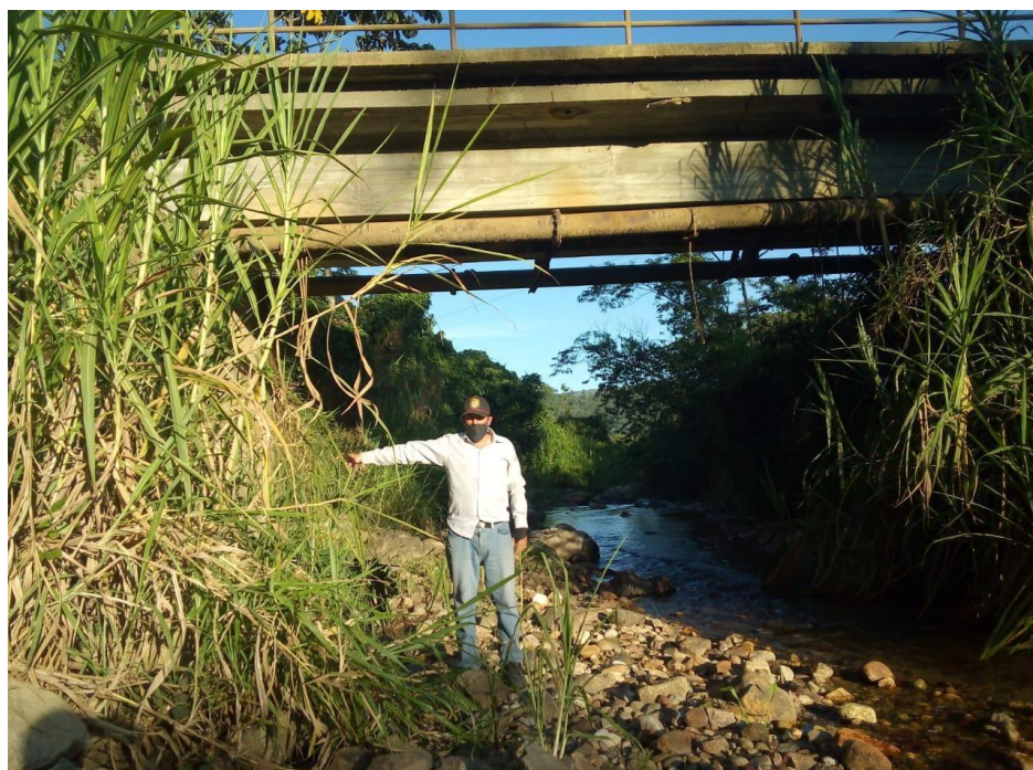
Foto 1: Defensa derrumbada, existe mucha acumulación de maleza
