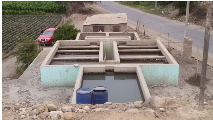
Figura. 9.- Planta de tratamiento de San Juan de Vinzos Nota. Fuente: Propio. (2011)
