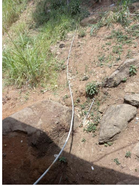
Figura 16: redes de sistema de abastecimiento de a potable en el caserio cajas alumbre
