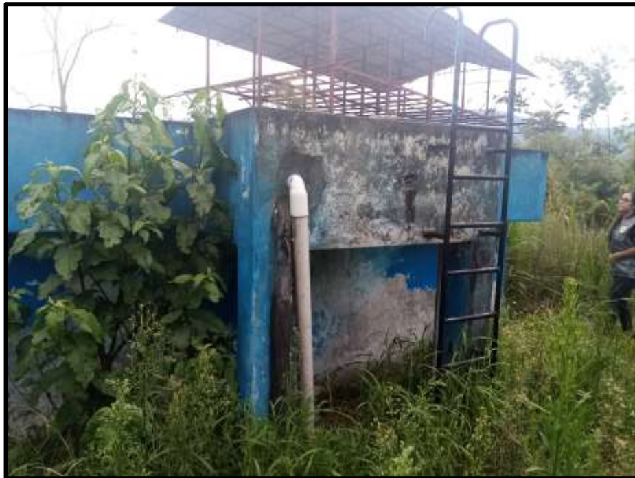
Imagen 2. Se puede observar la patología con la antigüedad del reservorio.
