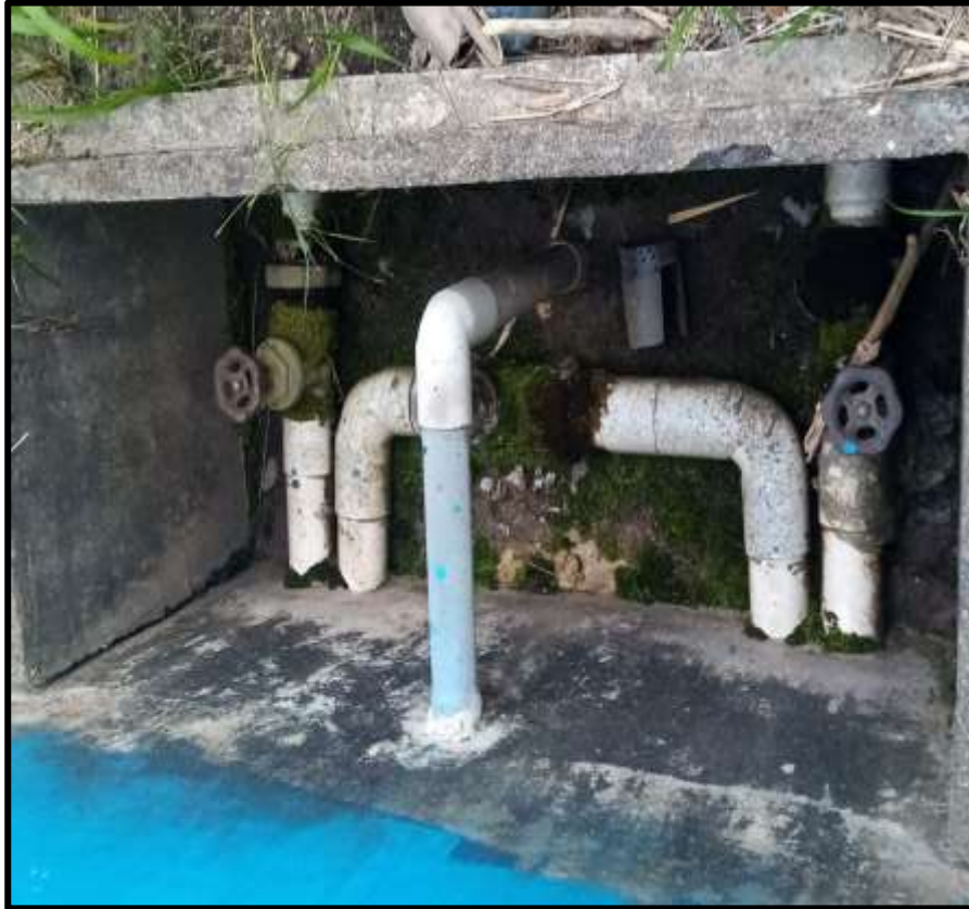
Imagen 3. Se puede observar la caseta de válvulas deterioradas.
