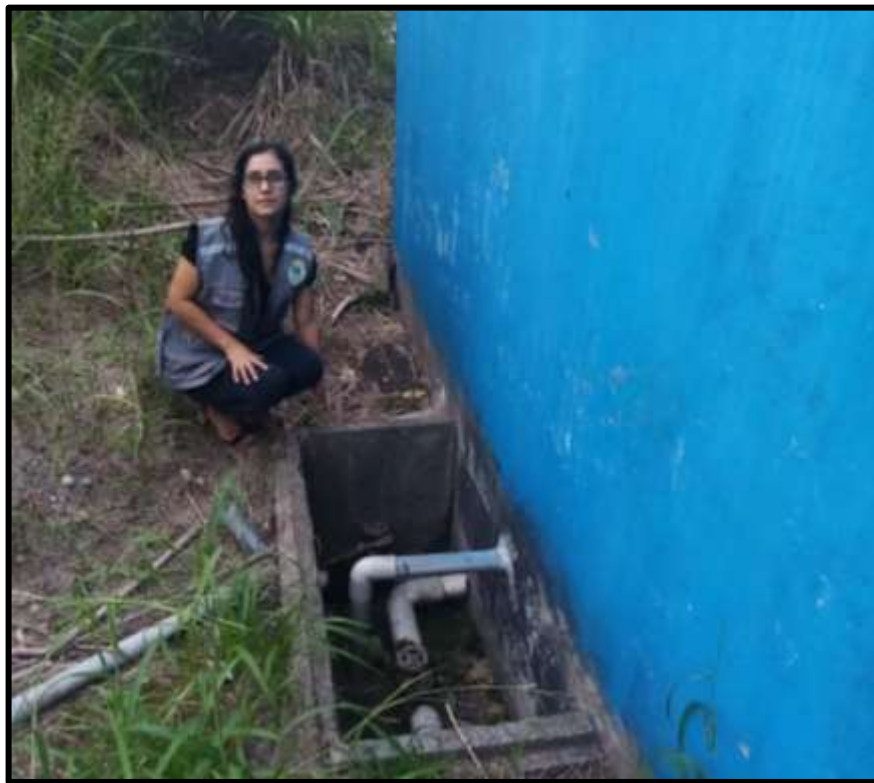
Imagen 4. Se puede observar la caseta de válvulas sin tapa.
