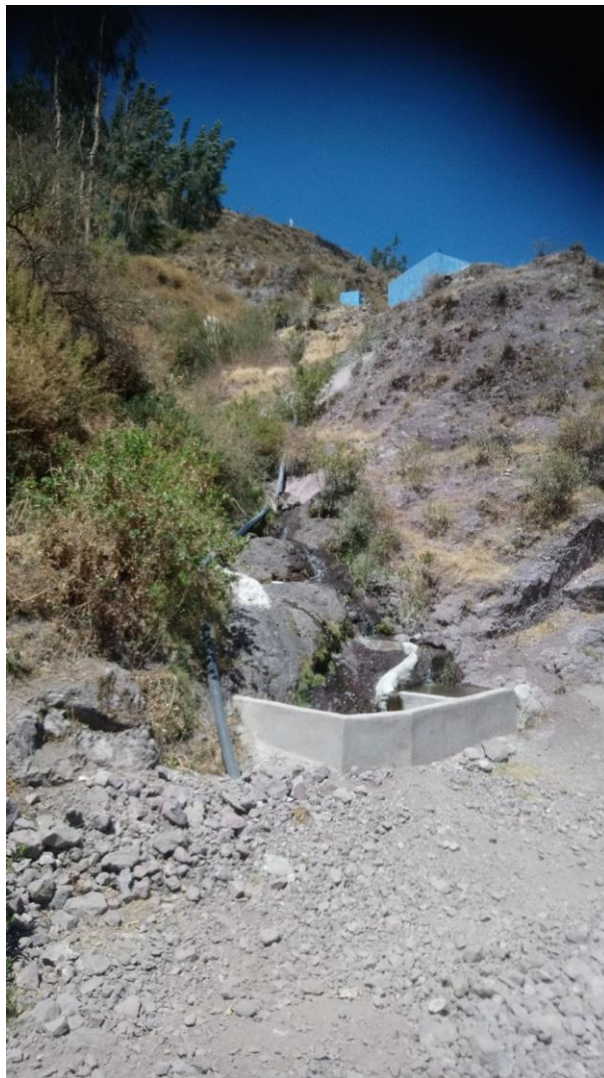
8.- TUBERIA DE LA LINEA DE ADUCCION SOBRE EL TERRENO NATURAL.
