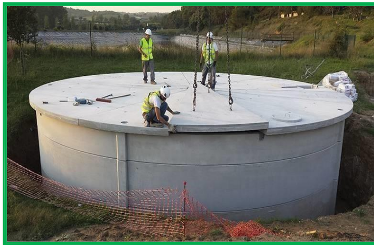
Figura 22a. Fotografía de Reservorio enterrado. Fuente: Fuente: AquaDiposits
