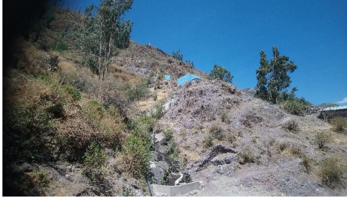
7.- TUBERIA DE LA LINEA DE ADUCCION SOBRE EL TERRENO NATURAL.
