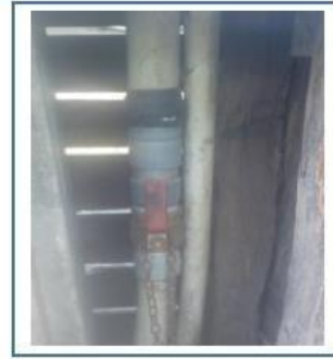
Caja de Válvulas
