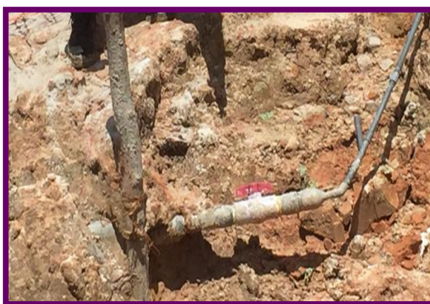
Figura 34: Red de distribución expuesta (tubería secundaria)
