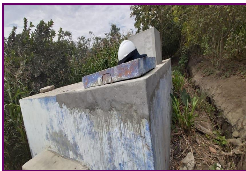
Figura 289: Reservorio sin cerco perimétrico y expuesto
