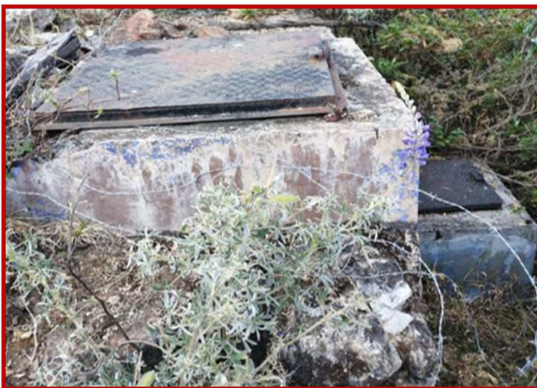
Figura 30: Captación Jaihua (Cámara húmeda y seca deterioradas)
