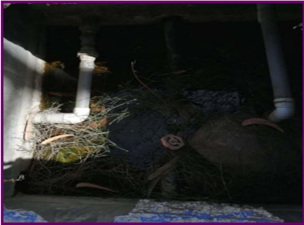
Figura 30: Accesorios de la caseta de válvulas del reservorio
