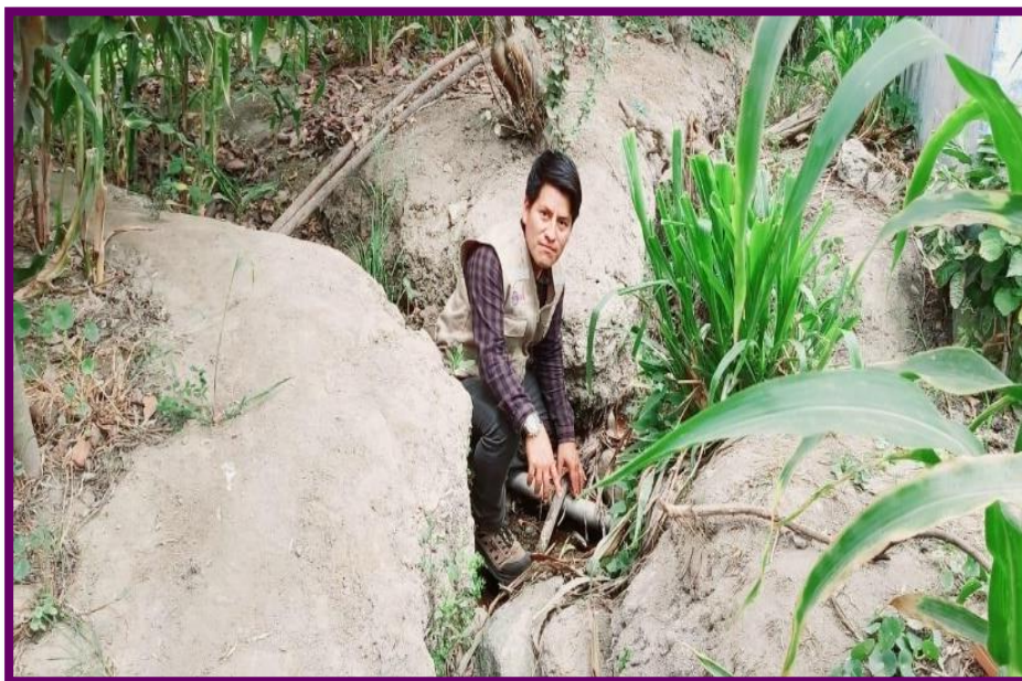
Figura 32: Línea de aducción expuesta a peligros de la zona Fuente: Elaboración propia – 2022.
