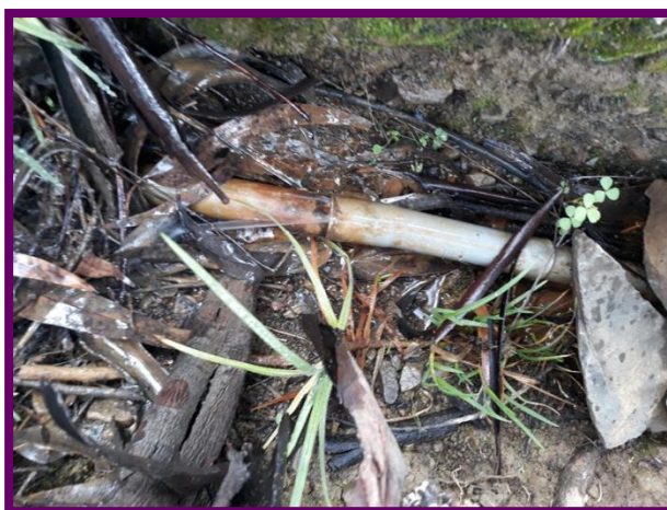
Figura 33: Red de distribución expuesta (tubería principal)
