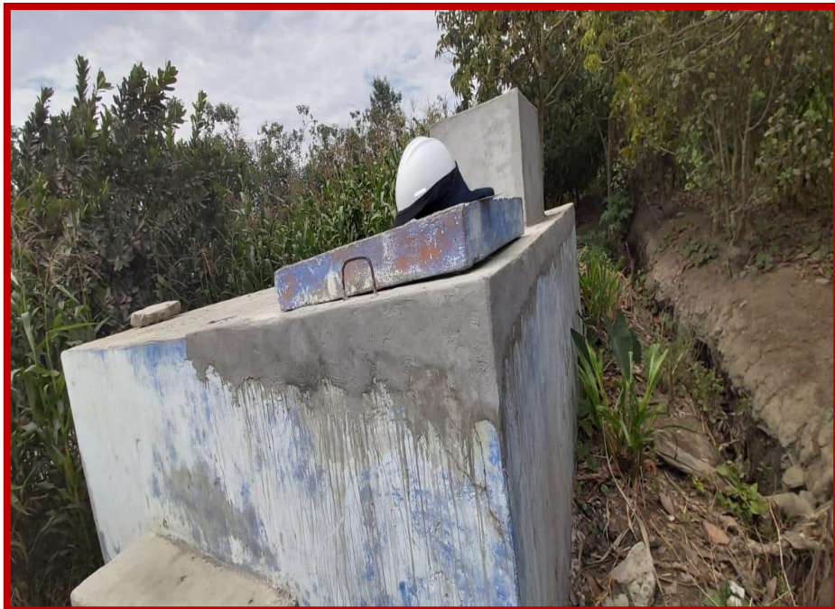
Figura 32: Reservorio de almacenamiento del caserío Jaihua
