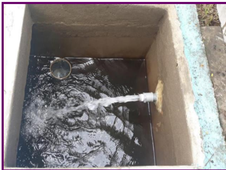
Figura 35: Cámara húmeda de la CRP6 actual
