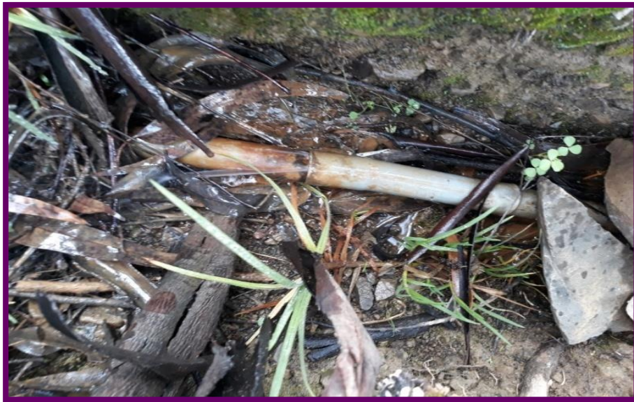
Figura 31. Patologías presentadas en la tubería de la línea de aducción Fuente: Elaboración propia
