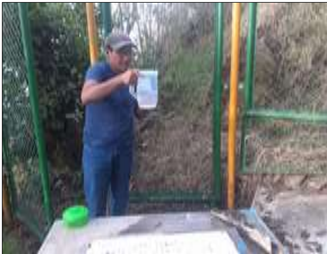
Fotografía 01: Captación del sistema de agua.
