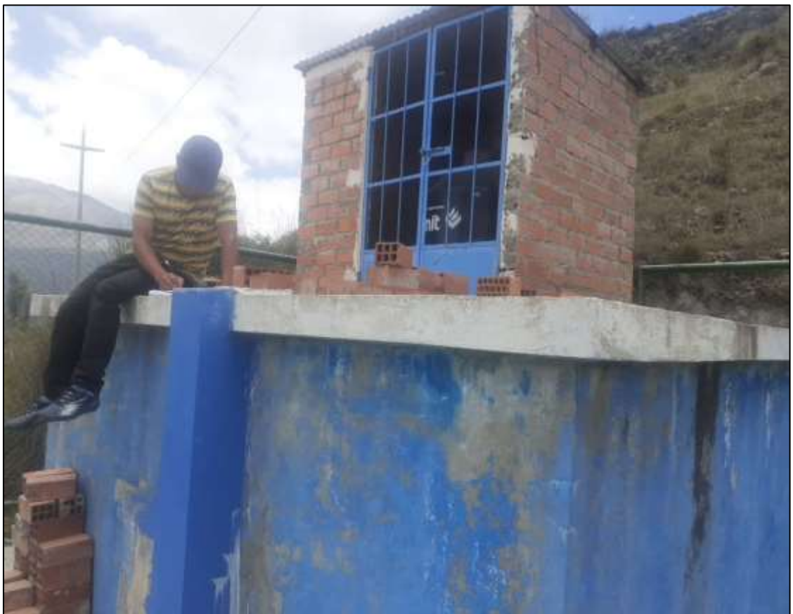
Fotografía 04: Reservorio de 12m3
