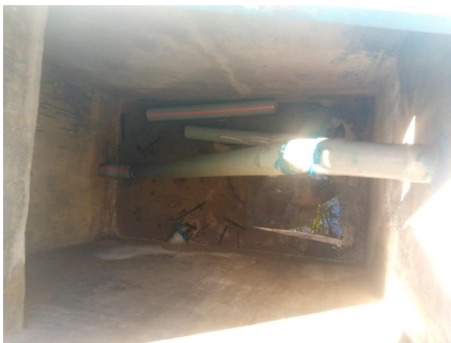
FOTO N°06: se aprecia ver la cámara rompe presión tipo 7 ubicada en la línea de aducción que se encuentra anulada por que la captación no capta suficiente caudal para abastecer al reservorio y eso afecta a la línea de distribución.
