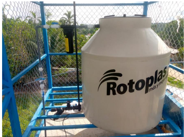
Figura 20: Caseta de Cloración
