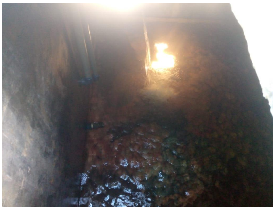
FOTO N°05: se aprecia ver el reservorio de 15m 3 que el nivel del agua alcanza a una altura aproximada de 20cm
