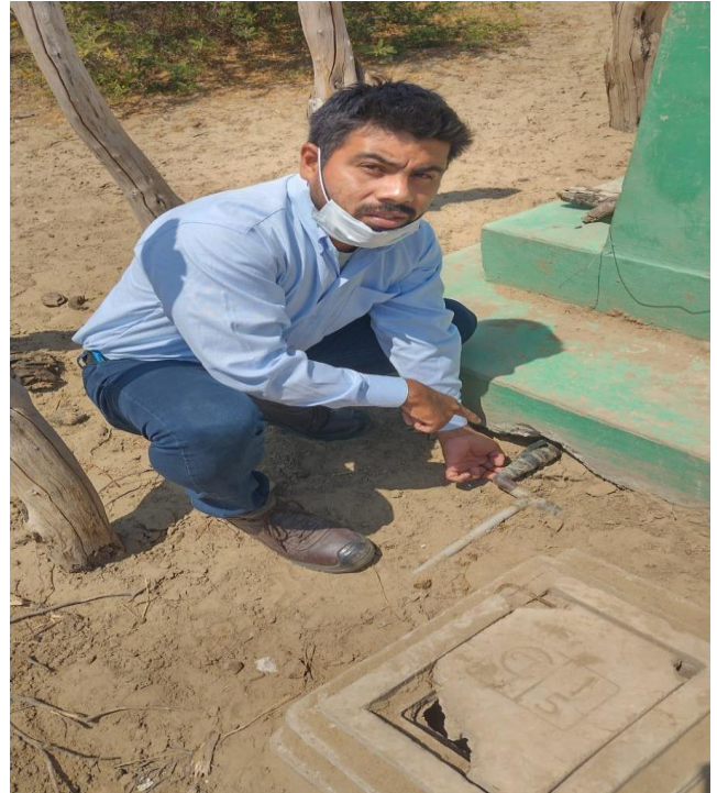
Figura N° 8: Conexiones a la pileta publica en mal estado
