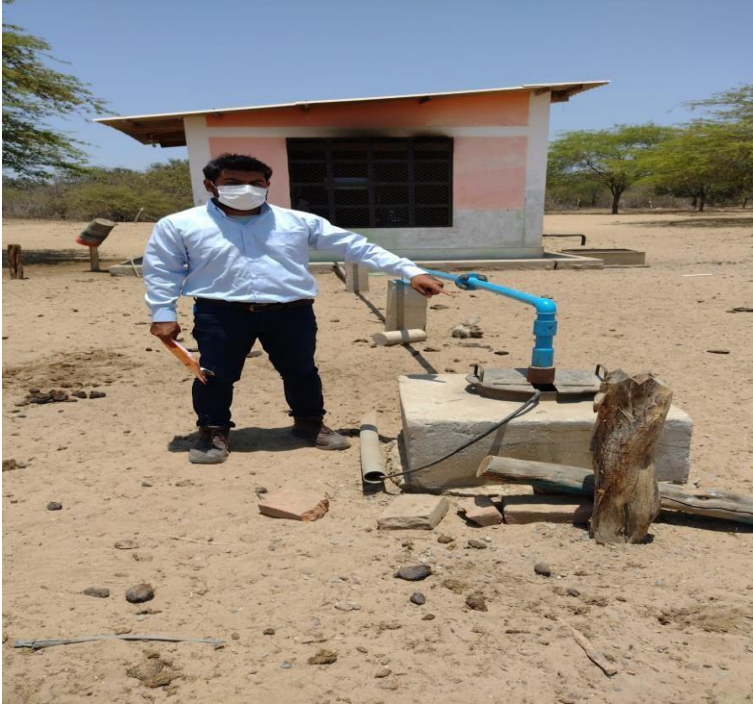
Figura N° 5: Pozo de agua Fuente: Elaboración Propia
