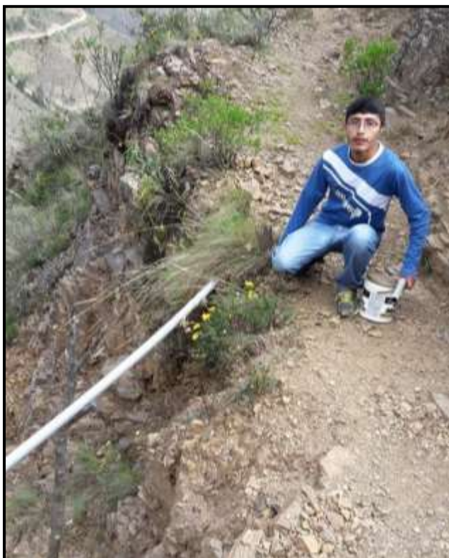
Foto 04: Exposición a la intemperie de un tramo de la línea de conducción del centro poblado de Quillabamba.
