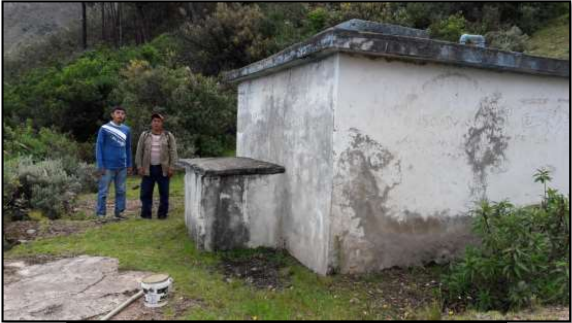
Foto 05: Estado del reservorio de almacenamiento de agua del centro poblado de Quillabamba.
