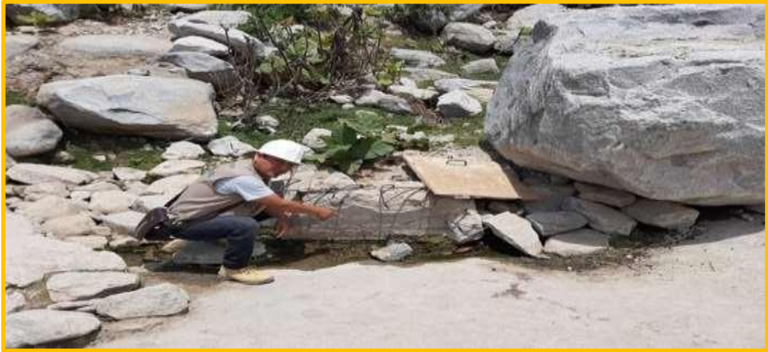
Imagen n°2: Captación de fondo del caserío de Pocso
