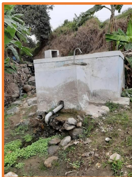
Imagen 8. Inicio del primer tramo de la longitud de tubería de la línea de aducción.
