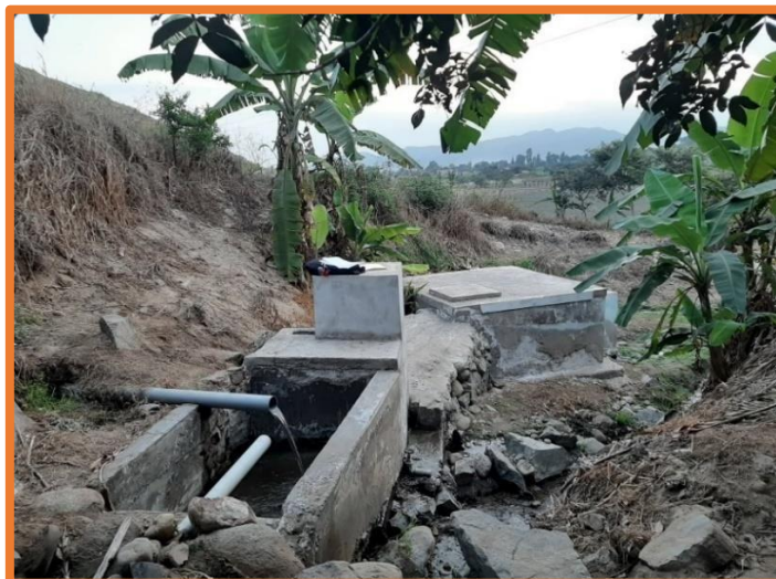
Imagen 4. Vista panorámica de la cámara de captación, línea de conducción y reservorio existente del caserío Kilómetro 24 Pampa de Vinzos.
