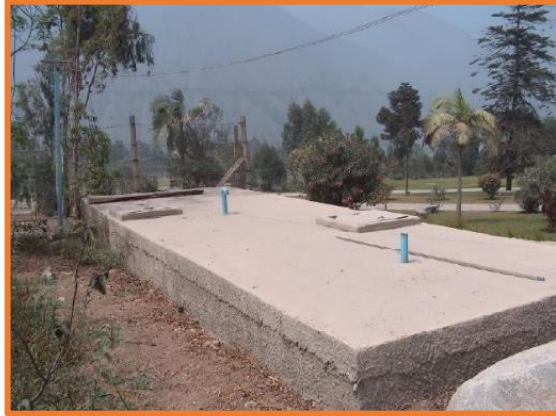
Figura 28. Reservorio rectangular semi - enterrado.
