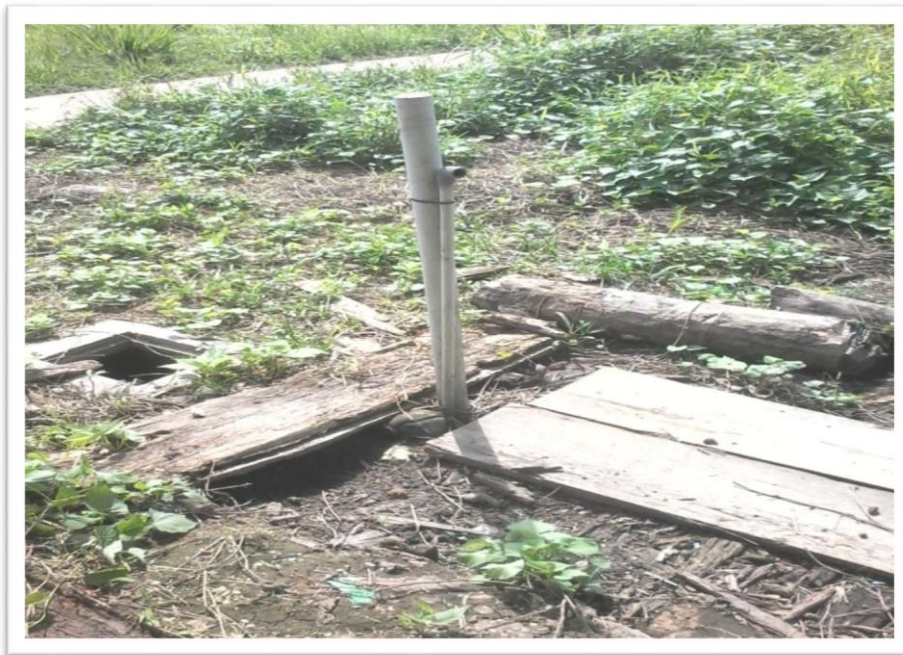
Pileta de agua y caja de registro, falta tapa de seguridad
