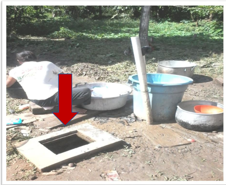
Pileta de agua y caja de registro, falta tapa de seguridad
