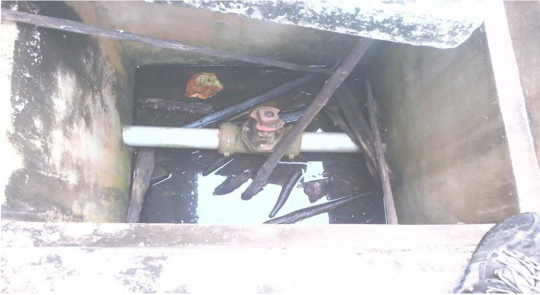
Imagen 1: Se observa en la presente imagen que la válvula es de tipo Mazza de 2" en mal estado y expuesto a la intemperie pudiendo ocasionar accidente y la rotura de la tubería.
