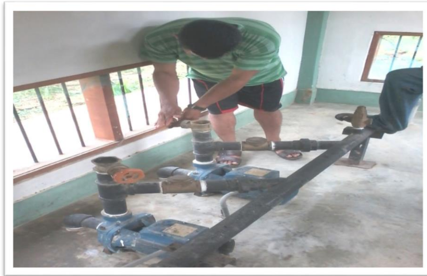
Planta de tratamiento en funcionamiento.
