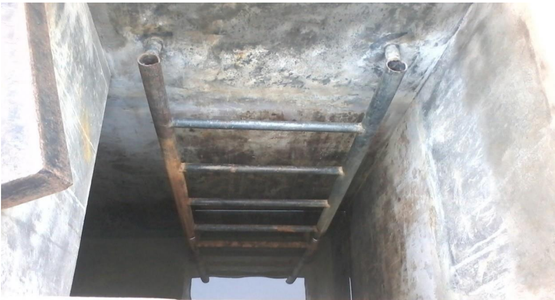
Imagen 2: Podemos observar que la cisterna que recolecta el agua está deteriorado por el pasar de los años y la falta de limpieza. Cuya escalera metálica tipo gato presenta corrosión también por el mismo motivo.
