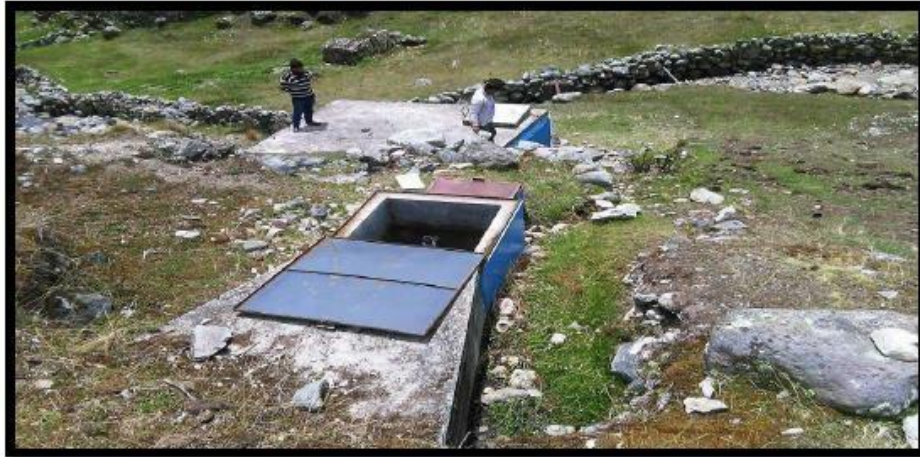
FOTOGRAFIA N° 01 CAPTACION DEL MANANTIAL DE CHUCUHUAIN
