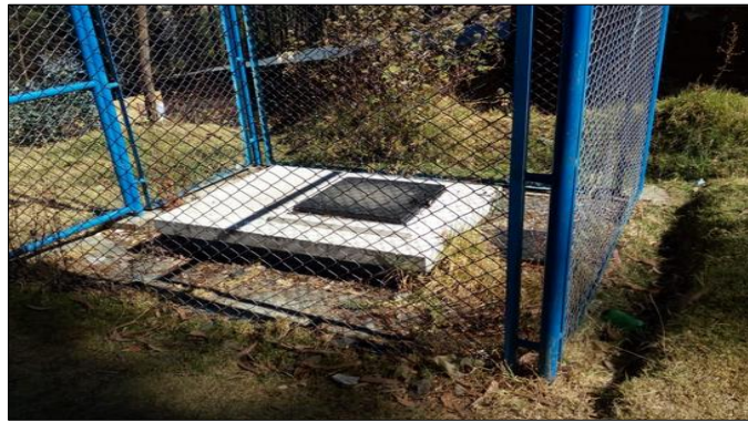
Gráfico 14: Cámara rompe presión Fuente: Elaboración propia (2021)
