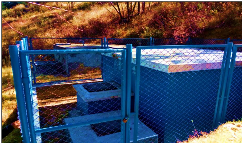
Imagen 02: Cámara de captación del caserío Caururo
