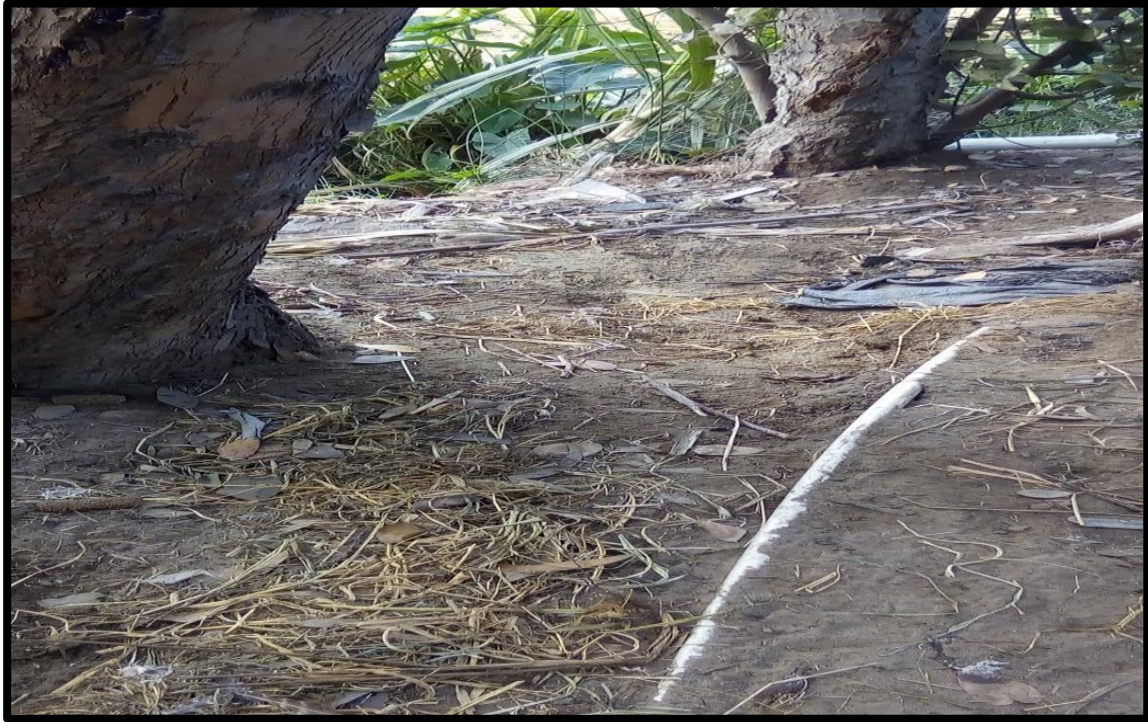
Figura 6. Se muestra el estado en que se encuentra la línea de conducción expuesta cualquier peligro en el Caserío El Milagro, distrito de Independencia, provincia de Huaraz, región Áncash y su incidencia en la condición sanitaria de la población– 2022.
