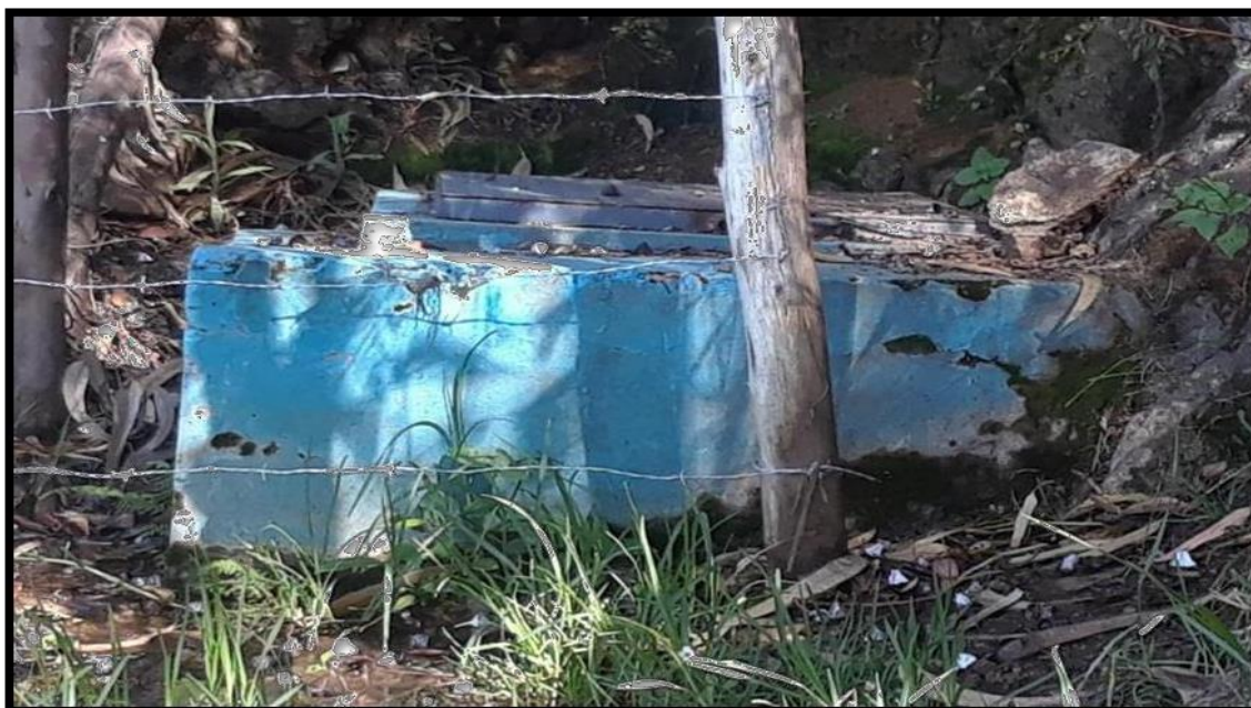
Figura 3. Se muestra el estado en que se encuentra la cámara de captación del Caserío El Milagro, distrito de Independencia, provincia de Huaraz, región Áncash y su incidencia en la condición sanitaria de la población – 2022.
