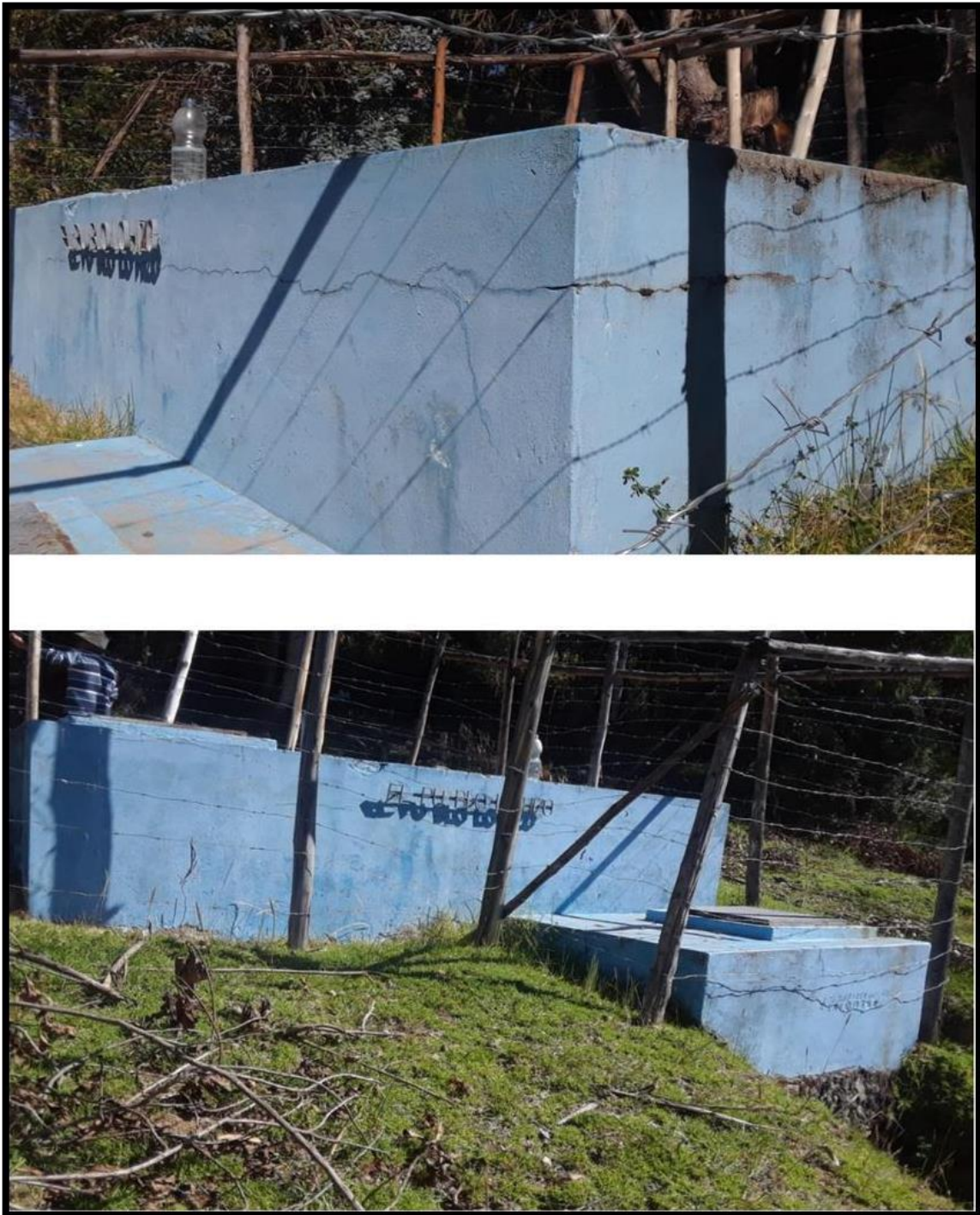
Figura 5. Se muestra el estado en que se encuentra el reservorio y su caseta de válvula de control en el Caserío El Milagro, distrito de Independencia, provincia de Huaraz, región Áncash y su incidencia en la condición sanitaria de la población– 2022.
