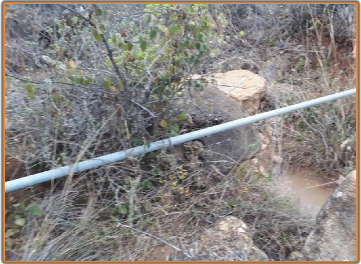
Figura 16: Línea de aducción del caserío de Ichon.
