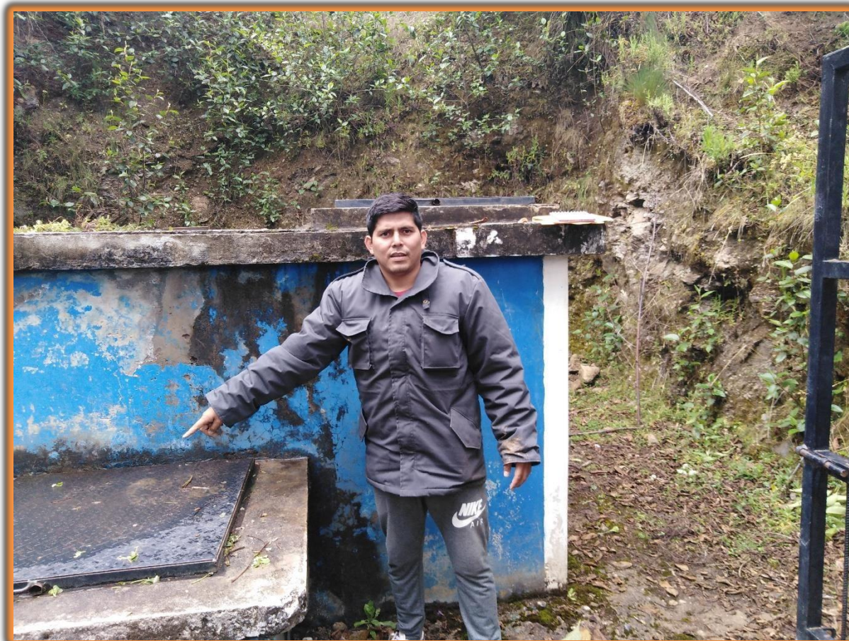
Figura 17: Reservorio de Almacenamiento del caserío de Ichon.
