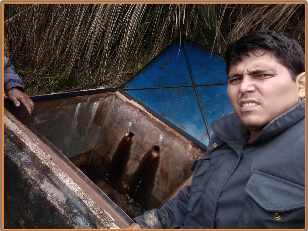
Figura 15: Cámara de captación del caserío de Ichon.
