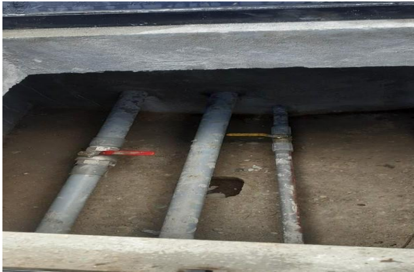
Imagen 04: Accesorios de la caseta de válvulas del reservorio
