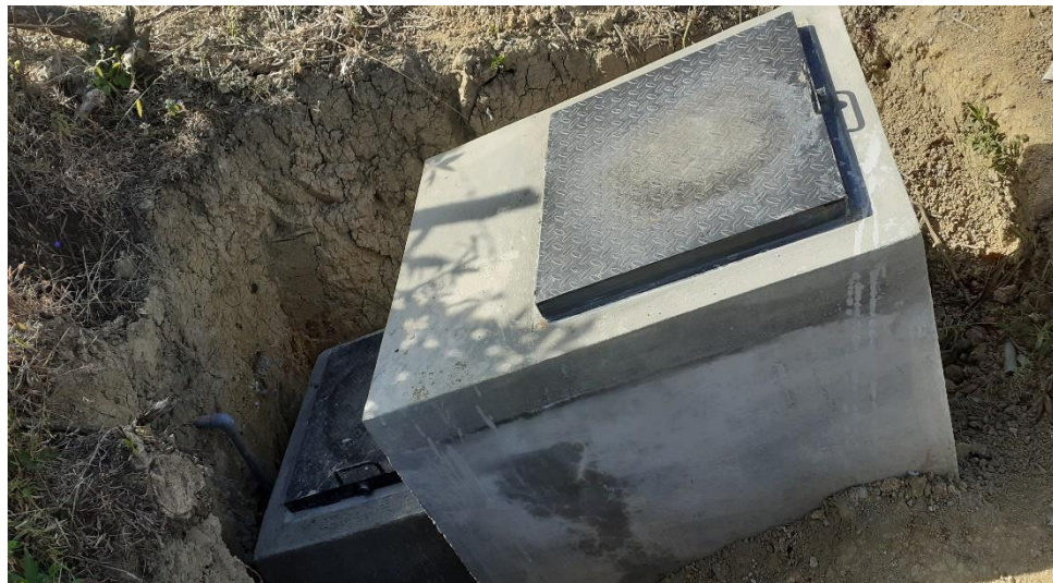
Imagen 08: Cámara rompe presión tipo 6
