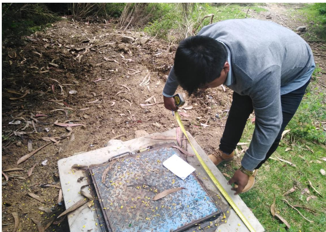
Fotografía 16. Segundo cámara de reunión de caudal (Captación 3 y 4)
