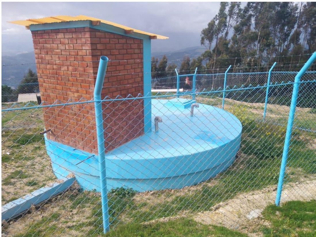
Fotografía 12. Reservorio de agua potable
