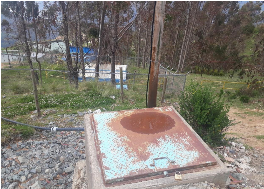
Fotografía 08. Planta de tratamiento de agua potable – PTAP
