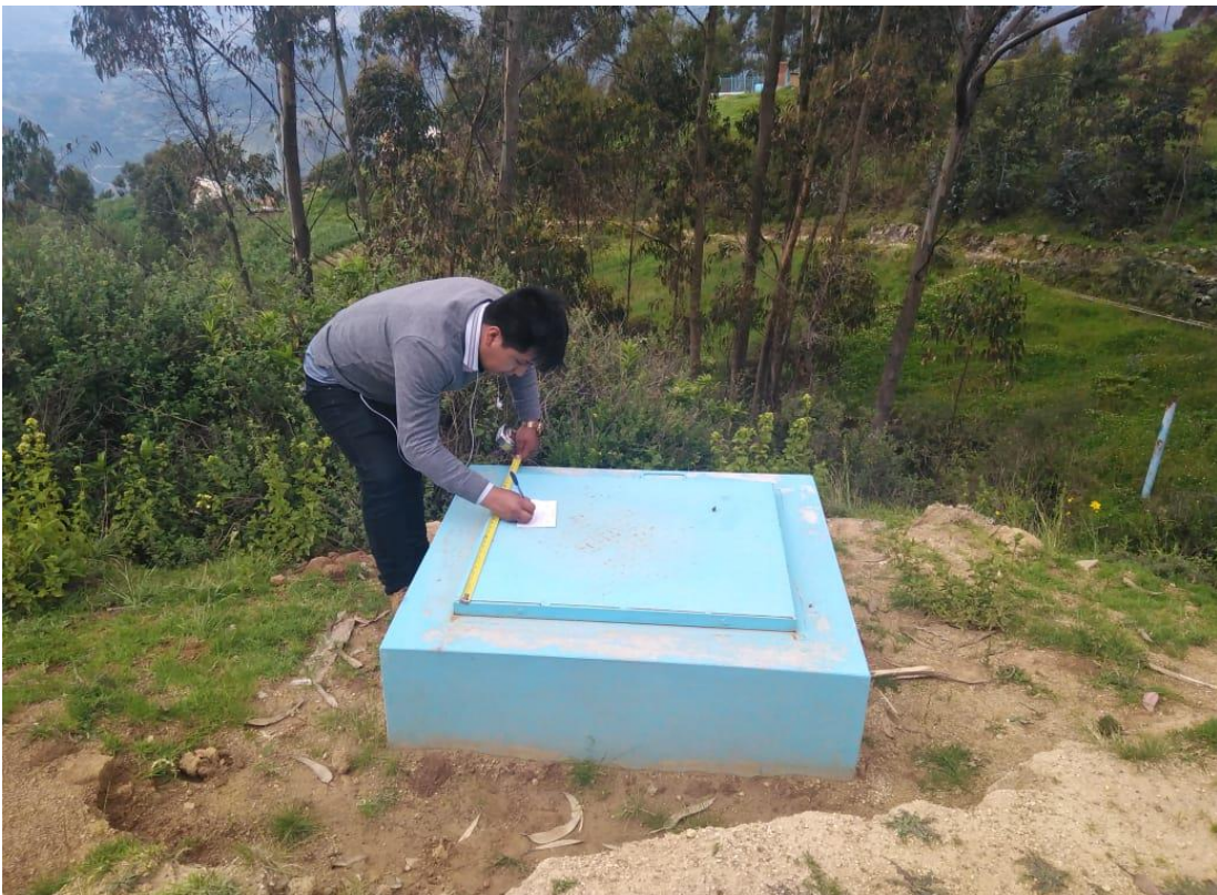
Fotografía 10. Primer cámara de reunión de caudal (captación 1 y 2)
