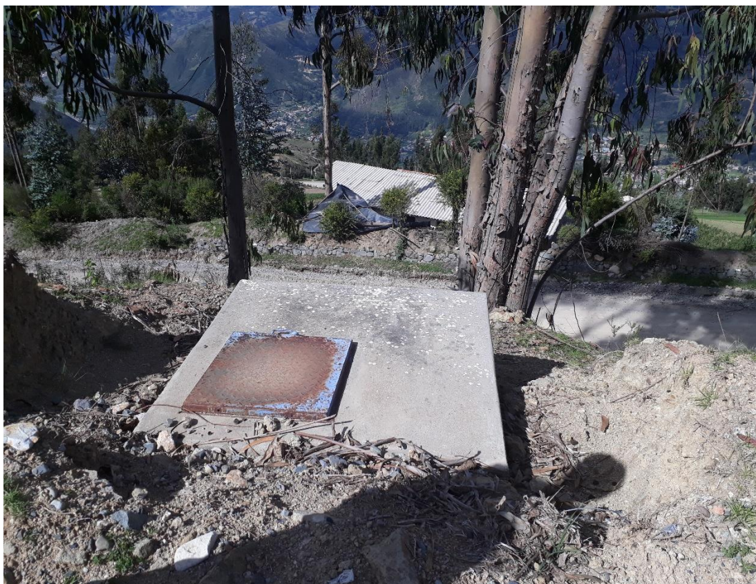
Fotografía 15. Cámara de rompe presión Tipo 7 – CRP 7
