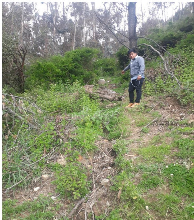
Fotografía 04. Línea de conducción
