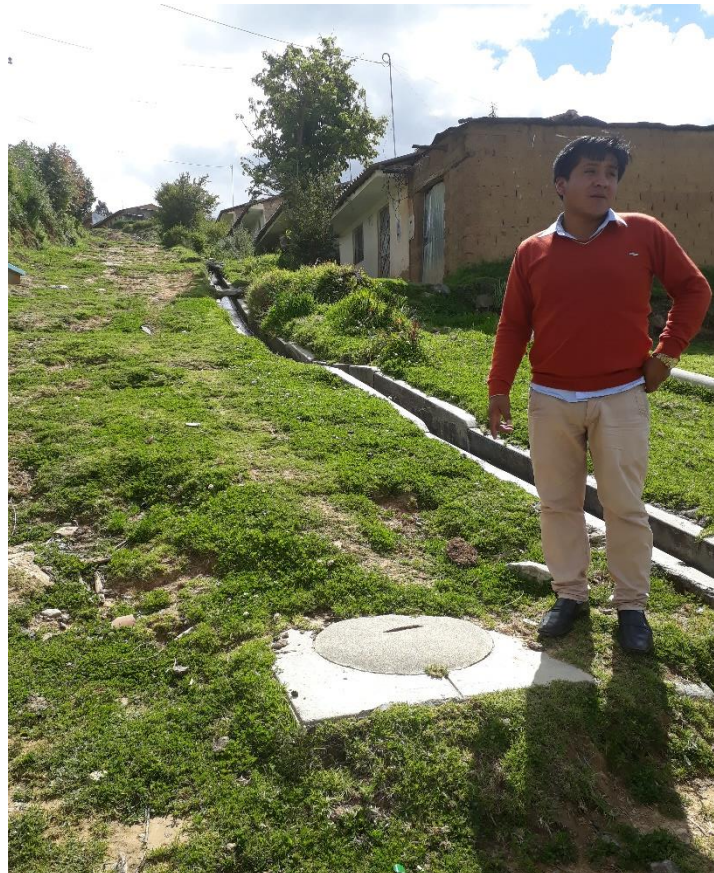
Fotografía 22. Buzón y red principal de desague
