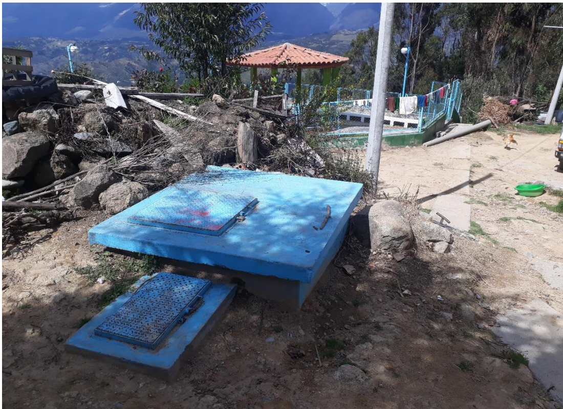
Fotografía 18. Cámara rompe presión Tipo 7 – CRP 7
