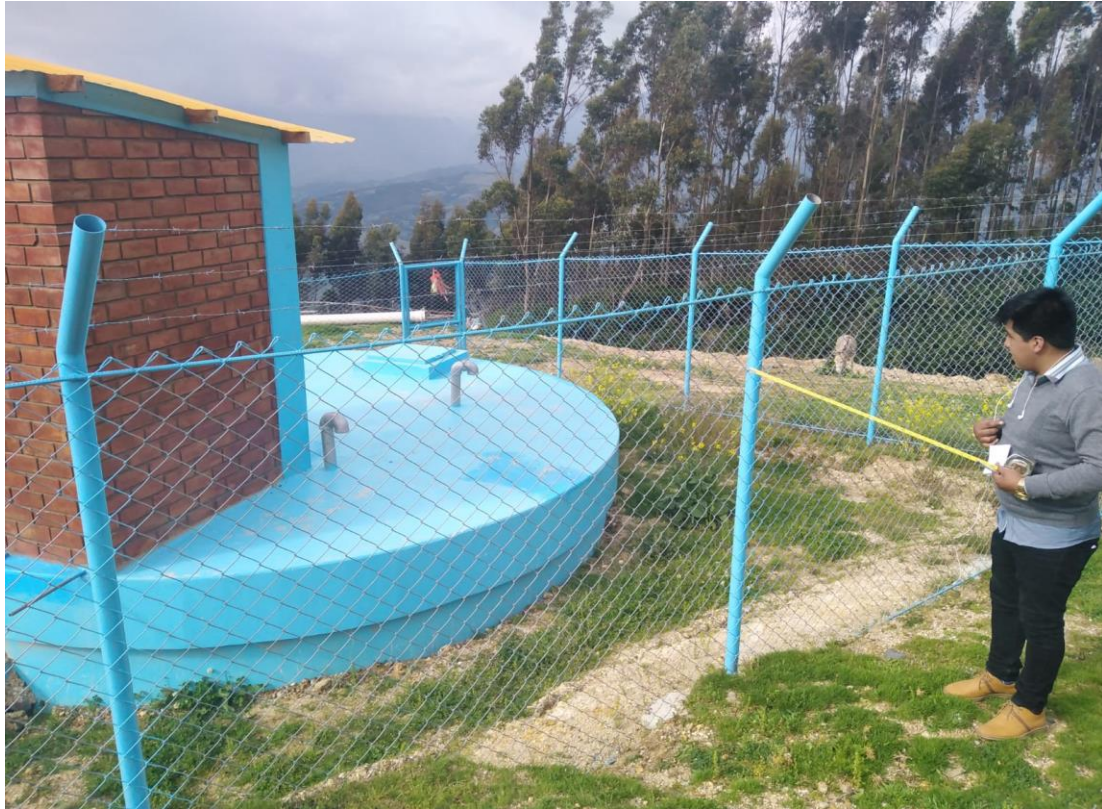
Fotografía 11. Diagnóstico del reservorio
